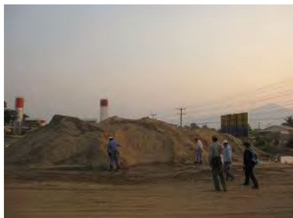
Pakse のコンクリート製造工場
