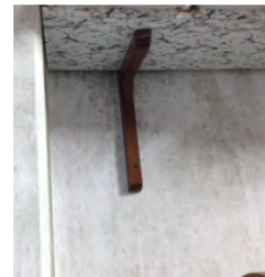
写真 2-12 前室廊下の壁面のカビ
