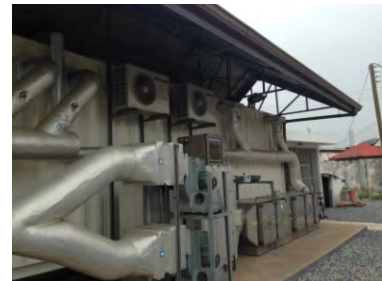
写真 2-35 外部設備状況
