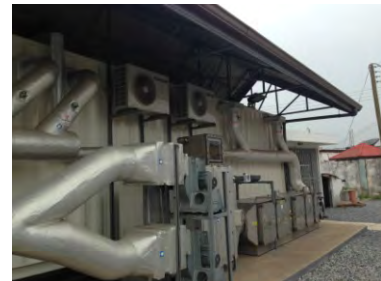
写真 2-35 外部設備状況
