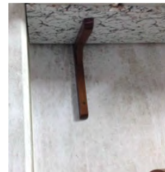
写真 2-12 前室廊下の壁面のカビ
