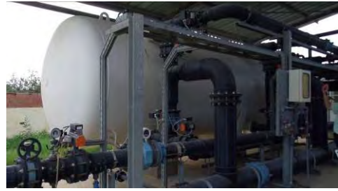
Photo 2 Filtre de sable
