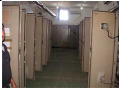
Photo 29 Tableau de contrôle électrique
