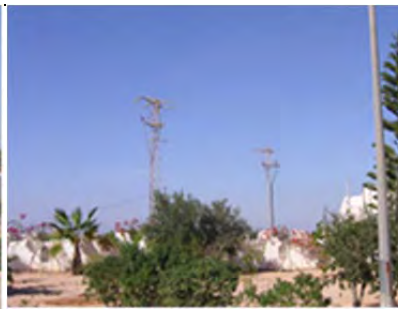
Photo 15 Tour d'alimentation de la STEG
