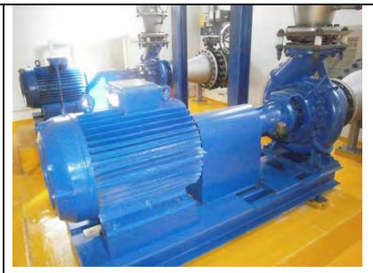
Photo 5 Pompe à contre courant
