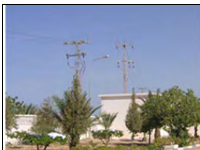
Photo 6 Tour d'alimentation de la STEG
