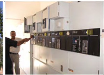
Photo 16 Tableaux de contrôle dans la salle électrique
