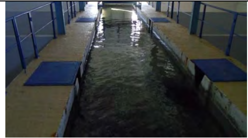
Photo 2 Bassin de filtration
