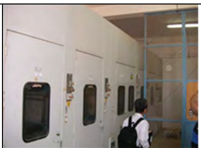
Photo 8 Tableaux de contrôle à l'intérieur du local électrique
