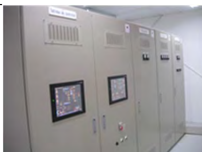
Photo 40 Tableau de contrôle
