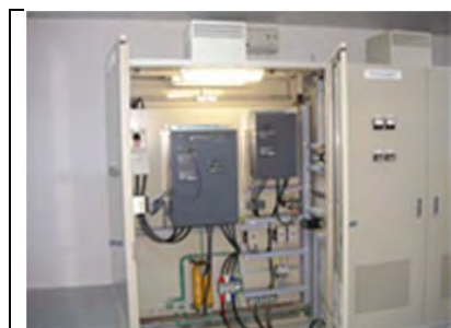
Photo 39 Tableau de contrôle
