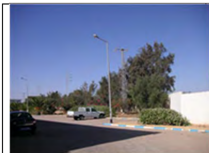
Photo 26 Tour d'alimentation de la STEG
