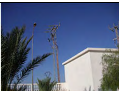
Photo 7 Tour d'alimentation de la STEG
