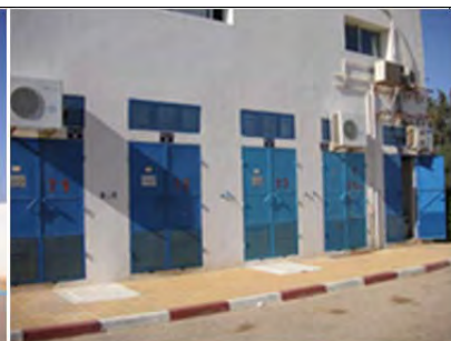
Photo 27 Tour d'alimentation de la STEG
