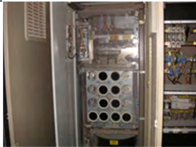
Photo 30 Tableau de contrôle électrique
