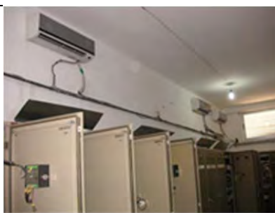
Photo 18 Salle électrique basse tension
