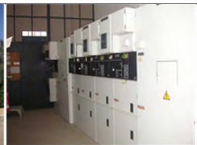
Photo 28 Tableaux de contrôle dans la salle électrique
