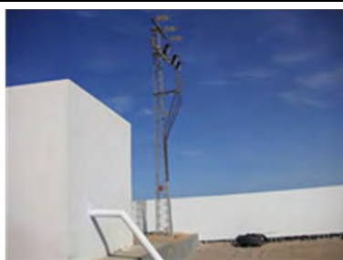
Photo 36 Tour d'alimentation de la STEG
