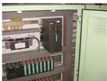
写真 20 監視室操作盤
