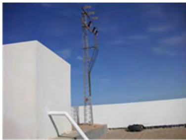
写真 36 受電 STEG 鉄塔
