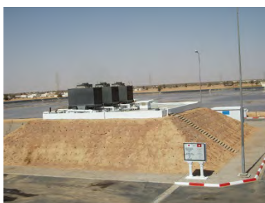
写真 33 クーリングタワー
