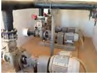
写真 35 ろ過水ポンプと逆洗ポンプ
