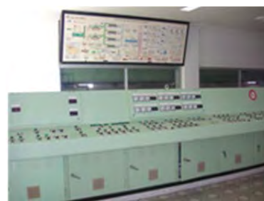
写真 31 監視室操作盤
