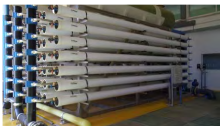
写真 12 RO ユニット
