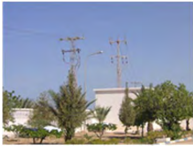
写真 6 受電 STEG 鉄塔
