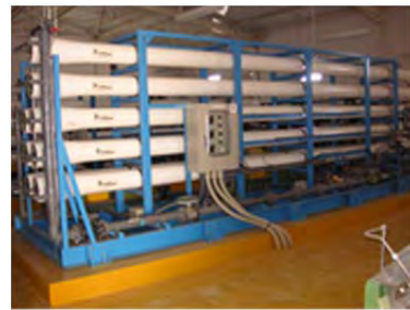
写真 38 RO 膜処理設備
