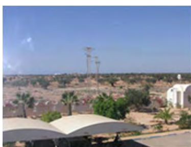
写真 14 受電STEG 鉄塔
