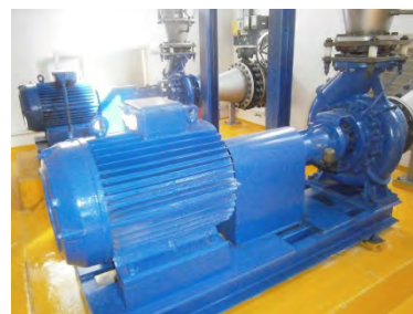
写真 5 逆洗用ポンプ
