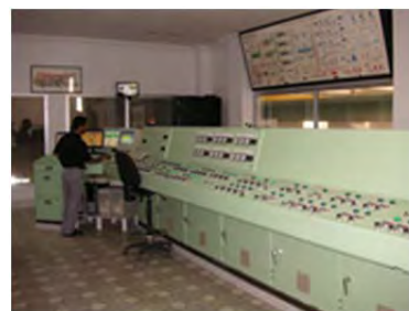
写真 19 監視室操作盤
