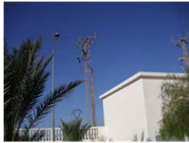
写真 7 受電 STEG 鉄塔
