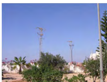
写真 15 受電STEG 鉄塔
