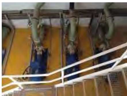
写真 23 場内送水ポンプ
