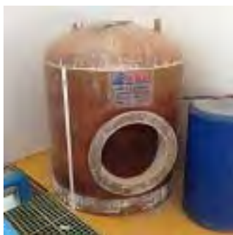
写真 24 FRP 製タンク
