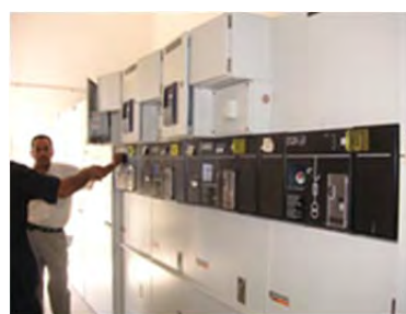
写真 16 電気室配電盤
