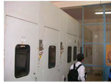
写真 8 受電室配電盤
