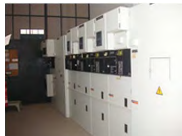
写真 28 受電室配電盤
