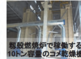
乾燥機の熱源となる 籾殻燃焼炉
