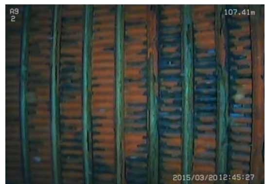
井戸スクリーン（改修後）
