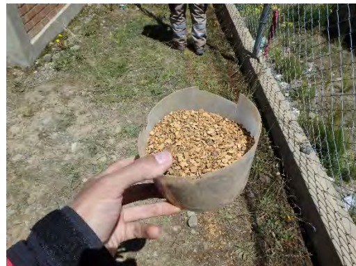
井戸改修によって除去されたスケール
