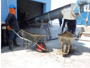
脱水機から取り出して運搬する様子
