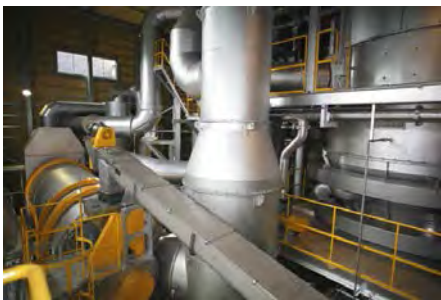
当社工場の乾燥設備
