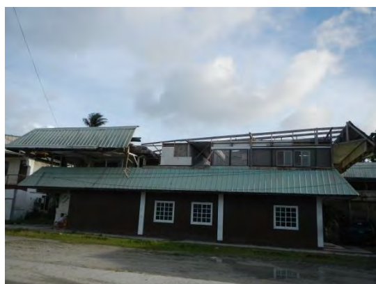
2階部分が倒壊した建物
