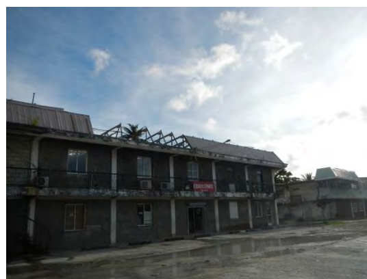
屋根が吹き飛ばされた建物
