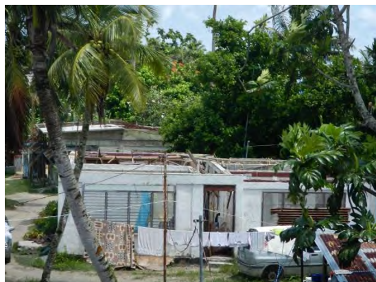
屋根が吹き飛ばされた家屋
