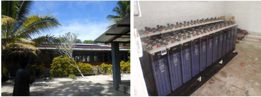
図 3.20 モートロック諸島の Satowan 島において稼働している太陽光発電システム
