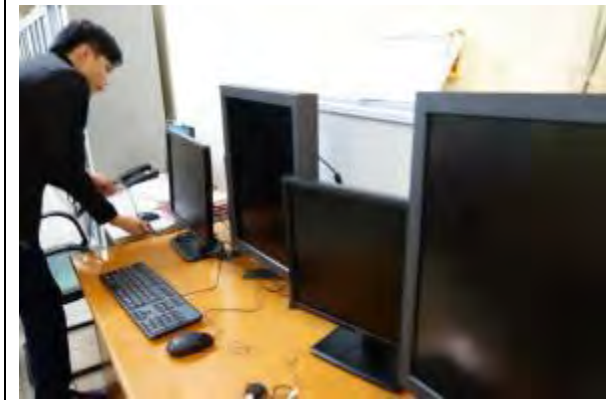
導入製品機材（コンピューター）設置時の様子 （バックマイ病院放射線科、2014年2月）
