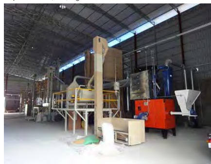
建屋の入り口から見た乾燥機ライン
