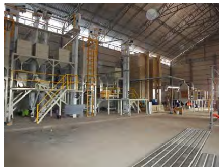
プラント正面から見た右手乾燥・籾摺ライン
