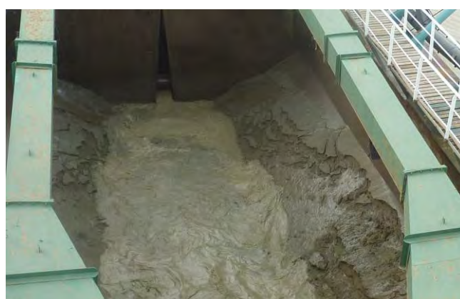
図 3.4-6 船底に付着した泥砂(ポンプ回転数 1,250R/M)
