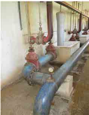
Mai Nefhi浄水場 アカズール型ろ過池 下部 各バルブの開閉が十分機能しない。
