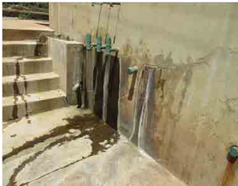
S.V浄水場 漏水 着水井脇で漏水。
