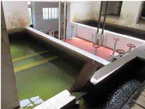
S.V浄水場 ろ過池 逆洗等のバルブ操作
