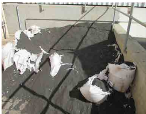
Toker浄水場 ろ過池 使用しているろ過砂。
