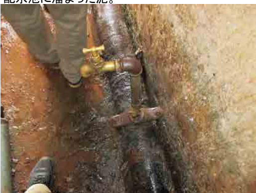
Tsetserat配水池 配管からの漏水。
