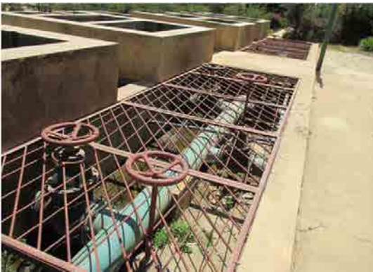
S.V浄水場 流入口
