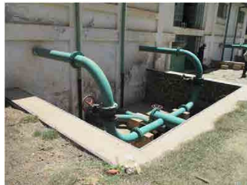
S.V浄水場 沈殿池と調整池の配管
