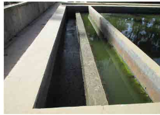
S.V浄水場 フロック形成池と沈殿池の水路
