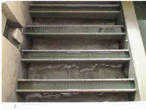
S.V浄水場 ろ過池 ろ床表面に泥が堆積している。
