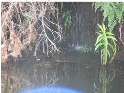
S.Vダム 左岸と堤体継ぎ目から漏水 約0.1ℓ/秒の漏水。
