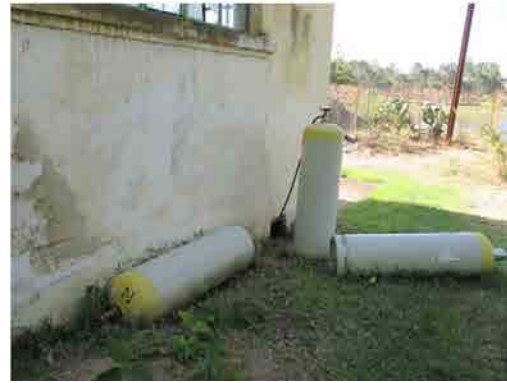
S.V浄水場 塩素ガス注入 地下浄水池に直接注入。
