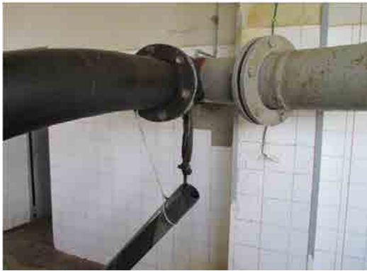
S.V浄水場 送水ポンプ 送水管からの漏水。
