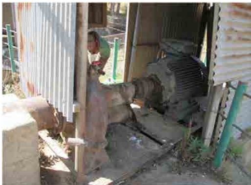
S.Vダム 取水ポンプ 堤体上に設置して使用中。
