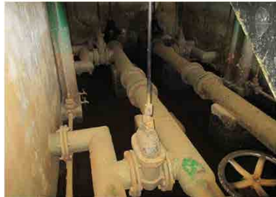
S.V浄水場 ろ過池 逆洗等のバルブ操作の下側
