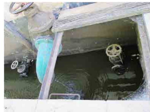
S.V浄水場 調整池の排泥バルブ等
