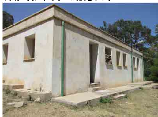
S.V浄水場 旧薬液製造施設と薬品貯蔵
