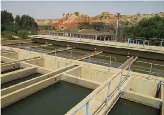
Mai Nefhi浄水場 アカズール型ろ過池
