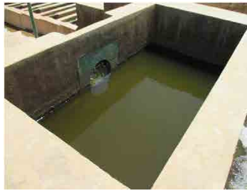
S.V浄水場 着水井
