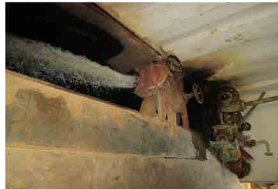
S.V浄水場 ろ過逆洗の排泥バルブ
