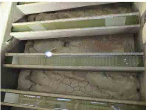
S.V浄水場 ろ過池 ろ床表面に穴が開いている。
