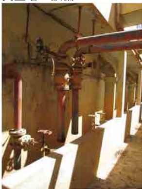
Mai Nefhi浄水場 パルセーター型凝集沈殿池とろ過池 各バルブの開閉が十分機能しない。
