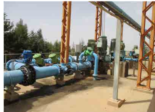
Toker浄水場 浄水池上 送水ポンプと逆洗ポンプ
