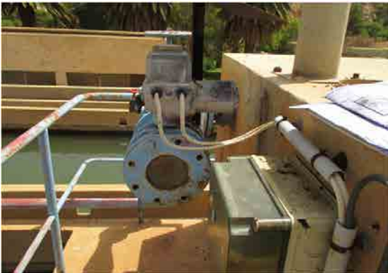
Mai Nefhi浄水場 パルセーター型凝集沈殿池 真空破壊弁の故障
