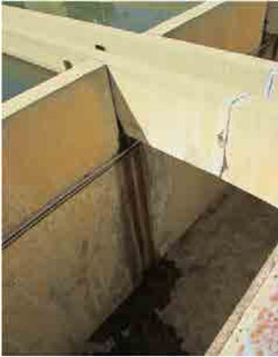
Mai Nefhi浄水場 連絡水路 バルセーター沈殿池とろ過池の連絡水路で漏水。
