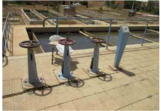
Mai Nefhi浄水場 アカズール型ろ過池 損失水頭計の故障。
