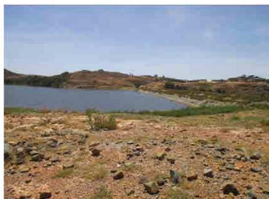
Adi Shekaダム 堤体の上流側のり面 表面ロックでのり面を保護している。
