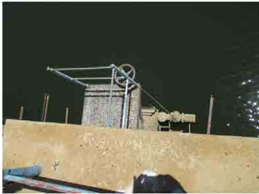
Mai Serwaダム 取水管 取水管のバルブ故障で使用されていない。
