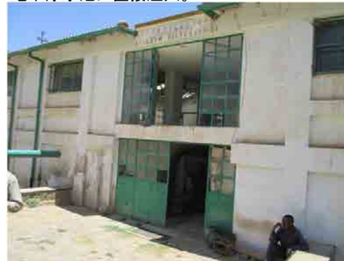
S.V浄水場 ろ過池と浄水池の建屋 老朽化する建屋。
