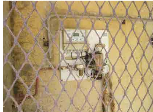
New Sembelポンプ場 故障した塩素ガス注入器。
