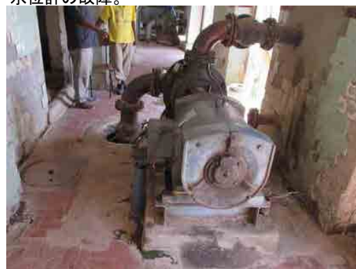
Godaifポンプ場 老朽化したポンプ。
