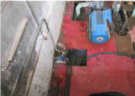
Mai Nefhi浄水場 送水ポンプ等で漏水し小型ポンプで排出。
