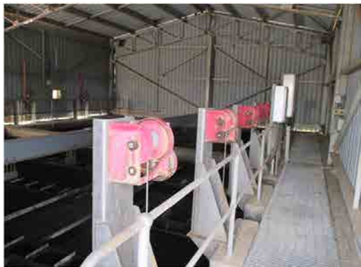
Toker浄水場 傾斜板型沈殿池
