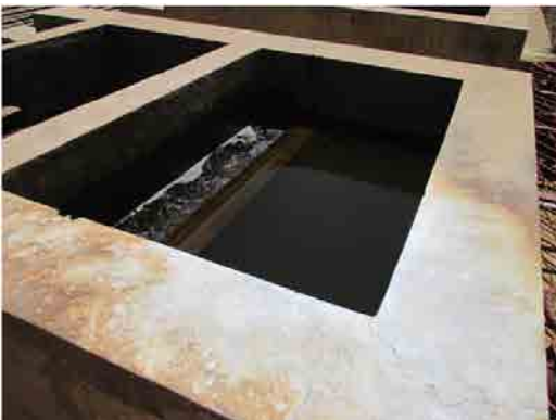
S.V浄水場 着水井
