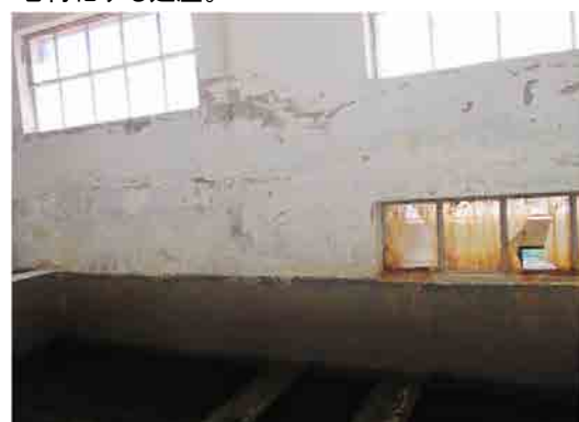
S.V浄水場 ろ過池と浄水池の建屋 建物の亀裂と剥離が目立つ。
