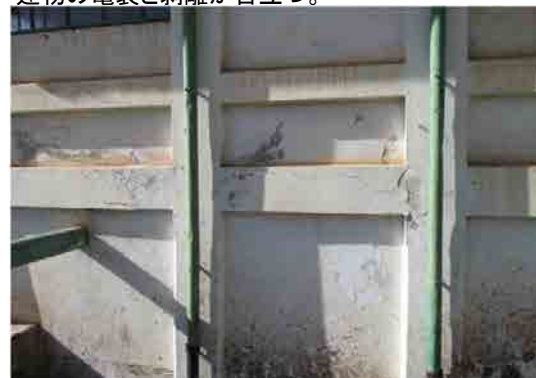
S.V浄水場 ろ過池と浄水池の建屋 建物の亀裂と剥離が目立つ。
