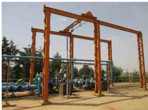
Toker浄水場 浄水池上 送水ポンプと逆洗ポンプ
