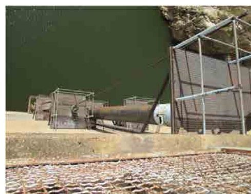
Mai Nefhiダム 取水管
