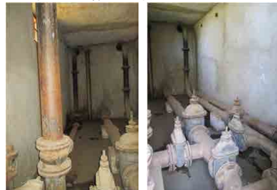
S.V浄水場 逆洗タンク下部のバルブ
