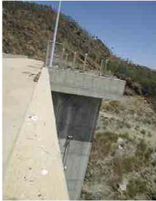
Tokerダム 堤体一体型取水塔
