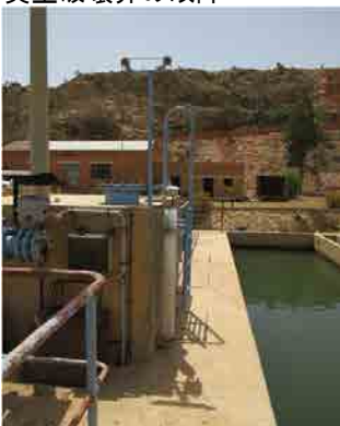
Mai Nefhi浄水場 パルセーター型凝集沈殿池 真空塔の設備
