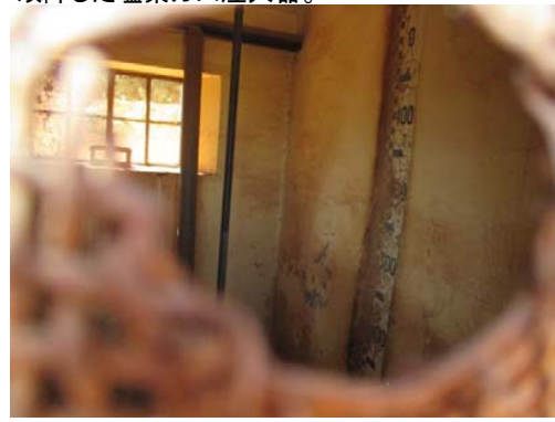
Hazhaz配水池 水位計の故障。
