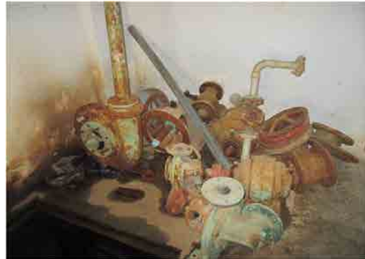
S.V浄水場 散乱する故障資材。
