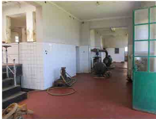
S.V浄水場 送水ポンプ
