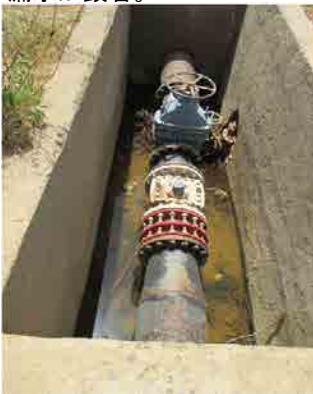
Mai Nefhi浄水場 送水管 メータの故障。
