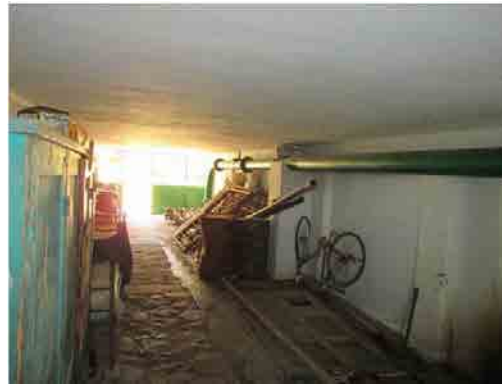
S.V浄水場 送水管
