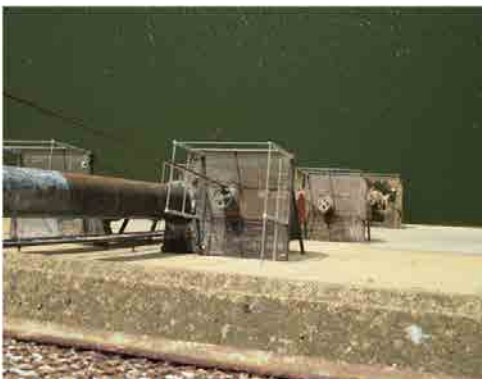
Mai Nefhiダム 取水管
