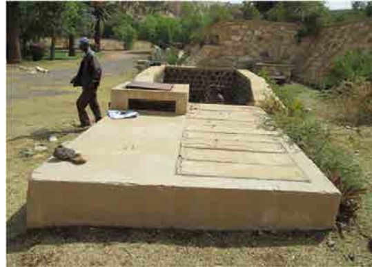
Mai Nefhi浄水場 流入口
