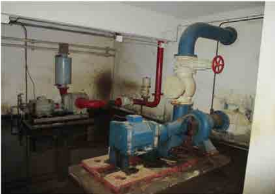
Mai Nefhi浄水場 逆洗ポンプとエアブローポンプ
