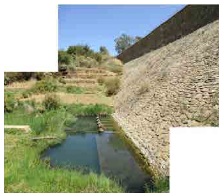
Mai Serwaダム 堤体下流側 5つの排泥弁の内4つは泥詰りのため使用不可。 現在、排泥管から取水している。
