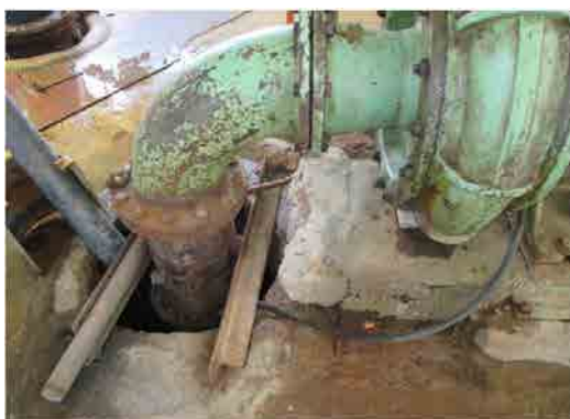
S.V浄水場 送水ポンプ 地下浄水池からの取水口。
