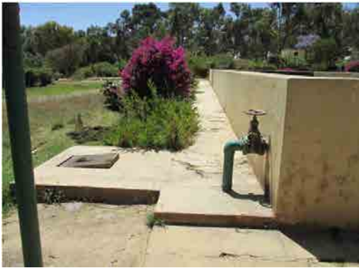
S.V浄水場 沈殿池 排泥弁 5つの沈殿池の排泥弁が稼働しない。
