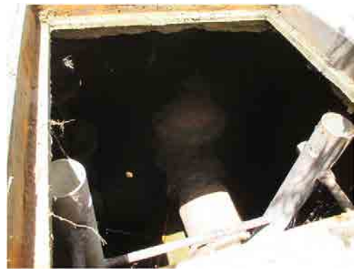
Mai Serwaダム 取水管バルブ 堤体下流側
