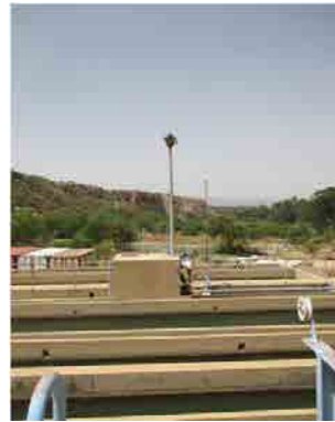
Mai Nefhi浄水場 パルセーター型凝集沈殿池 真空塔の設備
