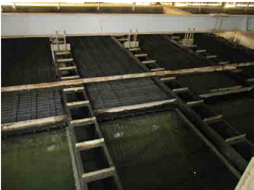
Toker浄水場 傾斜板型沈殿池
