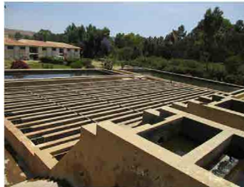
S.V浄水場 フロック形成池
