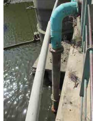
S.Vダム 現在使用中の取水管
