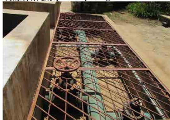
S.V浄水場 流入口
