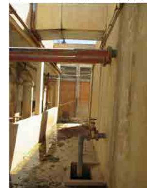
Mai Nefhi浄水場 パルセーター型凝集沈殿池とろ過池 各バルブの開閉が十分機能しない。
