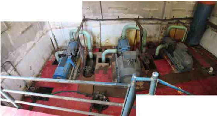
Mai Nefhi浄水場 送水ポンプ 漏水が顕著。
