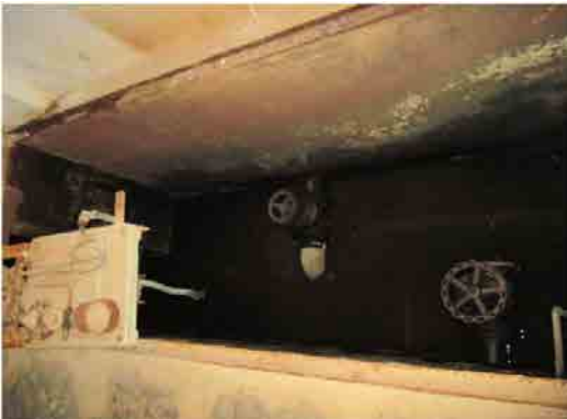
S.V浄水場 ろ過池の排泥バルブ等
