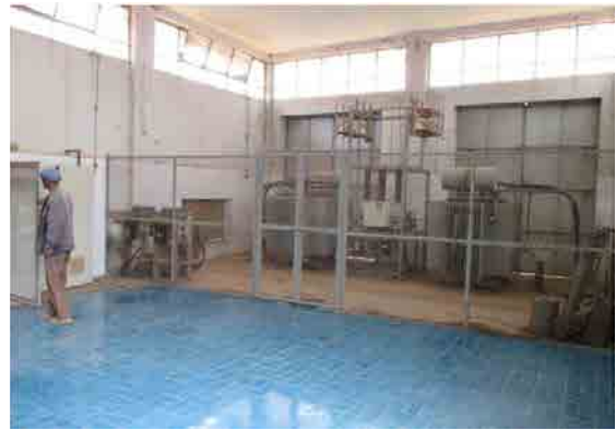
Mai Nefhi浄水場 受電変圧器
