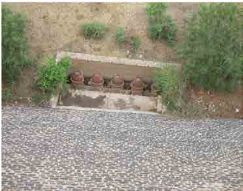
Mai Nefhiダム 排泥管 使用できるのかは不明。
