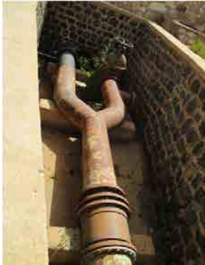
Mai Nefhi浄水場 流入口
