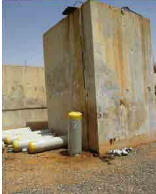
Mai Nefhi浄水場 塩素ガス 着水井に直接注入
