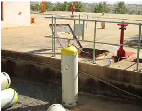
Toker浄水場 塩素ガス 浄水池に直接注入。鋼製蓋が塩素ガスにより腐食。
