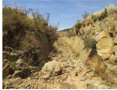
Adi Shekaダム～Belezaダム付近までの開水路 水路内への落石多い。
