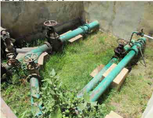
S.V浄水場 送水管と逆洗の流入、流出管
