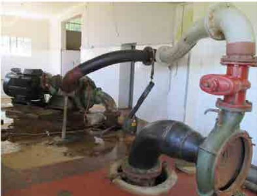
S.V浄水場 送水ポンプ
