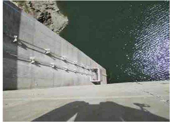
Tokerダム 堤体一体型取水塔
