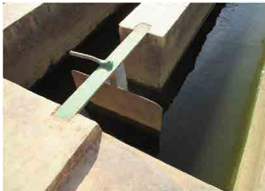
S.V浄水場 フロック形成池のデフレクター 腐食で未稼働。
