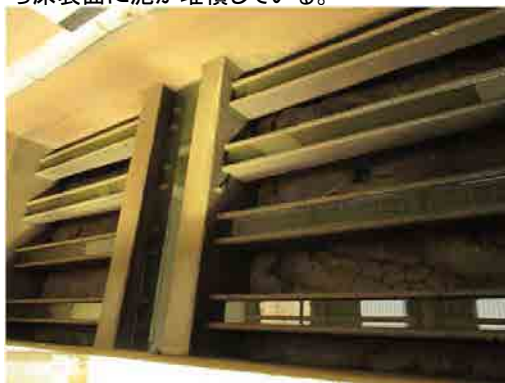
S.V浄水場 ろ過池
