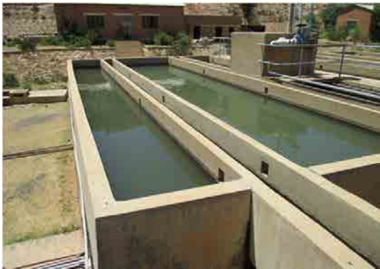
Mai Nefhi浄水場 パルセーター型凝集沈殿池
