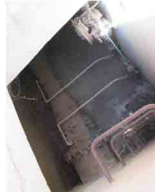
Mai Nefhi浄水場 流入口 故障したベンチュリー計測器
