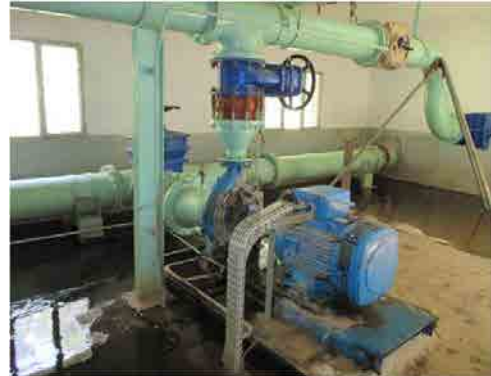
Adi Sheka導水ポンプ 漏水しているが修理されていない。
