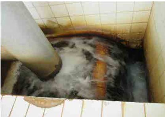
Mai Nefhi浄水場 アカズール型ろ過池 下部 ろ過後の水。
