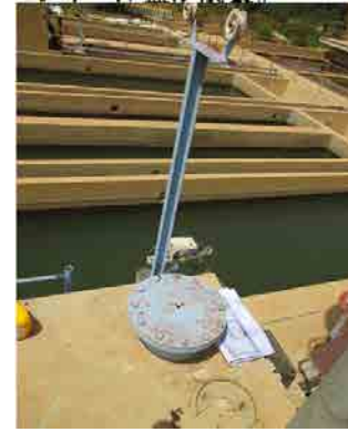
Mai Nefhi浄水場 パルセーター型凝集沈殿池 水位リレースイッチの故障。
