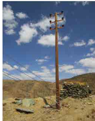
Tokerダム 15KVAの送電線
