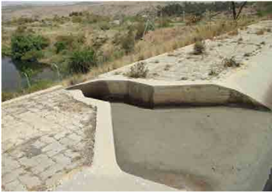
Toker浄水場 排水池と排水処分池の水路(越流部)
