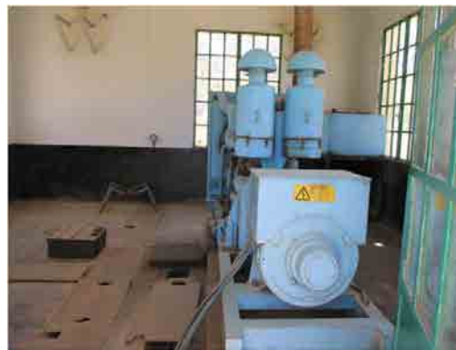
S.V浄水場 発電機 送水ポンプ稼働できない容量で未使用。
