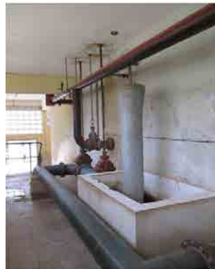
Mai Nefhi浄水場 アカズール型ろ過池 下部 サイフォンが機能していない。
