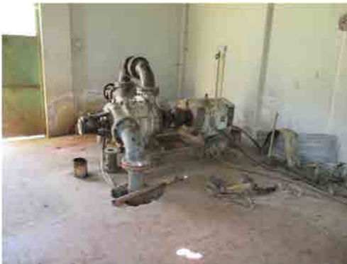
Mai Serwaダム 故障中の導水ポンプ。
