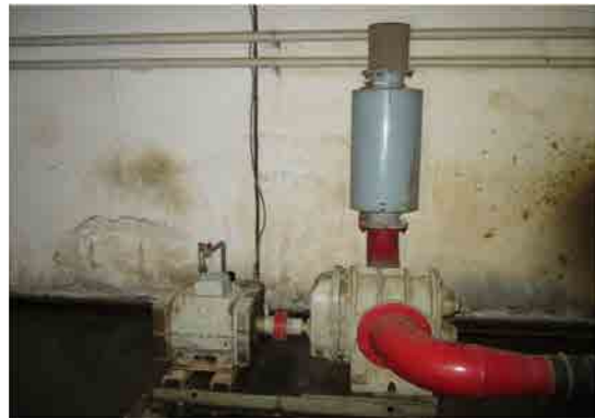
Mai Nefhi浄水場 エアブローポンプ
