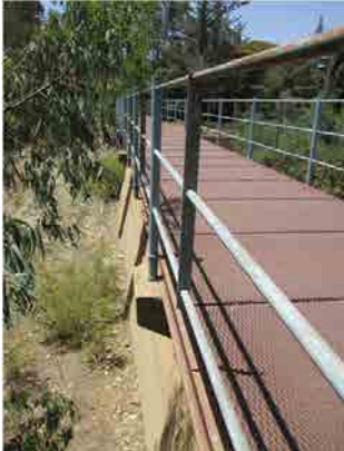
Mai Serwaダム 旧洪水吐き 下流部崩壊後、未使用。
