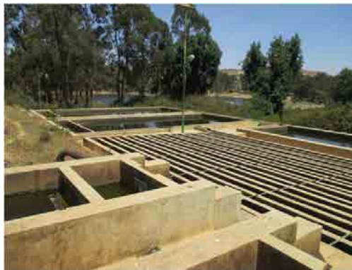
S.V浄水場 フロック形成池
