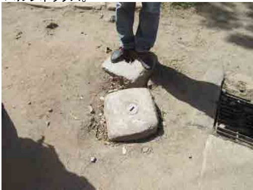
市内配水管 バルブボックス。
