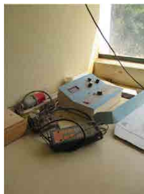
Mai Nefhi浄水場 pH、濁度故障。
