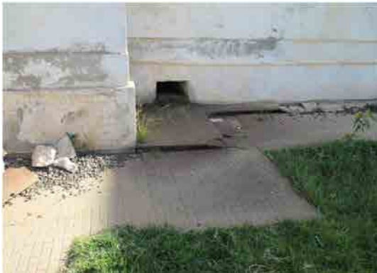
S.V浄水場 ろ過池と浄水池の建屋 沈下約5cm。
