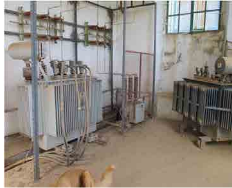
S.V浄水場 受電変圧器
