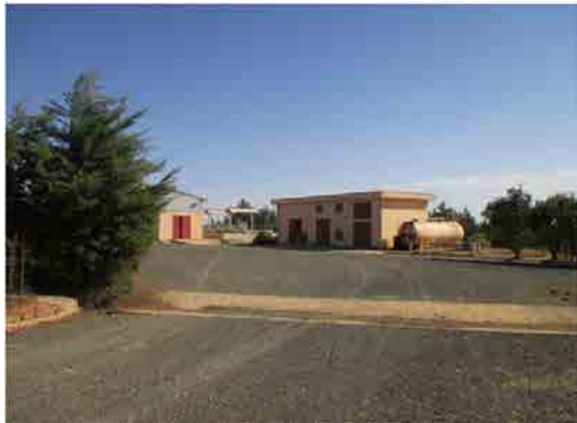
Toker浄水場 発電機室と受電変圧器室と給油タンク
