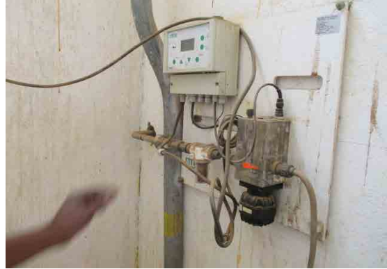
Mai Nefhi浄水場 旧塩素ガス室 旧塩素注入器。
