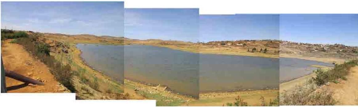
Valle Gneccchiダム アースダム全体 2015年4月時点で水位は低く十分な貯水量がない。ダム湖内の堆積土が多い。
