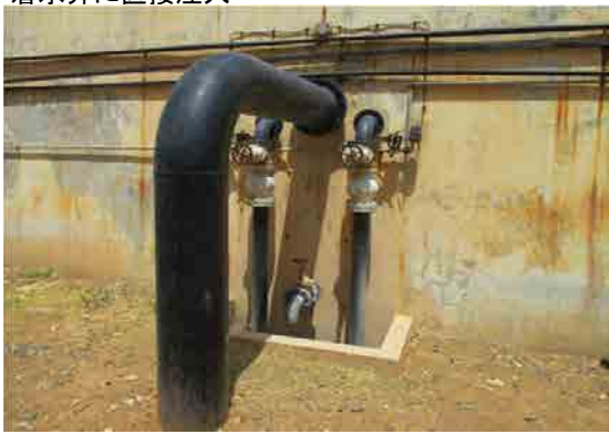
Mai Nefhi浄水場 着水井からパルセーター型凝集沈殿池への流入管 圧力感知型排出バルブ
