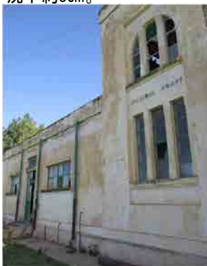
S.V浄水場 ろ過池と浄水池の建屋 建物の亀裂と剥離が目立つ。
