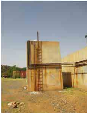
Mai Nefhi浄水場 着水井
