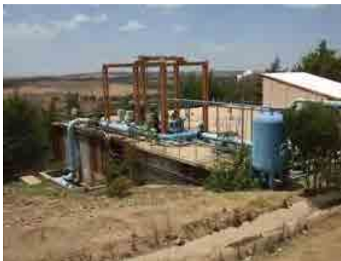
Toker 浄水場からの送水ポンプ
