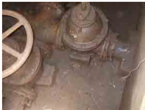
配水本管バルブ
