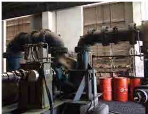
Toker ポンプ所 導水ポンプ
