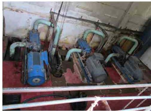
Mai Nefhi 浄水場 送水ポンプ
