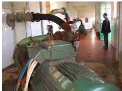
Stretta Vaudetto 浄水場からの送水ポンプ
