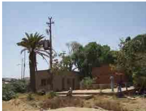
Mai Chehot ポンプ所 外観
