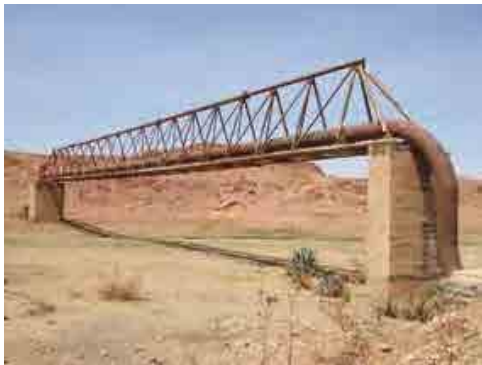
Mai Nefhi からの送水管路 水管橋
