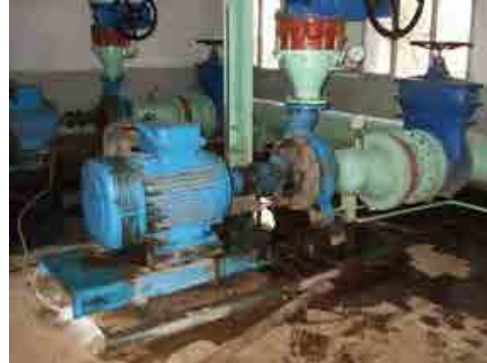
Adi Sheka ポンプ所
