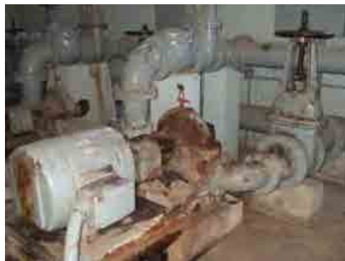
Denden ポンプ所 配水ポンプ
