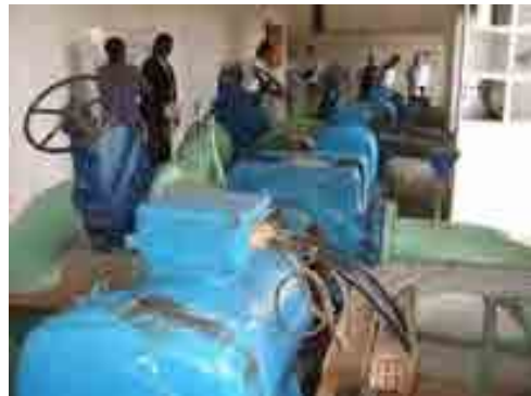
Sembel ポンプ所 配水ポンプ
