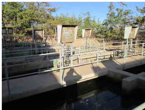
Toker 浄水場 凝集設備
