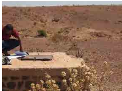
Mai Nefhi からの送水管路 バルブ施設
