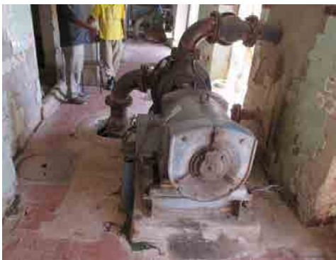
Godaiif ポンプ所 配水ポンプ
