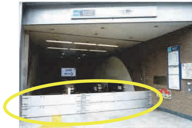
地下駅出入口の止水板
