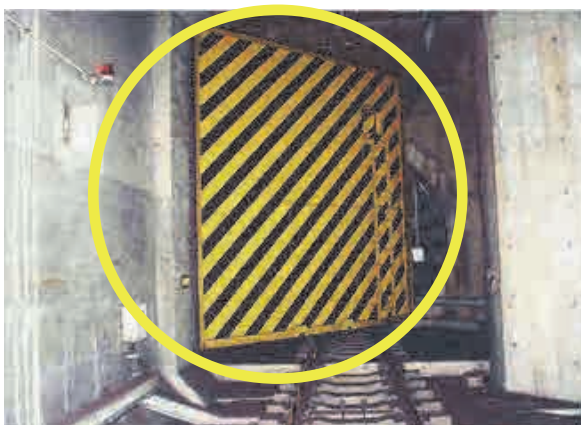
トンネル内防水ゲート
