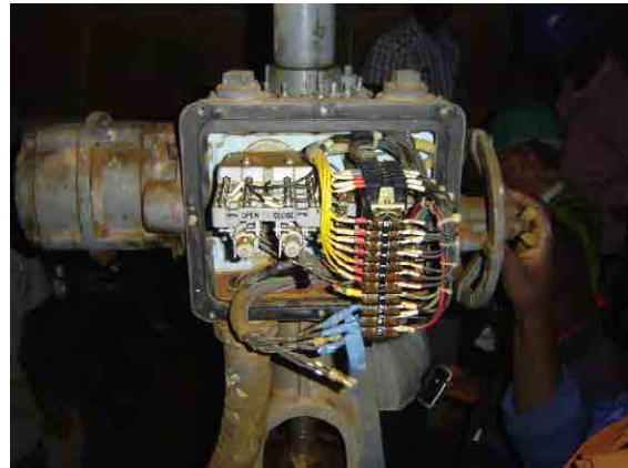
ブロック D 吐出弁バルブコントローラ内部 (浸水による端子部の腐食が確認できる)
