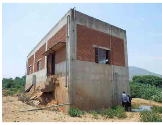
ブロック D ポンプ機場 (洪水によって階段付近が大きく浸食されている)
