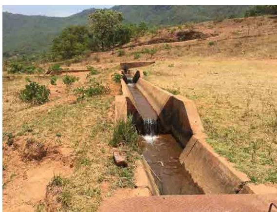
ブロック B 灌漑水路 (分水工およびファームポンド方向を望む)
