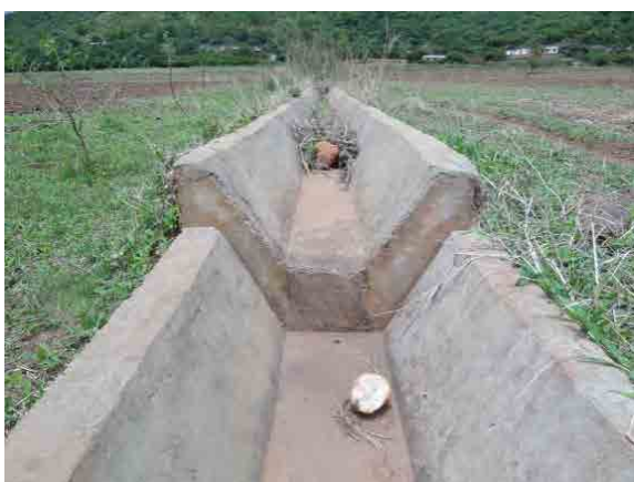
灌漑局により建設されたブロック A の灌漑水路 (計 9 路線、総延長 3,660m)
