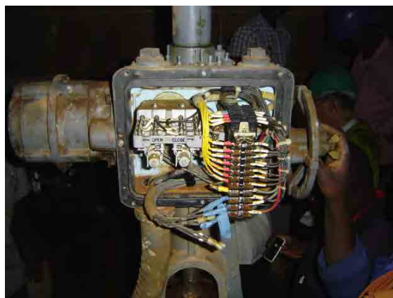
ブロック D 吐出弁バルブコントローラ内部 (浸水による端子部の腐食が確認できる)
