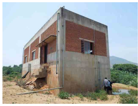
ブロック D ポンプ機場 (洪水によって階段付近が大きく浸食されている)
