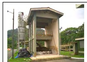
x. Morretes Instalação de desaguamento do lodo
