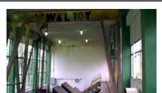
f. Guindaste tipo portal de 10 ton da ETE Belém
