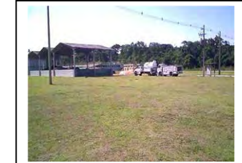
bd. Matinhos Transformador instalado em poste e painel de entrada e transformação de força
