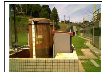
r. Sao Jorge Instalação para aplicação de cloreto férrico (III)
