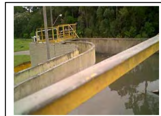
al. Padilha Sul Medidor ultrassônicos de nível de água
