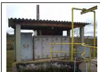
a. Cabine de entrada de força. Painel de controle da bomba.(1)
