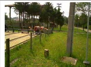
w. Santa Quitéria Instalação de aplicação do gás cloro para desodorização do UASB
