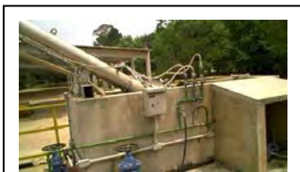
al. Condutor de lodo tipo parafuso do tanque de equilíbrio de lodo adensado da ETE Belém
