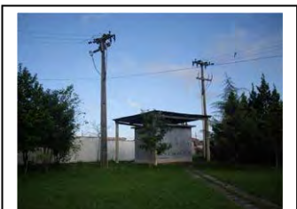
az. Subestação elétrica de Atuba Sul (1)
