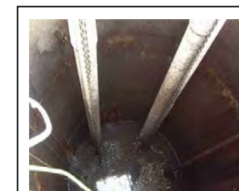
f. Bomba de retransmissão (1)
