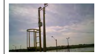
u. Fazenda Rio Grande Dispositivo para queima de gás gerado do tanque de reação do UASB
