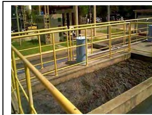
y. Santa Quitéria Bomba de recalque do FAD
