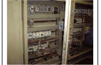
aw. Painel de controle do desaguador de lodo de Atuba Sul
