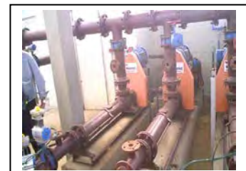
aw. Matinhos Bomba de água saturada
