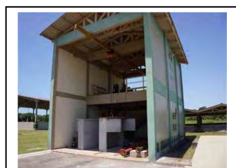
v. Guaratuba Bomba de inserção do lodo no desaguador centrífugo.
