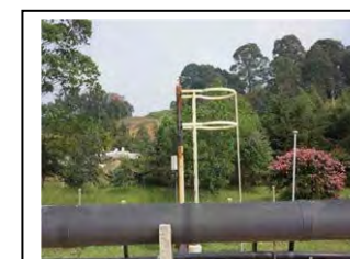
bd. Santa Quitéria Dispositivo para queima do gás gerado do UASB, Tubulação do dispositivo de neutralização
