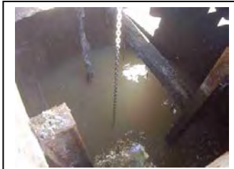
i. Bomba de retransmissão. (1)
