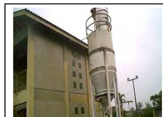
y. Guaraqueçaba Silo de armazenamento de cal hidratada.
