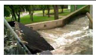
m. Gradeamento fino da ETE Belém (primeira fase)
