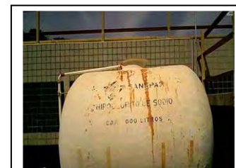
ag. Sao Jorge Tanque de armazenamento de hipoclorito de sódio
