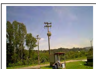
b. Sao Jorge Painel de entrada e transformação de força
