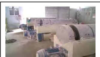
ap. Desaguador centrífugo de lodo da ETE Belém
