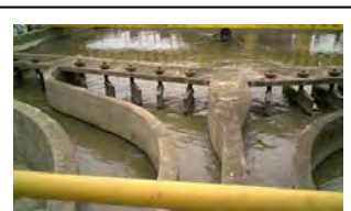
p. Placas defletoras de fluxo do tanque de desaneração da ETE Belém.
