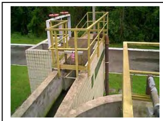
i. Morretes Comporta de distribuição
