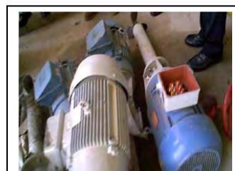
af. Guaratuba Aerador
