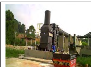
az. Santa Quitéria Dispositivo para neutralização do gás gerado do UASB
