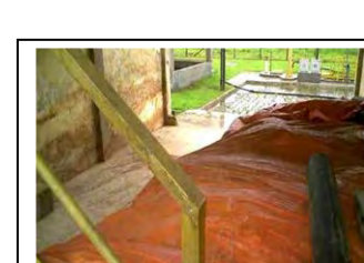
z. Guaraqueçaba Compressor de ar
