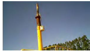
v. Dispositivo de queima do gás gerado no UASB de Atuba Sul
