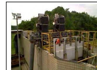
ai. Padilha Sul Removedor automático de detritos e comporta de separação
