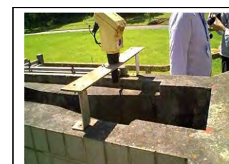
l. Sao Jorge Medidor ultrassônicos de nível de água
