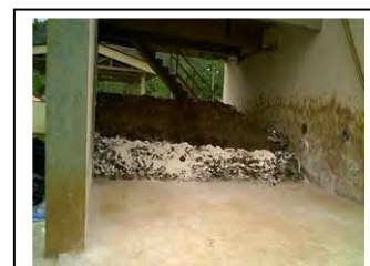
z. Morretes Instalação de desaguamento do lodo
