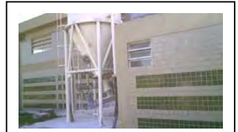
au. Silo de armazenamento de cal para ser misturada com lodo desaguado em Atuba Sul
