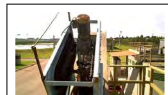
r. Fazenda Rio Grande Transportador de detritos.
