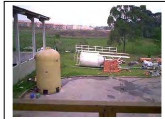
ad. Padilha Sul Silo para armazenamento de cal hidratado, tanque de armazenamento de cloreto férrico (III)
