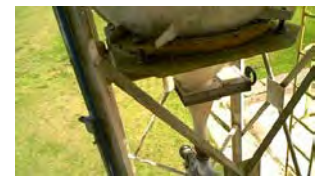
ad. Fazenda Rio Grande Silo de armazenamento de cal hidratado.
