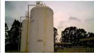
x. Silo de armazenamento do cloreto férrico (III) da FAD de Atuba Sul
