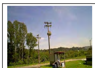
a. Sao Jorge Transformador instalado em poste
