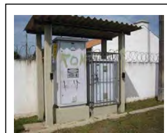
b. Cabine de entrada de força e painel de controle da bomba
