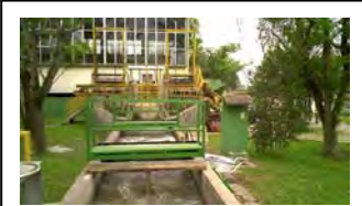
j. Removedor automático de detritos da ETE Belém
