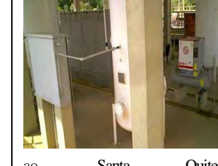
ao. Santa Quitéria Painel de controle do dispositivo de mistura água-ar
