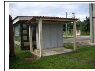
f. Morretes Painel de controle do removedor automático de detritos
