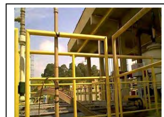
bb. Santa Quitéria Raspador de lodo do tanque de FAD
