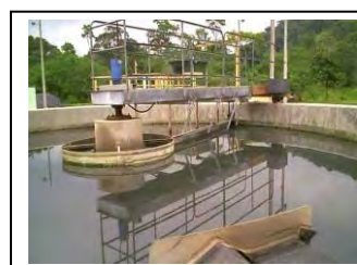
r. Morretes Raspador de lodo do tanque de adensamento final do lodo
