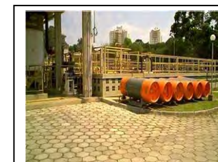
aw. Santa Quitéria Instalação de dosagem de gás cloro para desinfecção
