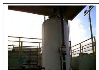
aa. Matinhos Tanque de mistura água-ar
