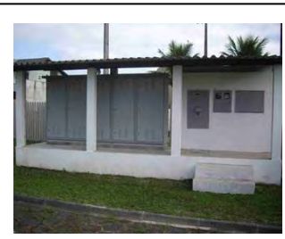
b. Cabine de entrada de força, painel de controle da bomba.
