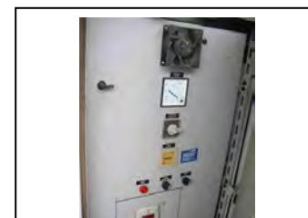
c. Painel de controle da bomba (1)
