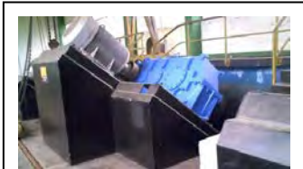
e. Redutor de velocidade da condução e motor elétrico da bomba elevatória da ETE Belém
