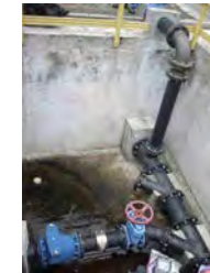
e. Válvula de descarga e tubulação de descarga
