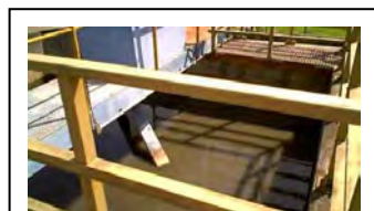
o. Fazenda Rio Grande Raspador de lodo do tanque de sedimentação inicial.
