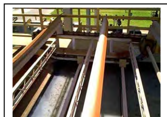
v. Sao Jorge Raspador de lodo do tanque FAD
