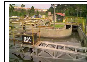
q. Padilha Sul Comporta de separação (do lado jusante)
