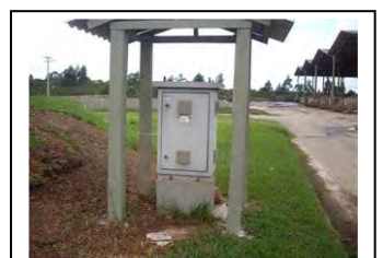
bc. Painel de controle do removedor de lodo do adensador de Atuba Sul
