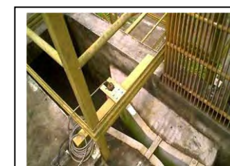
g. Guaraqueçaba Medidor ultrassônico de nível de água
