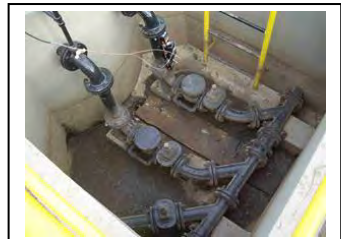
h. Tubulação de descarga, válvula de retenção, válvula de descarga.
