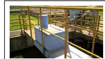
n. Fazenda Rio Grande Raspador de lodo do tanque de sedimentação inicial e placa defletora para ordenamento do fluxo.
