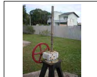
d. Válvula de abertura e fechamento da comporta de entrada
