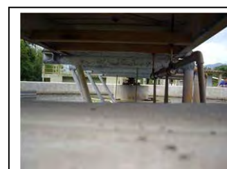
s. Morretes Raspador de lodo do tanque de adensamento final do lodo
