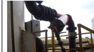
ag. Bomba de água saturada da FAD de Atuba Sul
