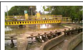
q. Removedor de lodo do tanque de desaneração da ETE Belém.
