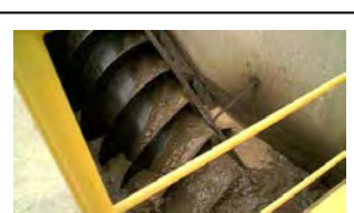
w. Bomba parafuso de retorno de lodo da ETE Belém.
