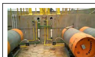
aa. Instalação de dosagem de gás cloro da ETE Belém.
