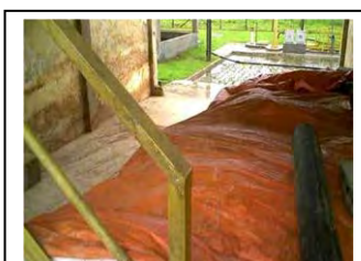
w. Guaraqueçaba Instalação para dosador de polímero
