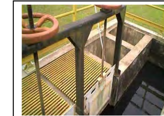
j. Comporta de distribuição UASB de Pontal do Paraná
