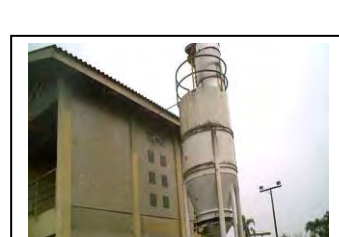
x. Guaraqueçaba Instalação para dosador de cal hidratada.
