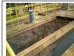
ae. Santa Quitéria Misturador do tanque de mistura de produtos químicos
