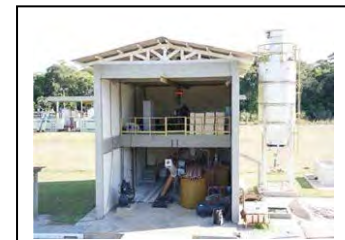
ao. Matinhos Compressor de ar
