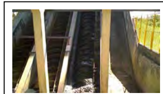
c. Bomba de recalque de Atuba Sul
