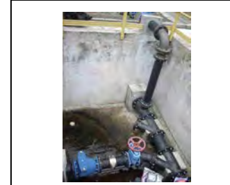
e. Válvula de descarga e tubulação de descarga
