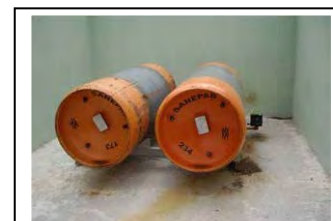
ah. Morretes Dosador de gás cloro para desinfecção
