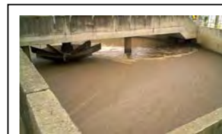
u. Equipamento de aeração da ETE Belém
