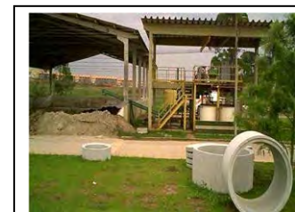
ag. Padilha Sul Instalação para desaguamento do lodo
