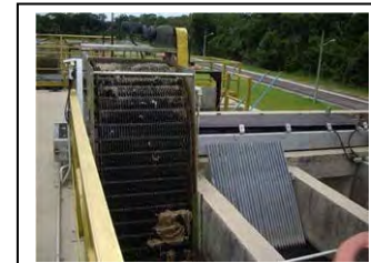
e. Removedor de detritos de Pontal do Paraná
