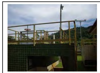
o. Morretes Válvula by-pass do tanque de distribuição FAD
