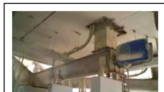
aq. Transportador parafuso para lodo desidratado da ETE Belém
