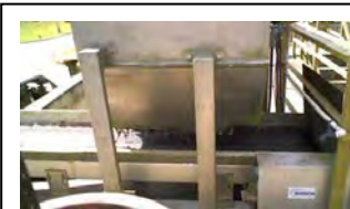
j. Fazenda Rio Grande Removedor automático de detritos e esteira transportadora
