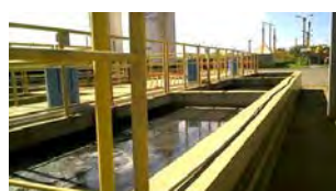
ac. Agitador do tanque para mistura de produtos químicos da FAD de Atuba Sul
