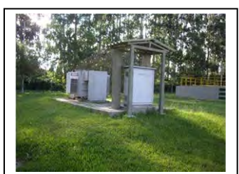
ba. Entrada de força e transformador da bomba de recalque de Atuba Sul
