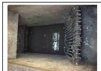
h. Crivo em barras para remoção de detritos (2)
