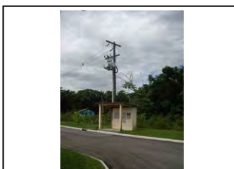
ak. Morretes Transformador instalado em poste
