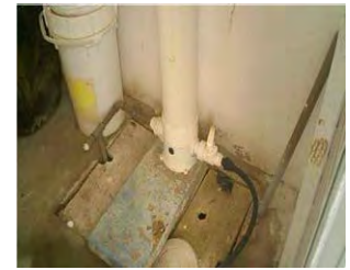
ad. Guaraqueçaba Dosador de cloreto para desinfecção.
