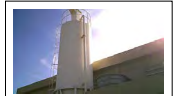
av. Silo de armazenamento de cal para ser misturada com lodo desaguado em Atuba Sul
