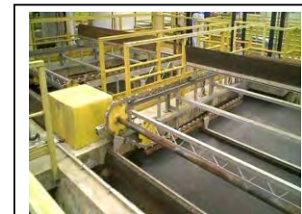
s. Raspador de espuma do tanque FAD de Pontal do Paraná
