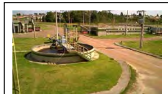
v. Fazenda Rio Grande Raspador de lodo do tanque de condensação do lodo.
