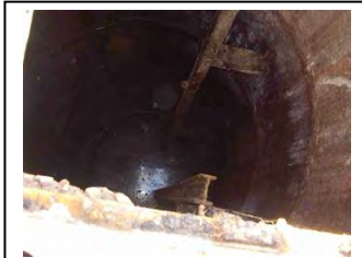
i. Bomba de retransmissão. (1)
