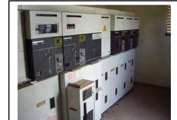
ap. CIC Xisto Painel de entrada de energia elétrica (2)
