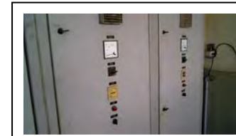
f. Painel de controle da bomba de recalque de Atuba Sul
