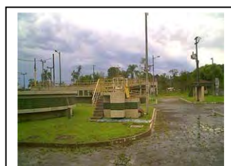
a. Guaraqueçaba Transformador Instalado em poste
