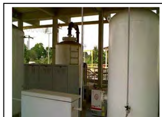
aj. Santa Quitéria Tanque de mistura água-ar
