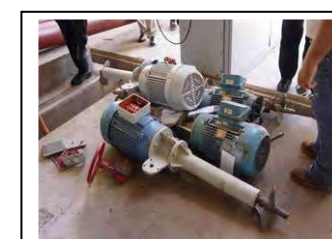
ap. Guaratuba Aerador
