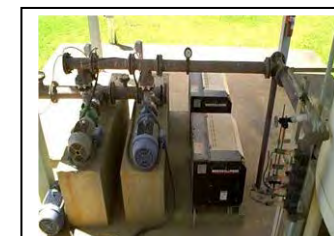
ab. Sao Jorge Tubulação de distribuição do volume de ar
