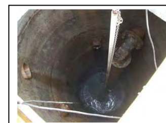
u. Morretes Bomba de recirculação do lodo do tanque de adensamento final do lodo
