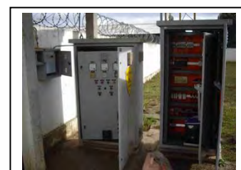
b. Cabine da entrada de força, Painel de controle da força.
