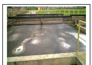
bj. Tanque da FAD de Atuba Sul
