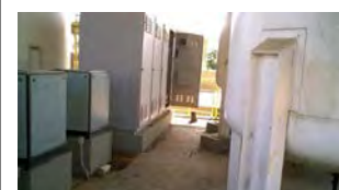
al. Painel de controle da instalação de FAD de Atuba Sul
