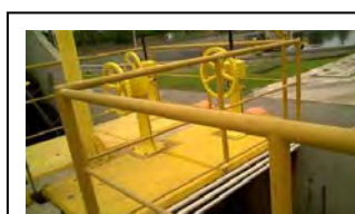
z. Comporta de retorno de lodo da ETE Belém.
