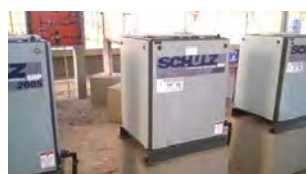
aj. Compressor de ar da FAD de Atuba Sul
