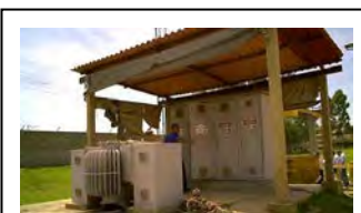
p. CIC Xisto Painel de controle do removedor automático de detritos
