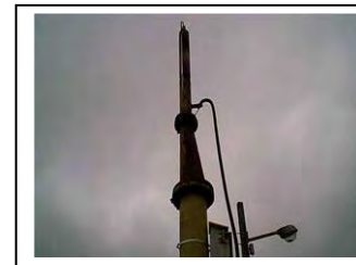
m. Morretes Dispositivo para queima de gás gerado
