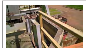
h. Fazenda Rio Grande Gradeamento fino e comporta de distribuição
