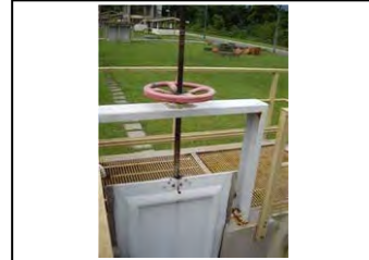
ae. Morretes Válvula by-pass do tanque de confluência do efluente
