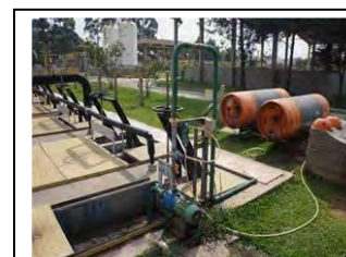
bc. Santa Quitéria Instalação de dosagem do gás cloro para desodorização do UASB
