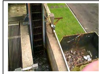
d. Morretes Removedor automático de detritos e gradeamento fino
