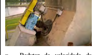
x. Redutor de velocidade da condução de bomba parafuso para retorno de lodo e motor elétrico da ETE Belém
