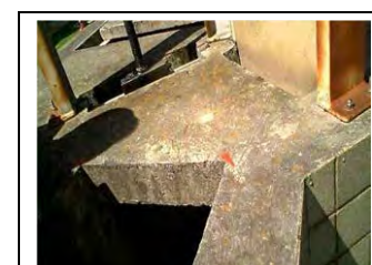
k. Sao Jorge Comporta de separação (do lado de jusante)
