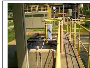
z. Santa Quitéria Comporta de distribuição
