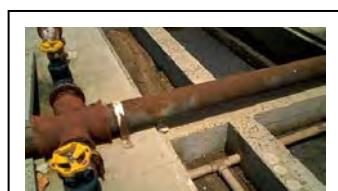
ac. CIC Xisto Tubulação do gás gerado
