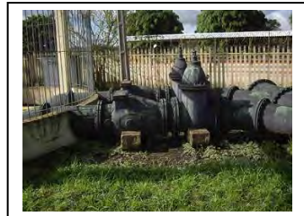
h. Válvula de retenção, válvula de descarga e tubulação de descarga (1)
