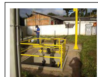
c. Bomba elevatória.
