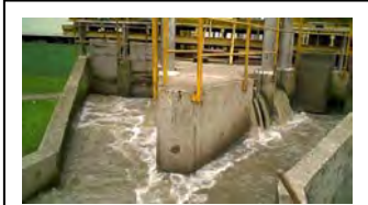
l. Comporta divisória (intermediária) da ETE Belém
