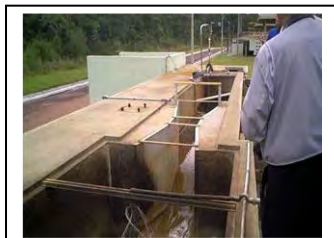
at. Matinhos Painel de controle medidor ultrassônico de nível de água
