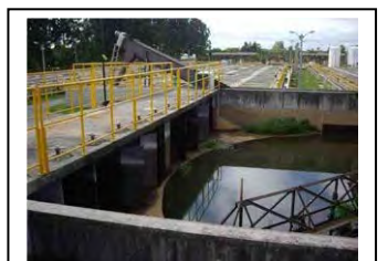
bd. Placas de ordenamento de fluxo da entrada do desanador de Atuba Sul
