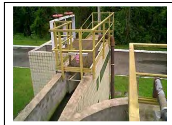
h. Morretes Medidor de nível ultrassônico de calha parcial
