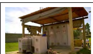
w. CIC Xisto Painel de controle do raspador de lodo do primeiro tanque de adensamento
