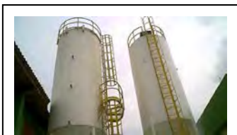
au. Silo para armazenamento de cal hidratada para lodo desidratado da ETE Belém
