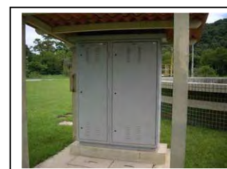
t. Morretes Painel de controle do raspador de lodo do tanque de adensamento final do lodo
