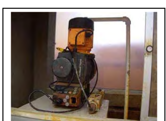
bh. Bomba dosadora de cloreto férrico (III) da FAD de Atuba Sul
