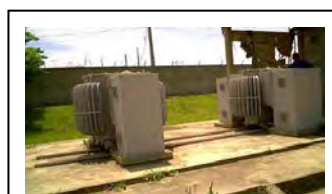
b. CIC Xisto Transformador
