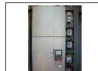
e. Painel de controle da bomba. (3)
