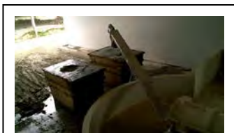
ar. Transportador parafuso para lodo desidratado da ETE Belém
