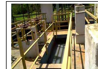
u. Sao Jorge Misturador do tanque de mistura de produtos químicos
