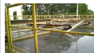
ae. Raspador de espuma do tanque de FAD de Atuba Sul
