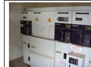
ao. CIC Xisto Painel de entrada de energia elétrica (1)
