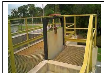
be. Comporta de bypass da instalação de remoção de detritos de Pontal do Paraná
