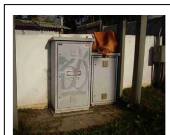
a. Cabine de entrada de força, painel de controle da bomba.
