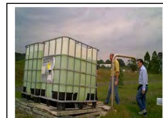
af. Padilha Sul Instalação de aplicação da água peróxido de hidrogênio para desodorização do
