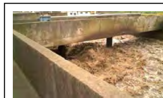
t. Equipamento de aeração da ETE Belém
