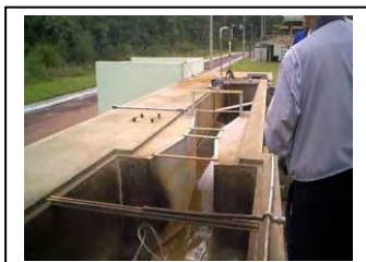
ar. Matinhos Dosador de gás cloro para desinfecção
