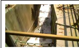
am. CIC Xisto Medidor ultrassônico de nível de água
