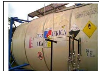
x. Padilha Sul Instalação de aplicação da água de peróxido de hidrogênio para desodorização do UASB
