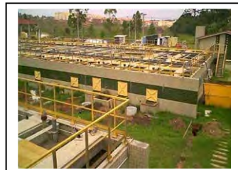
v. Padilha Sul Válvula de drenagem do lodo
