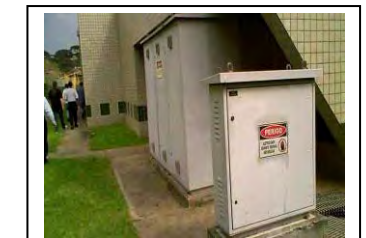
n. Padilha Sul Painel de controle de removedor automático de detritos
