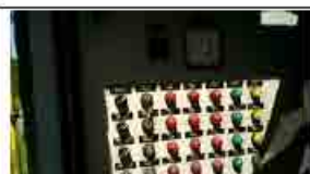
b. Painel de controle da comporta de entrada de Atuba Sul
