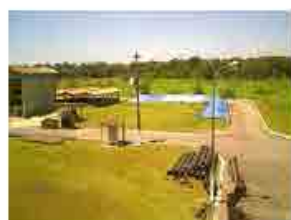
a. Guaratuba Transformador instalado em poste
