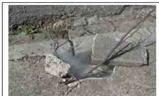
Vazamento de fumaça na rua
