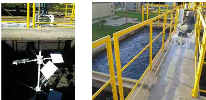
Floculador instalado no 1º estágio das bacias de floculação no 3º exercício fiscal (após melhoria)
