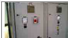
e. Painel de controle da bomba de recalque de Atuba Sul
