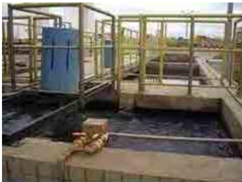
Tanque de mistura na instalação FAD (antes da melhoria) (Na frente: Tanque de mistura rápida / Atrás: Tanques de floculação)
