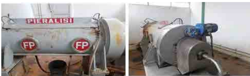
Máquina Centrífuga de Desidratação na ETE Santa Quitéria
