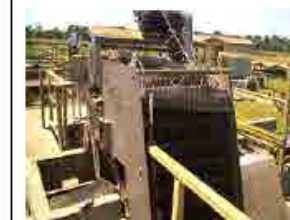
f. Guaratuba Removedor automático de detritos.
