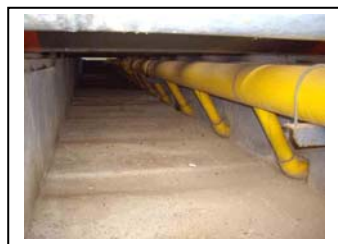
cn. Tubulação para neutralização de gás cloro em Irai
