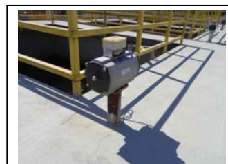
bx. Saiguaçu Válvula da entrada do tanque de filtração
