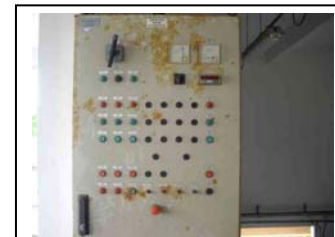
bo. Praia de Leste Painel de controle de equipamento de desaguidamento
