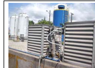
av. Praia de Leste Tubulação para fluoreto de hidrogênio
