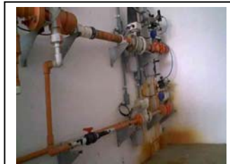
as. Praia de Leste Tubulação de dosagem de dióxido de cloro
