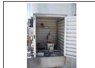
au. Praia de Leste Instalação Bomba dosadora de fluoreto de hidrogenio
