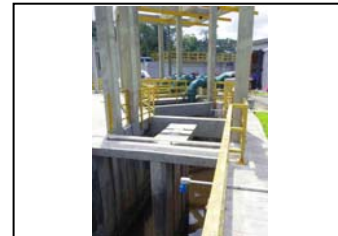
b. Praia de Leste Medidor ultrassônico de nível de água do poço
