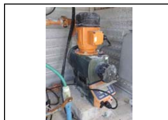
bw. Saiguaçu Bomba de dosagem de ácido sulfúrico
