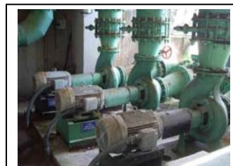
z. Praia de Leste Bomba para retrolavagem do tanque de filtração
