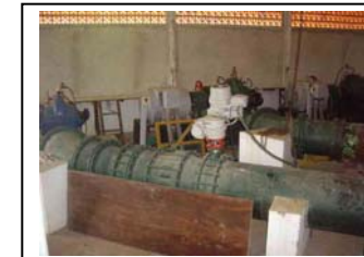
f. Praia de Leste Bomba para transmissão de água
