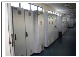
cs. Painel de controle da bomba de envio de água em Irai
