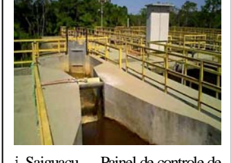
j. Saiguaçu Painel de controle de Agitador lento do tanque de floculação
