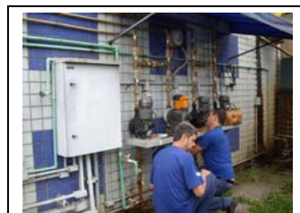
bo. Bomba para dosagem de polímero em Irai
