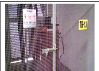
en. Transformador da entrada de força da instalação de tratamento de água de Irai
