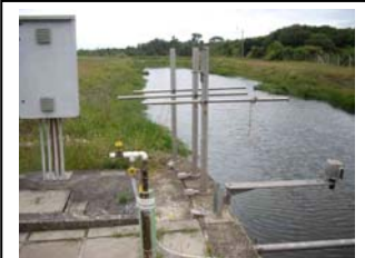
a. Medidor ultrassônico de nível de água da captação de Irai
