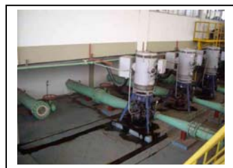
cr. Bomba de envio de água do sistema Piraquara em Irai
