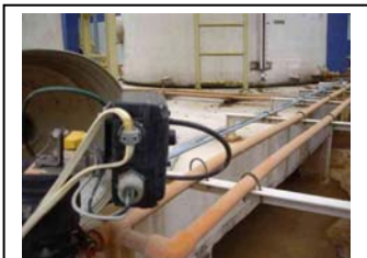
ar. Tubulação de dosagem de cloreto férrico (III) de Irai
