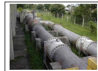
cz. Medidor de vazão do envio de água de Irai
