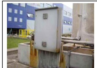
ax. Painel de controle do dosador de hexafluorossilicato de hidrogênio de Irai
