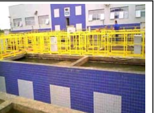
n. Misturador lento do tanque de floculação de Irai
