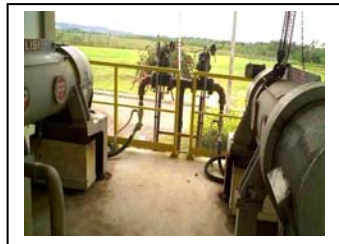
dc. Desaguador centrífugo de lodo de Irai
