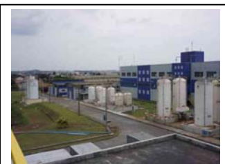
ei. Equipamentos para dosagem de produtos químicos de Irai
