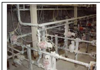
bu. Tubulação de dosagem de cal em Irai
