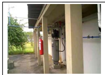
cu. Tubulação de ar comprimido em Irai
