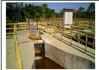
h. Saiguaçu Comporta da entrada de tanque de floculação
