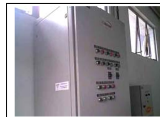
al. Painel de controle da água de drenagem de lavagem de Iraí
