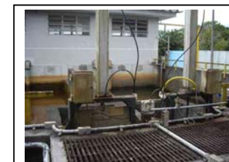
t. Praia de Leste Comporta de entrada de lodo drenado
