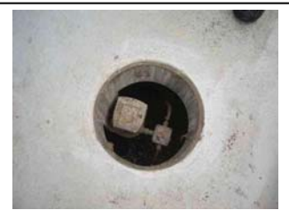
eh. Medidor ultrassônico de nível do poço para captação de água de Irai
