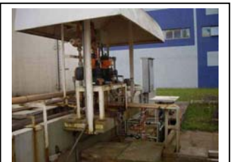
as. Painel de controle do dosador de cloreto férrico (III) de Irai
