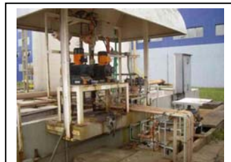
aq. Bomba de dosagem de cloreto férrico (III) de Irai
