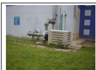
er. Bomba para pressurização do equipamento de água saturada de Irai
