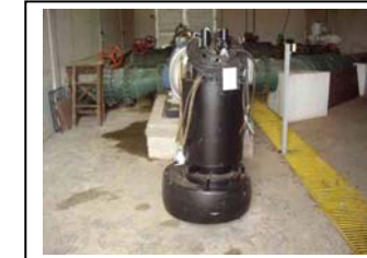
cf. Praia de Leste Bomba de captação de água
