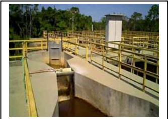
m. Saiguaçu Painel de controle da comporta
