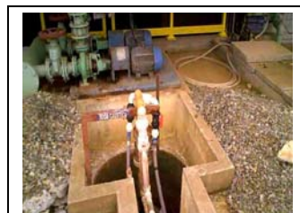
cc. Tubulação para dosagem de soda cáustica em Irai
