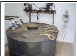
ej. Reator para geração de dióxido de cloro de Irai
