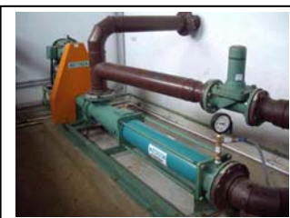
ak. Bomba de recirculação da água drenada de lavagem de Iraí
