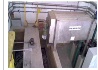
bq. Saiguaçu Misturador do tanque de lodo com saída de pequena quantidade
