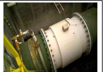
j. Medidor eletromagnético de vazão da captação de água de Irai
