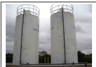
ca. Tanque de armazenamento de soda cáustica em Irai
