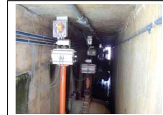
cc. Praia de Leste Valvula de retrolavagem do tanque de filtração
