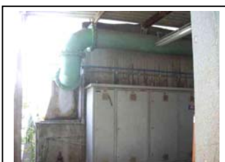
ad. Praia de Leste Painel de controle do tanque de filtração
