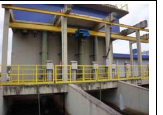
f. Bomba de captação de água de Irai
