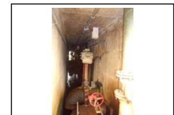
n. Praia de Leste Válvula de drenagem do tanque de floculação
