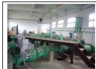
bh. Praia de Leste Instalação de bomba envio de água de sistema xx
