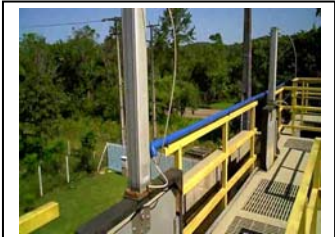
l. Saiguaçu Comporta da entrada do tanque de sedimentação química
