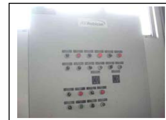
cy. Painel de controle da câmara de ar de Irai
