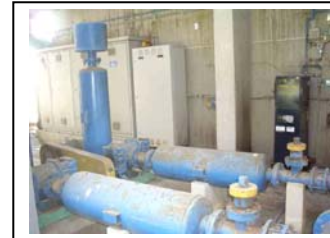
ab. Praia de Leste Instalação de limpeza por ar do tanque de filtração
