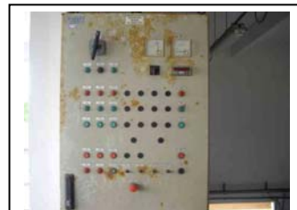
bm. Praia de Leste Painel de controle de bomba de inserção de
