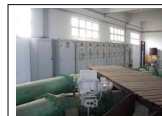
bk. Praia de Leste Painel de controle da bomba de transmissão de água
