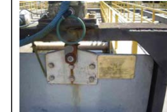
br. Praia de Leste Comporta da entrada do tanque de sedimentação química
