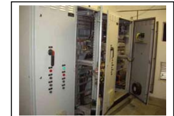
g. Praia de Leste Painel de controle da bomba de captação de água
