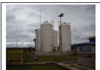
ay. Tanque de armazenamento de ácido clorídrico de Irai
