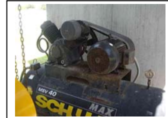
cb. Praia de Leste Compressor de ar para operação de comporta
