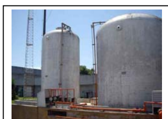
al. Praia de Leste Tanque de armazenamento de cloreto de
