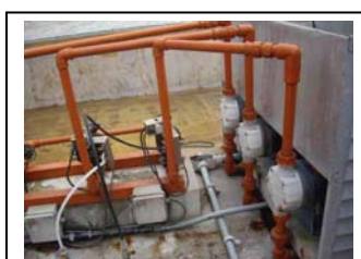
am. Praia de Leste Instalação de Bomba dosador de cloreto de
