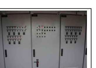
u. Painel de controle da instalação de tratamento de água de Irai
