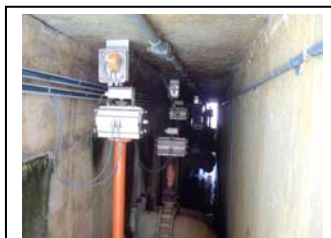
y. Praia de Leste Válvula de drenagem do tanque de água drenada
