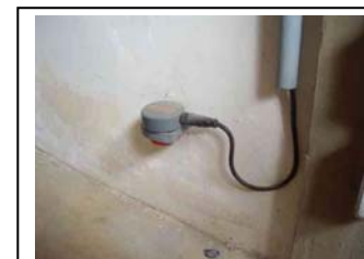
cm. Detector de vazamento de gás cloro em Irai
