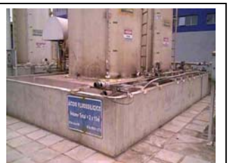
au. Bomba de fornecimento do tanque de hexafluorossilicato de hidrogênio de Irai
