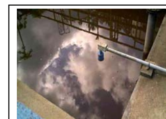
m. Morretes Medidor ultrassônico de nível de água
