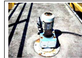
l. Praia de Leste Misturador lento do tanque de floculação
