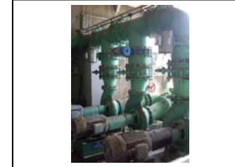
cd. Praia de Leste Bomba para retrolavagem do tanque de filtração
