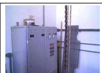
i. Morretes Pannel de controle de água saturada do filtro e de
