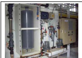
bm. Painel de controle do dosador de dióxido de cloro gerado em Irai
