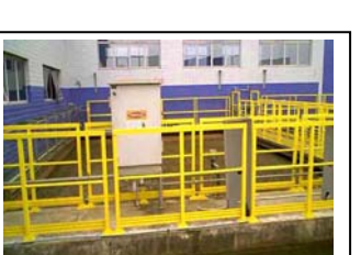
s. Painel de controle do removedor de espuma do lodo flotado de Irai
