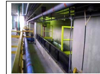
ah. Válvula de limpeza por ar de Iraí
