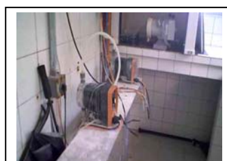
o. Morretes Bomba de dosagem de coagulante
