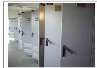
ai. Painel de controle da lavagem do tanque de filtração de Iraí
