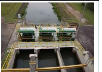
e. Painel de controle do removedor automático de detritos de Irai
