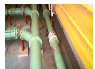
ep. Medidor eletromagnético da vazão de envio de água de Irai
