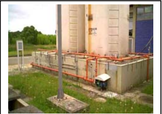
az. Bomba de fornecimento de ácido clorídrico do tanque de armazenamento de Irai
