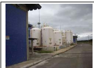
eq. Tanque para armazenamento de produtos químicos de Irai
