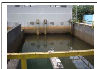
ae. Praia de Leste Misturador submerso do tanque de água drenada
