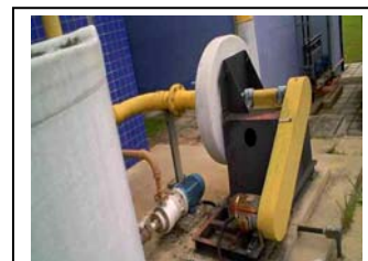
ck. Bomba de circulação de soda cáustica em Irai
