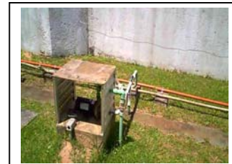
j. Praia de Leste Instalação de bomba de amostragem da água bruta
