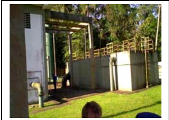
d. Saiguaçu Tubo de descarga da bomba de captação de água
