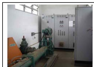
ag. Praia de Leste Painel de controle do tanque de água drenada
