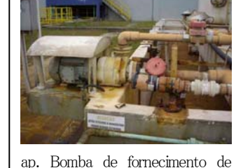
ap. Bomba de fornecimento de cloreto fêrrico (III) do tanque de armazenamento
