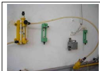
az. Praia de Leste Equipamento dosador de gás cloro
