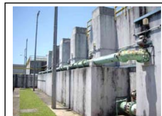
aa. Praia de Leste Válvula de retro lavagem do tanque de filtração
