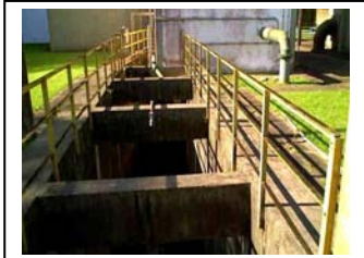
a. Saiguaçu Medidor ultrassônico de nível na captação de água
