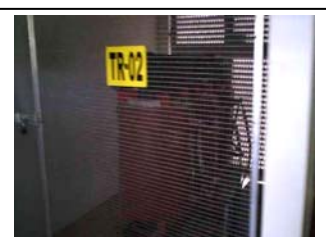
eo. Transformador da entrada de força da bomba de envio de água de Irai
