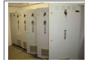
d. Praia de Leste Painel de controle da bomba de captação de água
