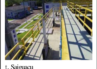
t. Saiguaçu Comporta de saída do tanque de filtração
