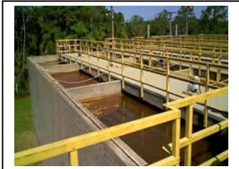
i. Saiguaçu Agitador lento do tanque de floculação
