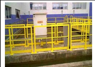
o. Painel de controle do misturador lento do tanque de floculação de Irai
