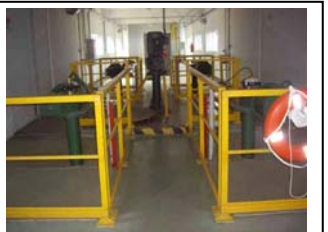
k. Misturador rápido do poço de chegada de água de Irai
