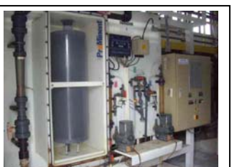
bj. Bomba de dosagem de água tratada em Irai
