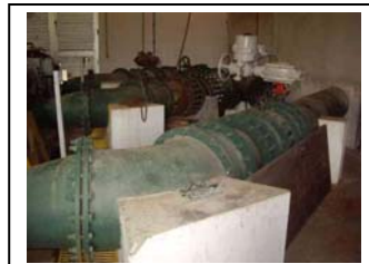
h. Praia de Leste Tubulação da bomba de transmissão de água bruta
