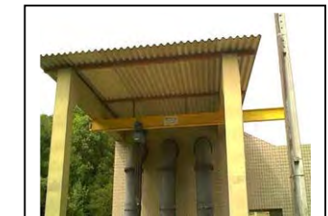
g. Padilha Sul Bomba elevatória
