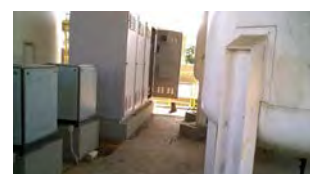
al. Painel de controle da instalação de FAD de Atuba Sul
