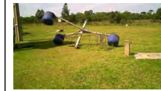
ag. Fazenda Rio Grande Equipamento de aeração da lagoa.
