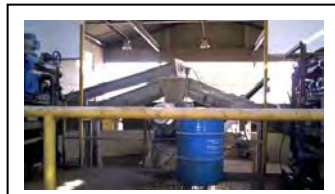
aq. Transportador do tipo parafuso do desaguador de lodo de Atuba Sul
