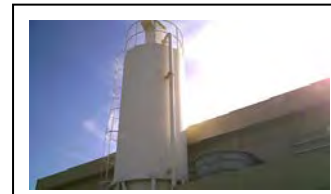
av. Silo de armazenamento de cal para ser misturada com lodo desaguado em Atuba Sul
