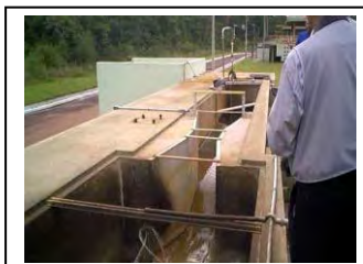
ar. Matinhos Dosador de gás cloro para desinfecção
