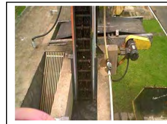
e. Morretes Removedor automático de detritos e esteira transportadora
