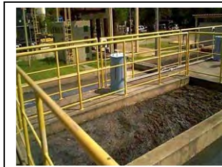
y. Santa Quitéria Bomba de recalque do FAD
