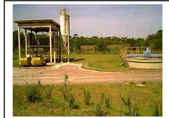
ac. Fazenda Rio Grande Instalação de desaguamento de lodo e raspador de lodo do tanque de adensamento.
