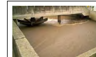
u. Equipamento de aeração da ETE Belém
