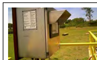
an. CIC Xisto Painel de controle de medidor ultrassônico de nível de água
