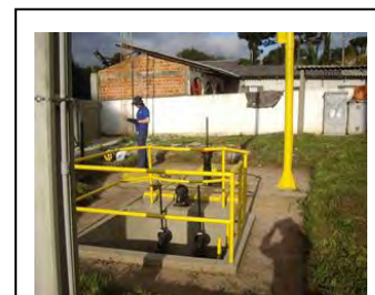
c. Bomba elevatória.
