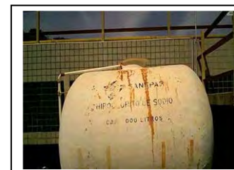
ag. Sao Jorge Tanque de armazenamento de hipoclorito de sódio
