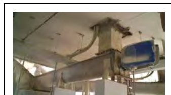
aq. Transportador parafuso para lodo desidratado da ETE Belém
