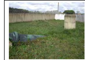
k. Tubulação de descarga (2)
