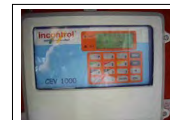
f. Painel de controle da bomba (3)
