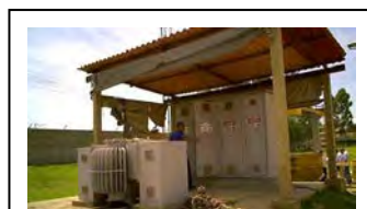
i. CIC Xisto Painel de controle de bomba elevatória
