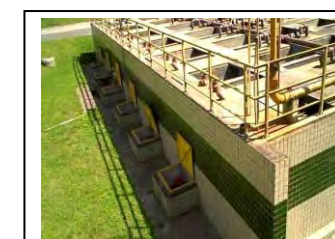
n. Sao Jorge Válvula de retirada de lodo
