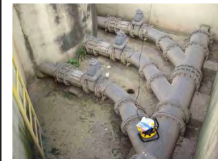
j. Válvula de retenção do tipo aleta, válvula de descarga, tubulação de descarga (2)
