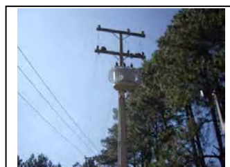
a. Transformador instalado em poste.
