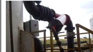
ag. Bomba de água saturada da FAD de Atuba Sul
