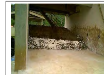
z. Morretes Instalação de desaguamento do lodo
