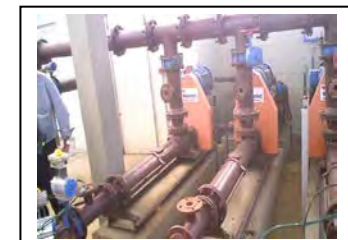
aw. Matinhos Bomba de água saturada
