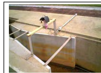
as. Matinhos Medidor ultrassônicos de nível de água
