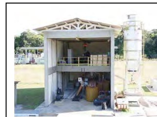
an. Matinhos Silo de armazenamento de cal hidratado
