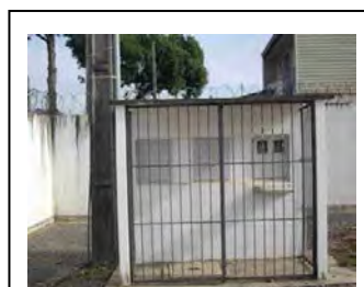
b. Cabine de entrada de força
