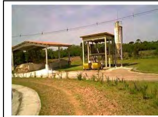
af. Fazenda Rio Grande Painel de controle da instalação de desaguamento de lodo.
