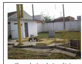
c. Casa de instalação elétrica e instalação de bomba
