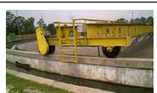
ad. Raspador de lodo tanque de decantação final da ETE Belém
