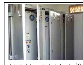
d. Painel de controle da bomba (1)
