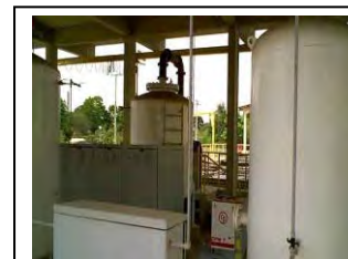
ah. Santa Quitéria Painel de controle da instalação de FAD
