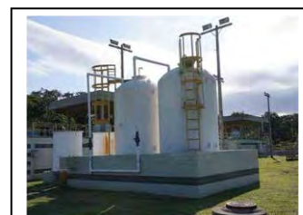
s. Matinhos Tanque de armazenamento de cloreto férrico (III)
