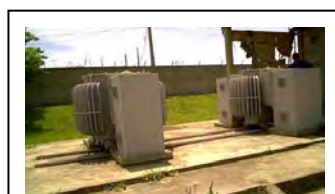
b. CIC Xisto Transformador
