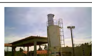
ak. CIC Xisto Silo de armazenamento de cal hidratado
