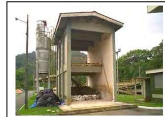
x. Morretes Instalação de desaguamento do lodo
