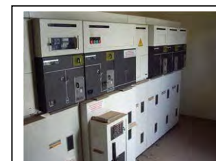
ap. CIC Xisto Painel de entrada de energia elétrica (2)
