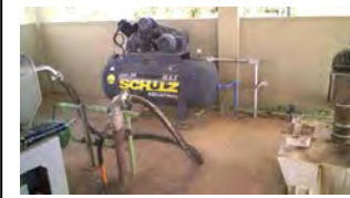
ae. Fazenda Rio Grande Compressor de ar.
