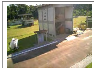
aj. Matinhos Desaguador centrífugo de lodo
