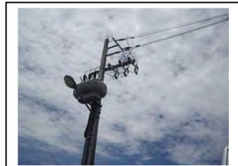
a. Transformador do poste em Pontal do Paraná
