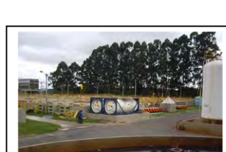
bb. Dosador de peróxido de hidrogênio de Atuba Sul
