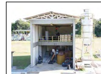
ao. Matinhos Compressor de ar
