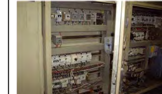
aw. Painel de controle do desaguador de lodo de Atuba Sul
