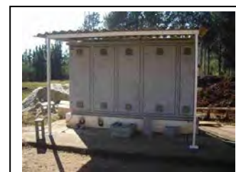
c. Painel de controle da bomba. (1)
