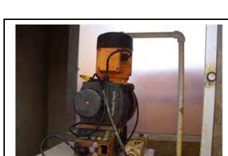
bh. Bomba dosadora de cloreto férrico (III) da FAD de Atuba Sul
