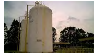
x. Silo de armazenamento do cloreto férrico (III) da FAD de Atuba Sul
