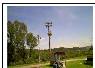
a. Sao Jorge Transformador instalado em poste
