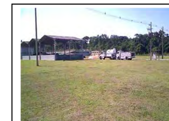
bd. Matinhos Transformador instalado em poste e painel de entrada e transformação de força
