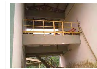
y. Morretes Instalação de desaguamento do lodo
