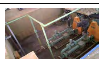
w. Fazenda Rio Grande Bomba de inserção de lodo no desaguador centrífugo.
