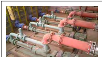
an. Bomba condutora de lodo do desaguador centrífugo da ETE Belém
