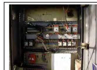
d. Painel de controle da bomba.
