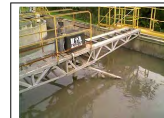
s. Padilha Sul Raspador de lodo
