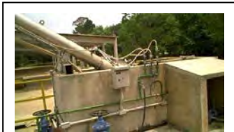
al. Condutor de lodo tipo parafuso do tanque de equilíbrio de lodo adensado da ETE Belém
