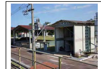
ap. Matinhos Painel de controle de desaguador centrífugo
