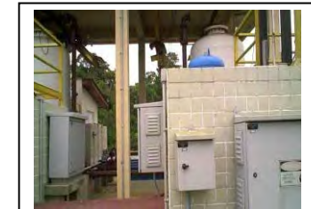
ab. Painel de controle da mistura de água-ar de Pontal do Paraná
