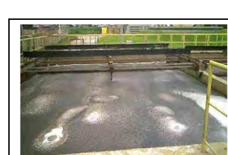
bj. Tanque da FAD de Atuba Sul
