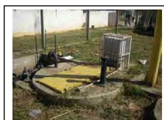
b. Instalação de bomba, Caixa de junção.
