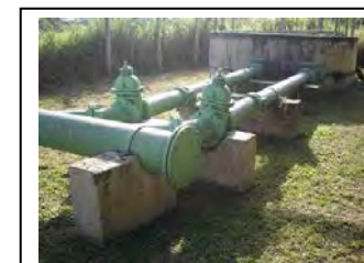
f. Tubulação de descarga da bomba (1)
