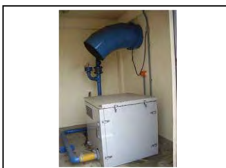
p. Morretes Ventilador para fornecimento de ar da sala de aerador do tanque FAD
