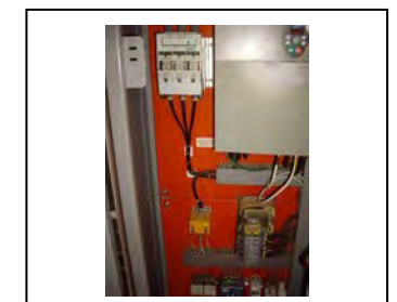
g. Painel de controle da bomba (4)
