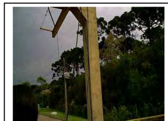
a. Padilha Sul Transformador instalado em poste
