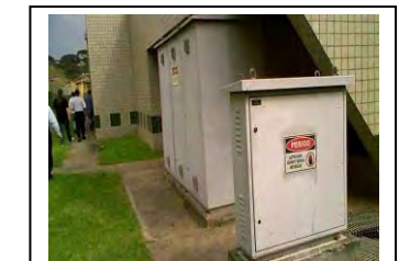
n. Padilha Sul Painel de controle de removedor automático de detritos
