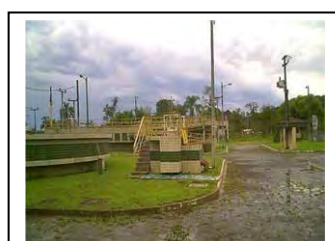
a. Guaraqueçaba Transformador Instalado em poste
