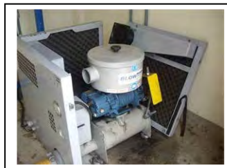
q. Morretes Aerador do tanque FAD
