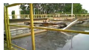
ae. Raspador de espuma do tanque de FAD de Atuba Sul
