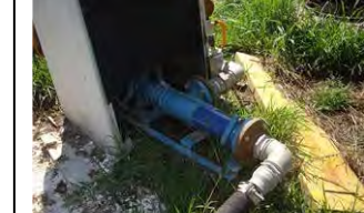
ag. CIC Xisto Bomba de inserção de lodo no desaguador centrífugo
