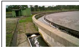
af. Bomba de retirada de lodo da ETE Belém
