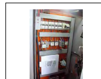
e. Painel de controle da bomba (2)
