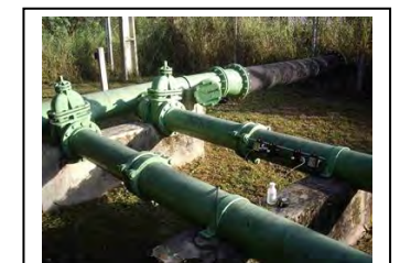
g. Tubulação de descarga da bomba (2)
