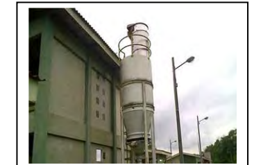
ab. Morretes Silo de armazenamento de cal hidratado da instalação de desaguamento do lodo
