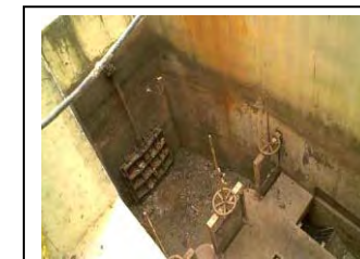
e. Padilha Sul Comporta de distribuição
