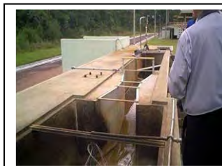
at. Matinhos Painel de controle medidor ultrassônico de nível de água
