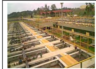
w. Padilha Sul UASB Dispositivo para queima de gás gerado
