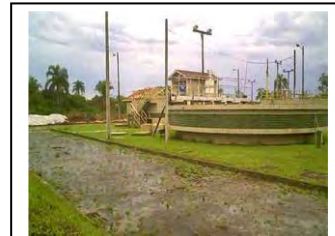
j. Guaraqueçaba Dispositivo para queima de gás gerado.
