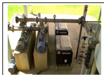
ac. Sao Jorge Tanque de ar
