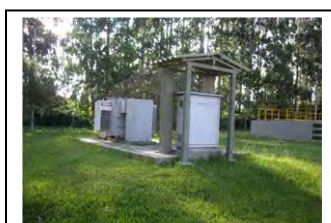
ba. Entrada de força e transformador da bomba de recalque de Atuba Sul
