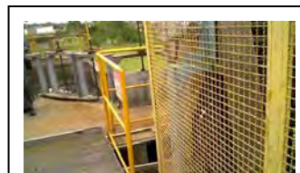
l. Comporta de distribuição (intermediária) de Atuba Sul
