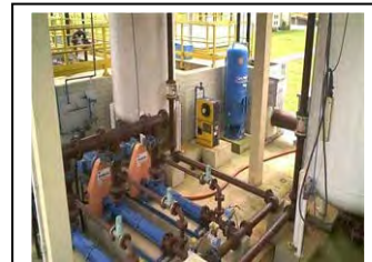
x. Compressor de ar de Pontal do Paraná
