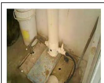
ad. Guaraqueçaba Dosador de cloreto para desinfecção.
