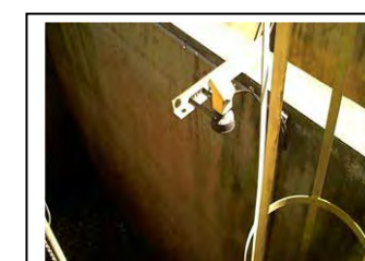
g. Sao Jorge Medidor ultrassônico do poço de bomba
