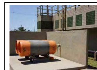
an. Guaratuba Equipamento de aplicação de gás cloro para desodorização de UASB
