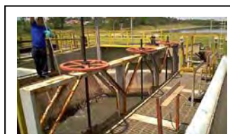
q. CIC Xisto Comporta de separação (do lado montante) e gradeamento fino
