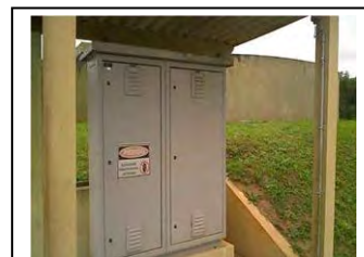
al. Painel de controle da instalação de desaguamento de Pontal do Paraná
