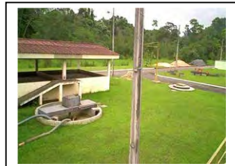
v. Morretes Raspador de lodo do tanque de adensamento do lodo
