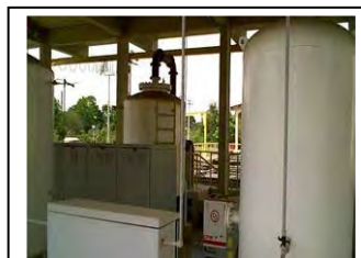
aj. Santa Quitéria Tanque de mistura água-ar
