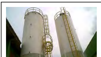
au. Silo para armazenamento de cal hidratada para lodo desidratado da ETE Belém
