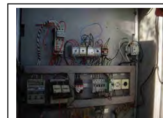
e. Painel de entrada de força
