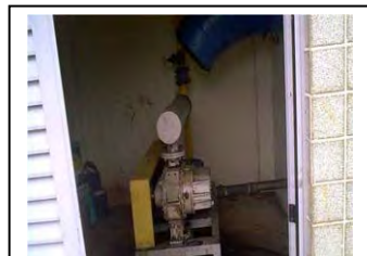
o. Guaraqueçaba Ventilador para fornecimento de ar.
