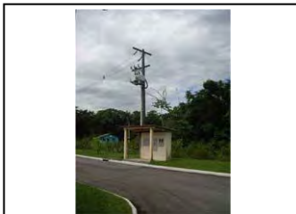
ak. Morretes Transformador instalado em poste
