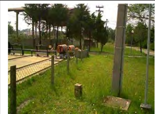
w. Santa Quitéria Instalação de aplicação do gás cloro para desodorização do UASB
