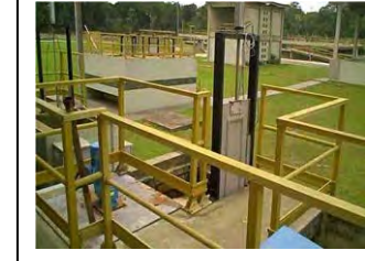
au. Comporta de entrada do tanque de mistura da instalação de FAD de Pontal do Paraná
