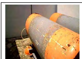
ad. Guaratuba Dosador de gás cloro para desinfecção.
