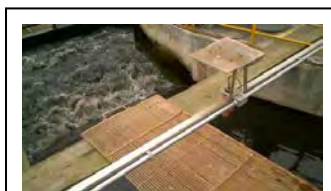
r. Medidor ultrassônico de nível do efluente do tanque de desaneração de Atuba Sul
