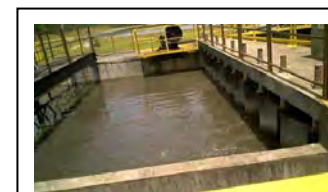
u. CIC Xisto Placa defletora para ordenamento do fluxo da entrada de primeiro tanque de adensamento
