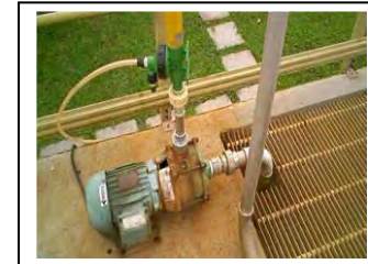
af. Morretes Bomba de pressão para água de cloro do tanque de confluência do efluente
