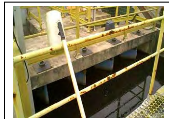
ax. Placas de ordenamento de fluxo de entrada do tanque de desaneração de Pontal do Paraná
