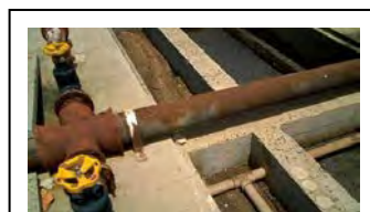
ac. CIC Xisto Tubulação do gás gerado
