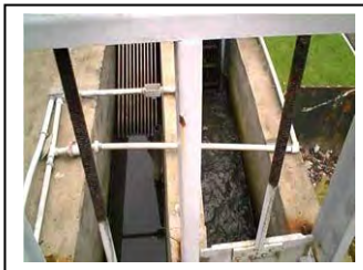
b. Morretes Interruptor de nível do canal de lançamento e gradeamento fino em barras
