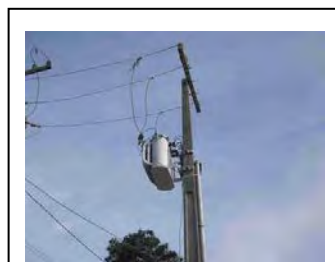
a. Transformador instalado em pose
