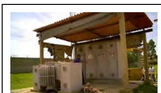
w. CIC Xisto Painel de controle do raspador de lodo do primeiro tanque de adensamento
