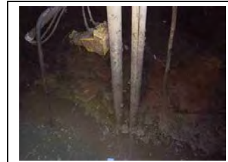
j. Bomba de retransmissão. (2)
