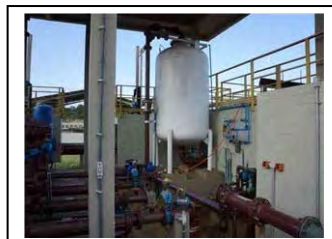
ac. Matinhos Tubulação de distribuição de volume de ar
