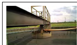
af. CIC Xisto Raspador de lodo do tanque de adensamento do lodo
