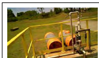
ae. CIC Xisto Bomba de pressão para água com cloro
