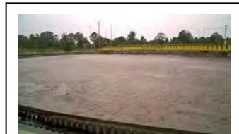
ac. Raspador de lodo do tanque de decantação final da ETE Belém
