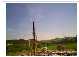
o. Sao Jorge Dispositivo para queima do gás gerado
