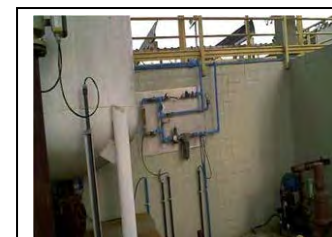
bc. Matinhos Tubulação de regulagem do volume ade ar
