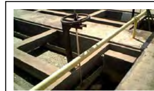
t. Fazenda Rio Grande Comporta de drenagem do lodo do tanque de reação do UASB
