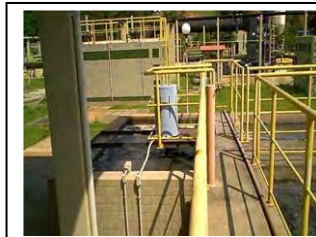
z. Santa Quitéria Comporta de distribuição
