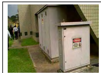
h. Padilha Sul Painel de controle de bomba elevatória
