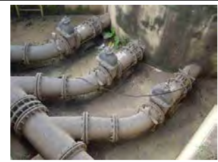
i. Válvula de retenção do tipo aleta, válvula de descarga, tubulação de descarga (1)
