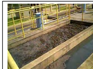
ae. Santa Quitéria Misturador do tanque de mistura de produtos químicos
