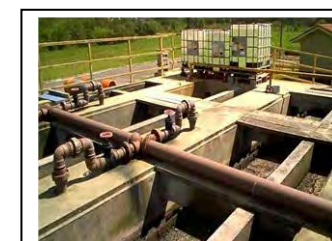
ai. Sao Jorge Dosador de peróxido de hidrogênio para desodorização do UASB
