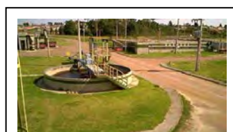
v. Fazenda Rio Grande Raspador de lodo do tanque de condensação do lodo.
