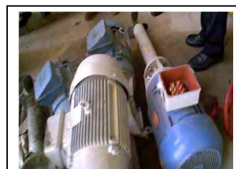
af. Guaratuba Aerador
