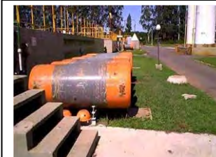
z. Equipamento de dosagem do gás cloro para desodorização da FAD de Atuba Sul
