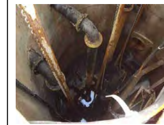
f. Bomba de retransmissão (1)
