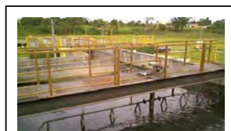
v. CIC Xisto Raspador de lodo do primeiro tanque de adensamento
