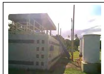
t. Matinhos Dosador de cloreto férrico (III)
