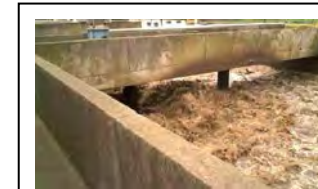
t. Equipamento de aeração da ETE Belém
