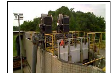
ai. Padilha Sul Removedor automático de detritos e comporta de separação
