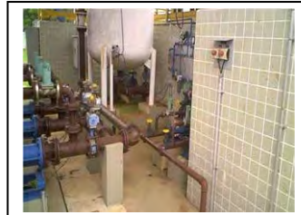
ar. Misturador água-ar da instalação de FAD de Pontal do Paraná
