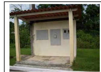
al. Morretes Painel de entrada e transformação de força
