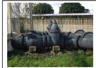
i. . Válvula de retenção, válvula de descarga e tubulação de descarga (2)
