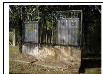
c. Cabine de entrada de força e painel de controle da bomba.
