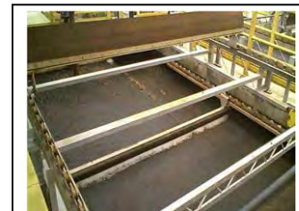
r. Raspador de espuma do tanque FAD de Pontal do Paraná
