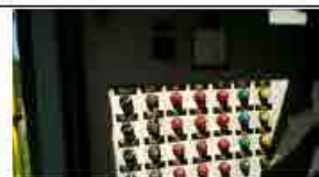
b. Painel de controle da comporta de entrada de Atuba Sul
