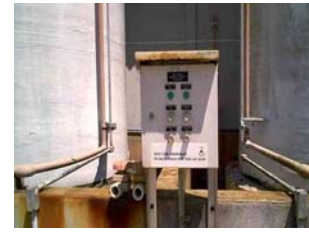
ci. Praia de Paine de controle de dosador de dióxido de cloro
