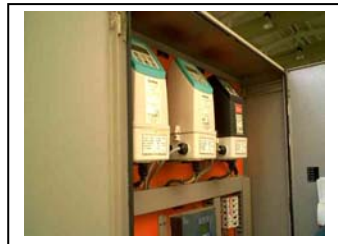
db. Painel de instrumentação de envio de água de Irai
