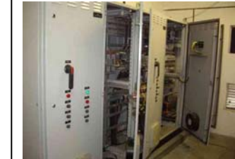
g. Praia de Leste Painel de controle da bomba de captação de água
