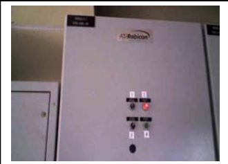
g. Painel de controle da bomba de captação de água de Iraí
