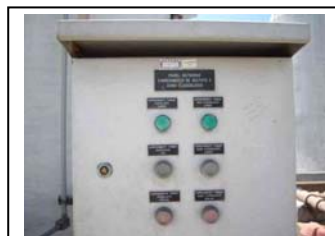
bz. Praia de Leste Painel de controle de dosador de fluoreto de hidrogênio
