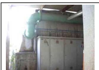
ad. Praia de Leste Pannel de controle do tanque de filtração
