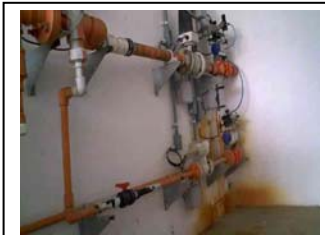
as. Praia de Leste Tubulação de dosagem de dióxido de cloro
