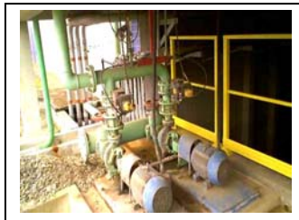
dg. Bomba de fornecimento interno de água de Irai
