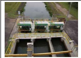
e. Painel de controle do removedor automático de detritos de Iraí
