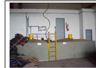
ek. Dosador de carvão ativado em pó do tipo umidificado em Irai
