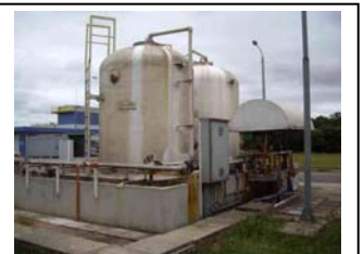
at. Tanque de armazenamento de hexafluorossilicato de hidrogênio de Irai
