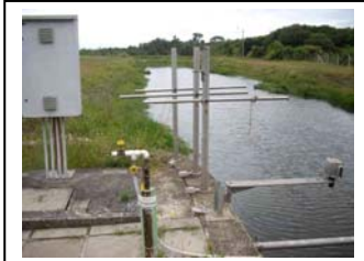
a. Medidor ultrassônico de nível de água da captação de Iraí
