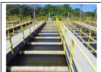
bt. Saiguaçu Placa de alta taxa do tanque de sedimentação química
