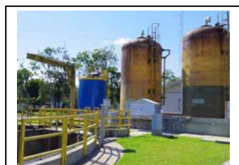
ax. Saiguaçu Tanque de armazenamento de solução de cal
