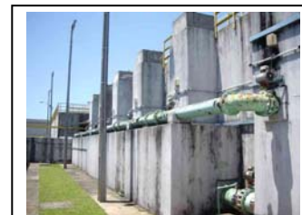
aa. Praia de Leste Válvula de retro lavagem do tanque de filtração
