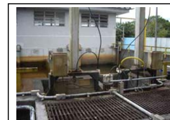
u. Praia de Leste Comporta de entrada de água drenada
