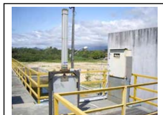
o. Praia de Leste Comporta de tanque de precipitação química
