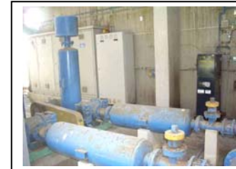
ab. Praia de Leste Instalação de limpeza por ar do tanque de filtração
