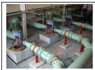
cq. Bomba de envio de água do sistema Cr Vila Amélia em Irai
