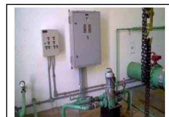
bc. Saiguaçu Bomba de envio de água para uso interno da ETA
