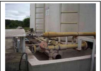
bg. Bomba para dosagem de hipoclorito de sódio em Irai
