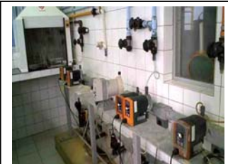
x. Guaraqueçaba Bomba dosadora de produtos químicos
