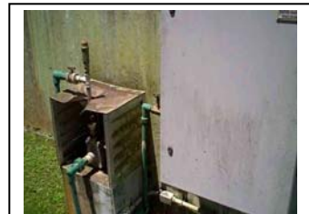
da. Praia de Leste Bomba de amostragem para dosagem de produtos químicos na adutora
