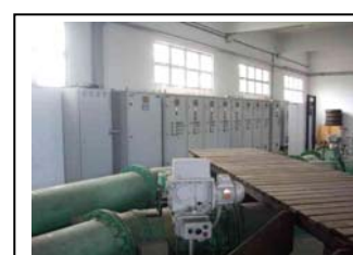
bk. Praia de Leste Painel de controle da bomba de transmissão de água
