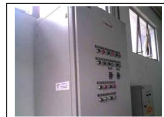
al. Painel de controle da água de drenagem de lavagem de Iraí
