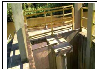
bo. Saiguaçu Comporta da entrada do tanque água bruta
