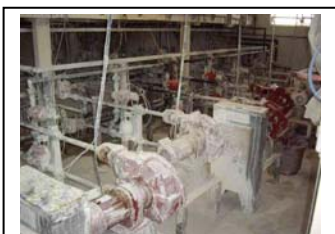
bt. Bomba de dosagem de cal em Irai
