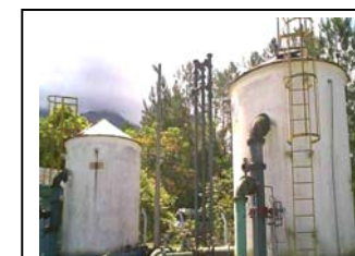
g. Morretes Tanque de filtração rápida de fluxo ascendente
