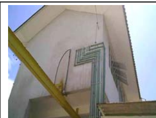
cx. Praia de Leste Tubulação de amostragem
