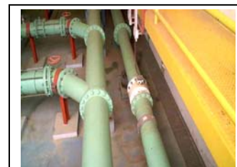
ep. Medidor eletromagnético da vazão de envio de água de Irai
