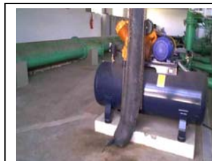
cz. Praia de Leste Compressor de ar para válvula da câmara de bomba
