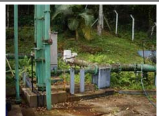
w. Guaraqueçaba Tubulação de tanque de filtração
