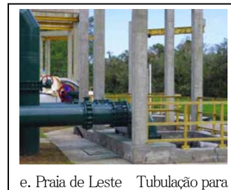
e. Praia de Leste Tubulação para drenagem da bomba de captação de água
