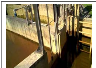
bs. Saiguaçu Medidor ultrassônico de nível do tanque de lodo
