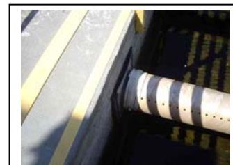
bt. Praia de Leste Cuba do tanque de sedimentação química
