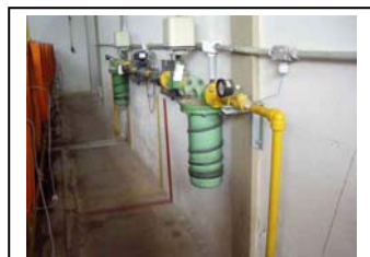
cg. Tubulação para dosagem de cloro em Irai
