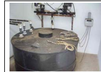
ej. Reator para geração de dióxido de cloro de Irai
