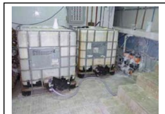
be. Praia de Leste Bomba de dosagem de cal
