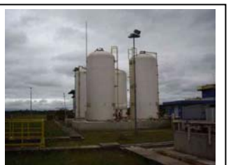
bd. Tanque de armazenamento de hipoclorito de sódio em Irai
