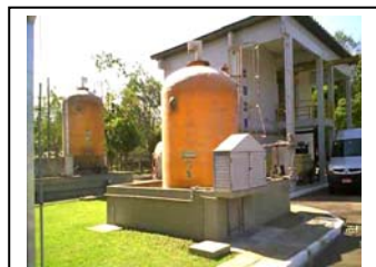
aq. Saiguaçu Tanque de armazenamento de fluoreto de hidrogênio
