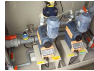
cj. Praia de Leste Instalação da bomba dosadora de ácido sulfúrico
