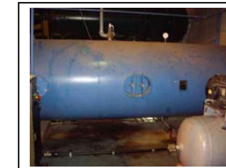
ab. Tanque de ar de Iraí
