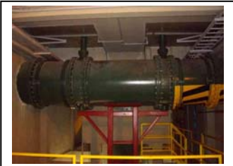
m. Válvula de entrada do tanque de floculação de Iraí
