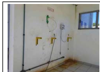
at. Saiguaçu Equipamento de dosagem de gás cloro
