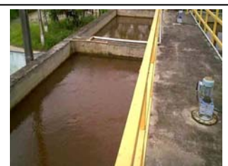
ay. Praia de Leste Tubulação de dosagem de polímero
