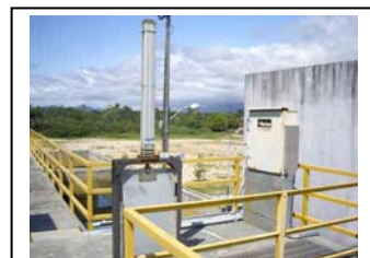
p. Praia de Leste Painel de controle de comporta
