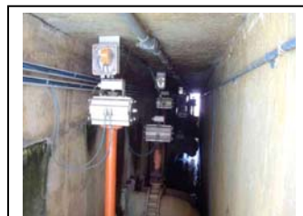
y. Praia de Leste Válvula de drenagem do tanque de água drenada
