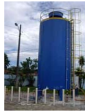
ch. Praia de Leste Instalação de bomba dosador de cal dissolvido
