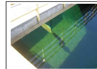
bp. Praia de Leste Misturador lento do tanque de floculação
