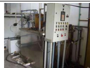
cw. Praia de Leste Paine de controle de dosador de polímero
