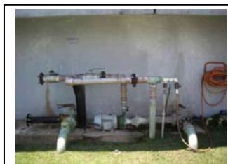
ba. Praia de Leste Instalação da bomba de cloro pressurizado
