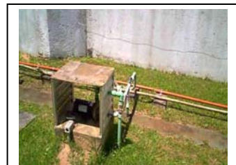
j. Praia de Leste Instalação de bomba de amostragem da água bruta
