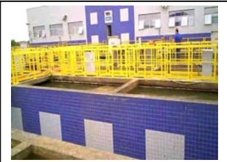
n. Misturador lento do tanque de floculação de Iraí
