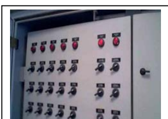
ak. Praia de Leste Placa analisador de qualidade de água
