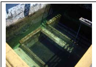
w. Praia de Leste interruptor de nível do tanque de filtração
