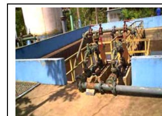
l. Morretes Tubo para retorno de água de lavagem drenada
