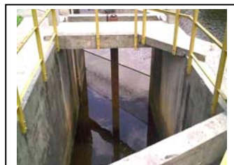
a. Praia de Leste Gradeamento de captação de água
