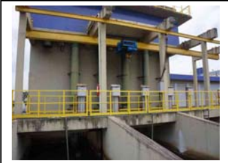
f. Bomba de captação de água de Iraí
