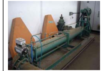
cm. Praia de Leste Bomba de transmissão de lodo
