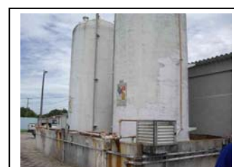
ao. Praia de Leste Tanque de armazenamento de ácido sulfúrico
