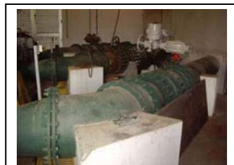
h. Praia de Leste Tubulação da bomba de transmissão de água bruta
