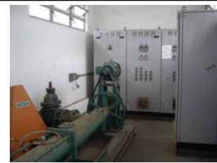
co. Praia de Leste Paine de controle da instalação do tanque de
