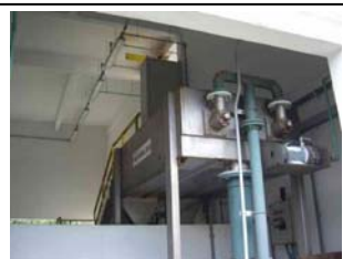
cu. Praia de Leste Misturador de lodo químico
