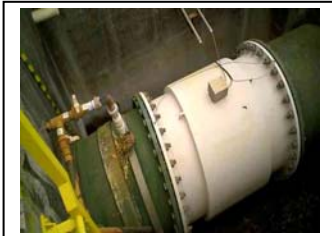
j. Medidor eletromagnético de vazão da captação de água de Iraí
