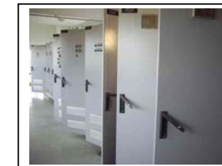
ai. Painel de controle da lavagem do tanque de filtração de Iraí
