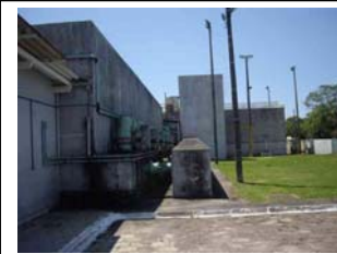
cq. Praia de Leste Válvula de retrolavagem do tanque de filtração
