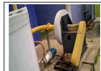
cl. Exaustor de gás neutralizado em Irai
