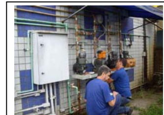
bq. Painel de controle do dosador de polímero em Irai
