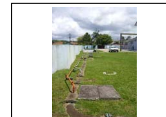
bx. Praia de Leste Tubulação para dosagem de sulfato
