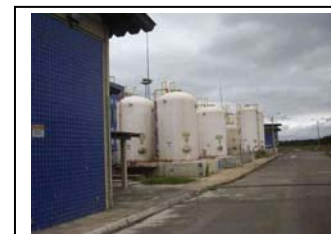
eq. Tanque para armazenamento de produtos químicos de Irai
