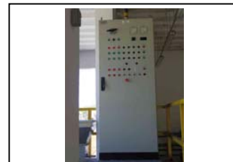
bj. Saiguaçu Painel de controle de desaguador centrífugo
