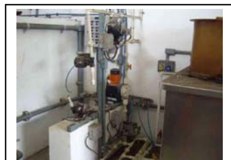
ax. Praia de Leste Instalação de bomba dosador de polímero
