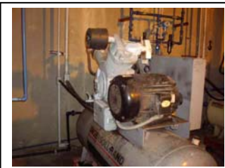
w. Compressor de ar para operação da comporta de Iraí
