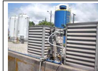
av. Praia de Leste Tubulação para fluoreto de hidrogênio
