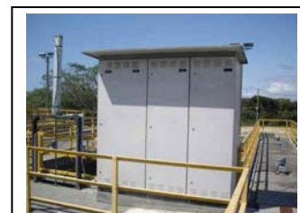
m. Praia de Leste Painel de controle do Misturador lento do tanque de floculação
