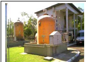
ar. Saiguaçu Instalação de bomba de dosagem de fluoreto de hidrogênio
