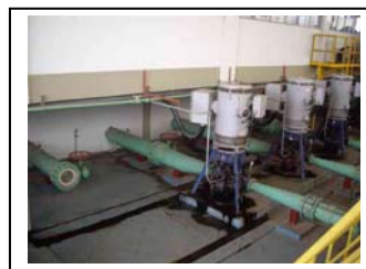
cr. Bomba de envio de água do sistema Piraquara em Irai
