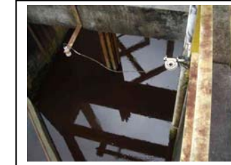
ce. Praia de Leste Medidor ultrassônico de nível de água de captação
