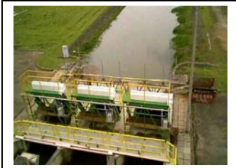
d. Removedor automático de detritos de Iraí
