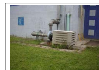
er. Bomba para pressurização do equipamento de água saturada de Irai
