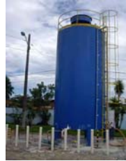
cg. Praia de Leste Tanque de armazenamento de cal dissolvido
