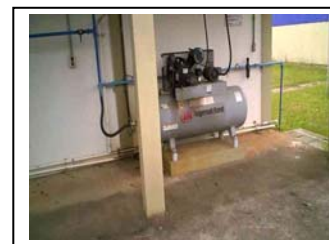
ct. Compressor de ar em Irai
