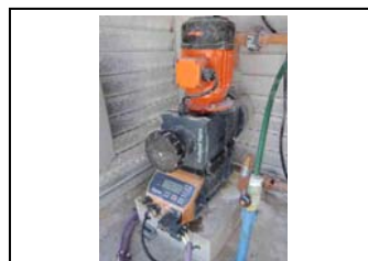
bv. Saiguaçu Bomba de dosagem de hipoclorito de sódio
