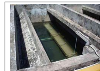
bu. Praia de Interruptor de nível do tanque de filtração
