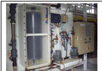
bm. Painel de controle do dosador de dióxido de cloro gerado em Irai
