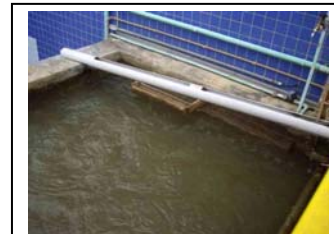
bp. Tubulação para dosagem de polímero em Irai
