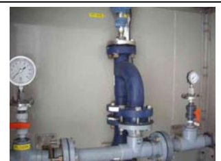
ar. Praia de Leste Reator de dióxido de cloro
