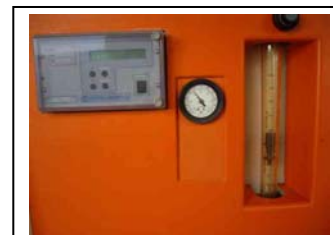
ce. Dosador de gás cloro em Irai
