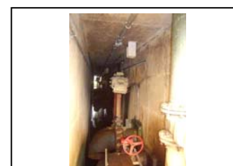
n. Praia de Leste Válvula de drenagem do tanque de floculação
