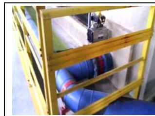
af. Válvula de retrolavagem do tanque de filtração de Iraí
