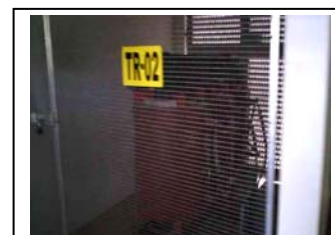
eo. Transformador da entrada de força da bomba de envio de água de Irai
