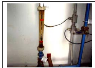
ac. Tubulação de regulagem do volume de ar de Iraí
