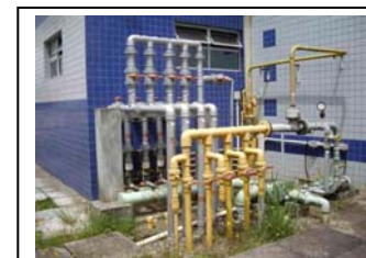
cf. Bomba de água pressurizada com cloro em Irai
