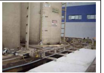
aw. Tubulação de dosagem de hexafluorossilicato de hidrogênio de Irai
