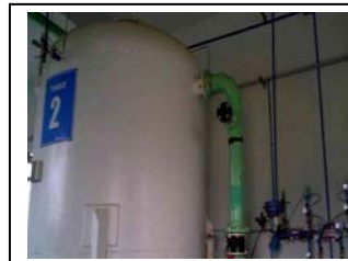
y. Tanque de mistura água-ar de Iraí
