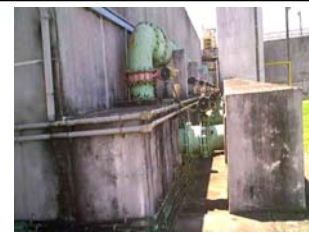
cp. Praia de Leste Válvula de saída do tanque de filtração
