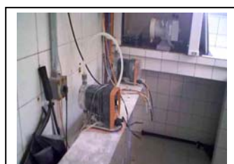
o. Morretes Bomba de dosagem de coagulante
