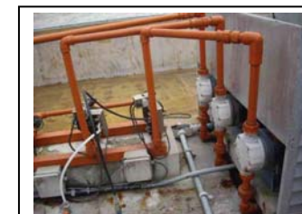
bw. Praia de Leste Bomba dosadora de sulfato
