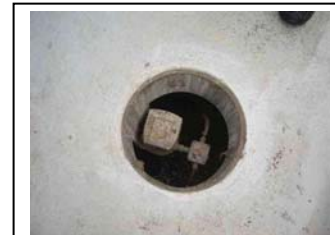
eh. Medidor ultrassônico de nível do poço para captação de água de Irai
