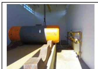
bu. Saiguaçu Instalação de dosagem de gás cloro
