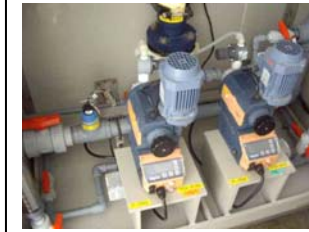
ck. Praia de Leste Bomba dosadora de hipoclorito de sódio
