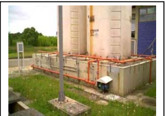
az. Bomba de fornecimento de ácido clorídrico do tanque de armazenamento de Irai
