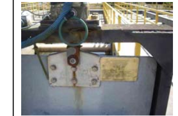
br. Praia de Leste Comporta da entrada do tanque de sedimentação química
