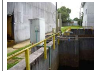
cs. Praia de Leste Medidor ultrassônico de nível to tanque de drenagem
