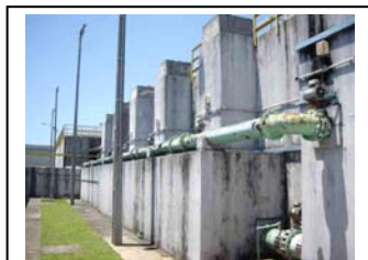
x. Praia de Leste Válvula de saída do tanque de filtração
