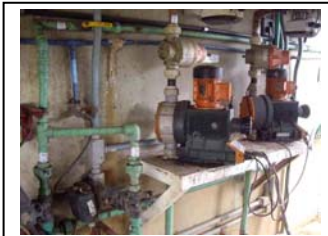
eg. Dosador de polímero para o desaguador de lodo de Irai
