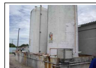
ap. Praia de Leste Silo de armazenamento de hipoclorito de sódio
