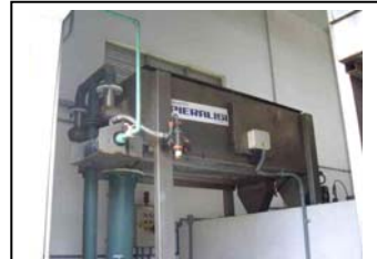
ct. Praia de Leste Misturador de produtos químicos no lodo
