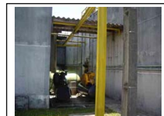
ca. Praia de Leste Compressor de ar para operação de comporta
