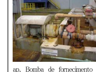
ap. Bomba de fornecimento de cloreto férrico (III) do tanque de armazenamento
