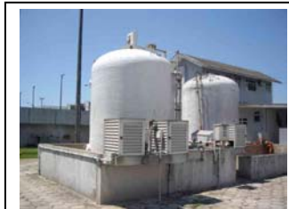
at. Praia de Leste Tanque de armazenamento de fluoreto de
