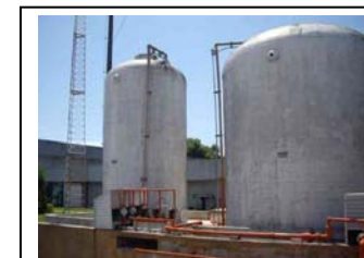
bv. Praia de Leste Tanque de dissolução sulfato de alumínio
