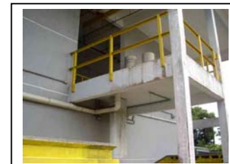
bn. Praia de Leste desaguidor centrifugo
