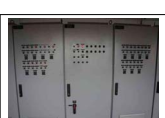
u. Painel de controle da instalação de tratamento de água de Iraí
