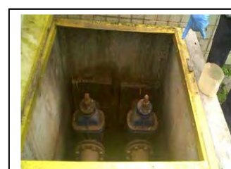
l. Morretes Válvula de retirada de lodo do tanque de reação UASB
