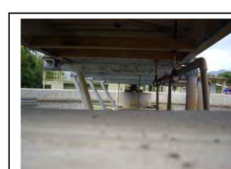
s. Morretes Raspador de lodo do tanque de adensamento final do lodo
