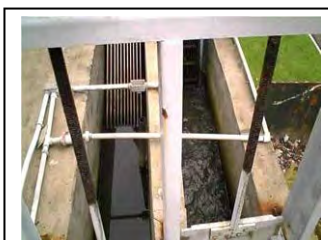
b. Morretes Interruptor de nível do canal de lançamento e gradeamento fino em barras
