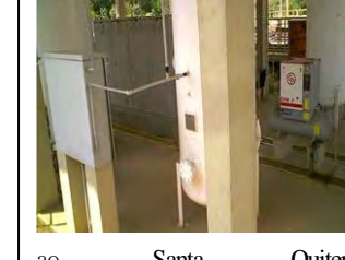
ao. Santa Quitéria Painel de controle do dispositivo de mistura água-ar
