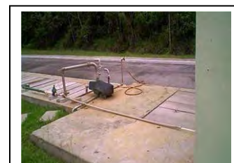
am. Bomba de água pressurizada com cloro de Pontal do Paraná
