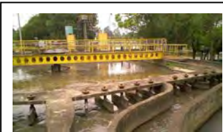
q. Removedor de lodo do tanque de desarenação da ETE Belém.
