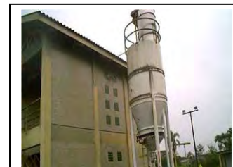
y. Guaraqueçaba Silo de armazenamento de cal hidratada.
