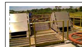
m. CIC Xisto Removedor automático de detritos e gradeamento grosseiro
