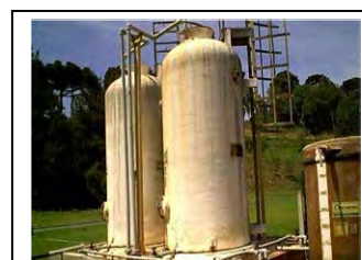
q. Sao Jorge Tanque de armazenamento de cloreto férrico (III)
