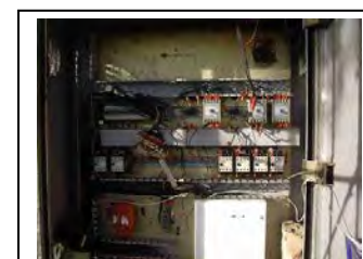
d. Painel de controle da bomba.
