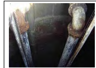
k. Bomba de retransmissão. (3)
