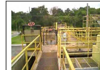
i. Comporta de separação de Pontal do Paraná (lado da jusante)
