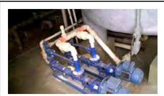
ar. Bomba de dosagem de polímero para desaguamento do lodo de Atuba Sul
