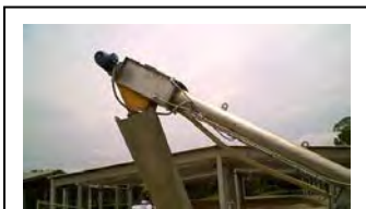
am. Condutor de espuma do tipo parafuso do tanque de equilíbrio de lodo adensado da ETE Belém
