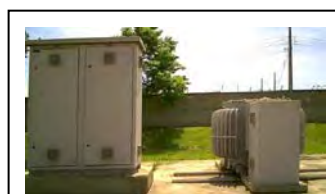
a. CIC Xisto Instalação de entrada de força
