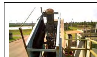
r. Fazenda Rio Grande Transportador de detritos.
