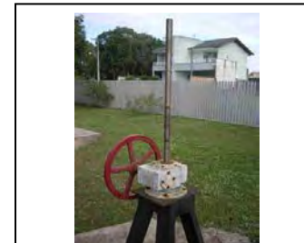
d. Válvula de abertura e fechamento da comporta de entrada
