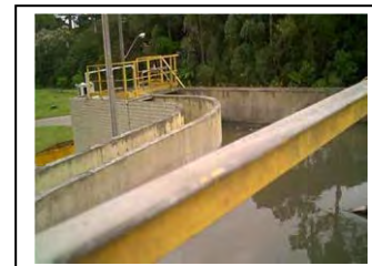
al. Padilha Sul Medidor ultrassônicos de nível de água
