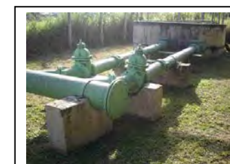
f. Tubulação de descarga da bomba (1)
