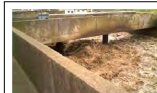
t. Equipamento de aeração da ETE Belém
