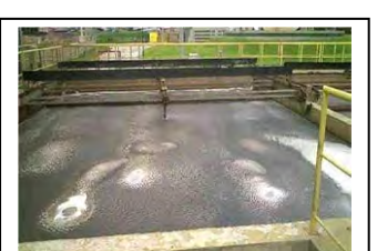
bj. Tanque da FAD de Atuba Sul
