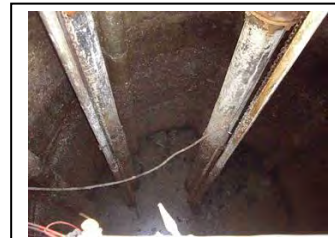
j. Bomba de retransmissão. (2)
