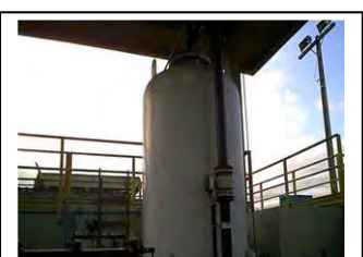
aa. Matinhos Tanque de mistura água-ar
