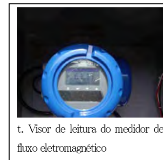
s. Visor de leitura do medidor de fluxo eletromagnético (1)
