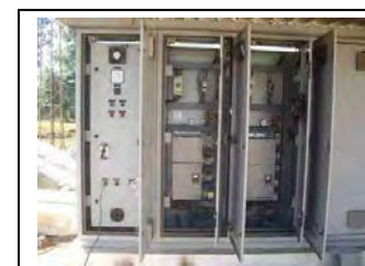
d. Painel de controle da bomba. (2)
