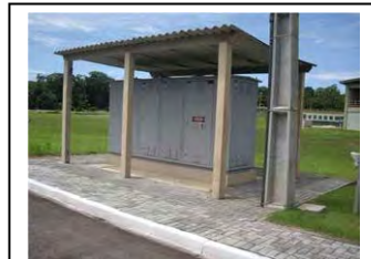
b. Gabinete da entrada de força de Pontal do Paraná
