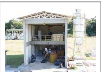
ao. Matinhos Compressor de ar
