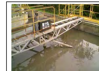
s. Padilha Sul Raspador de lodo
