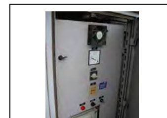
d. Painel de controle da bomba (2)
