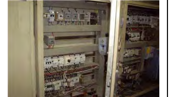
aw. Painel de controle do desaguador de lodo de Atuba Sul
