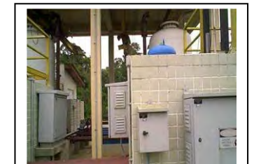
u. Painel de controle da instalação de FAD de Pontal do Paraná
