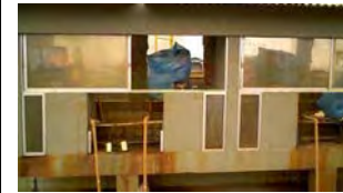
y. Equipamento de dosagem do cloreto férrico (III) da FAD de Atuba Sul
