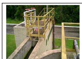
h. Morretes Medidor de nível ultrassônico de calha parcial
