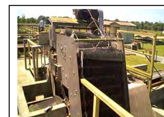
f. Guaratuba Removedor automático de detritos.
