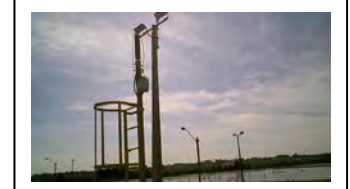
u. Fazenda Rio Grande Dispositivo para queima de gás gerado do tanque de reação do UASB
