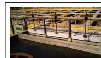
t. Comporta do distribuidor do UASB de Atuba Sul
