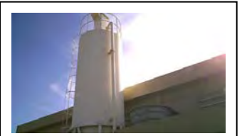
av. Silo de armazenamento de cal para ser misturada com lodo desaguado em Atuba Sul
