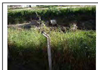
b. Cabo de eletricidade do detector de invasor
