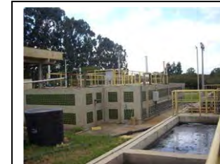
aa. Comporta de distribuição da FAD de Atuba Sul
