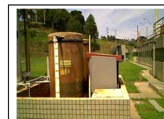
r. Sao Jorge Instalação para aplicação de cloreto férrico (III)
