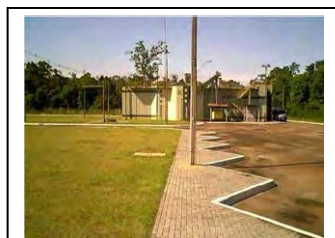
h. Matinhos Painel de controle de removedor automático de detritos
