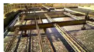
ad. Raspador de espuma do tanque de FAD de Atuba Sul
