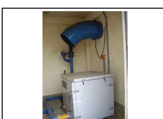
p. Morretes Ventilador para fornecimento de ar da sala de aerador do tanque FAD
