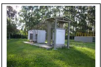
ba. Entrada de força e transformador da bomba de recalque de Atuba Sul
