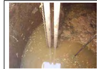
k. Bomba de retransmissão. (3)
