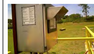
an. CIC Xisto Painel de controle de medidor ultrassônico de nível de água
