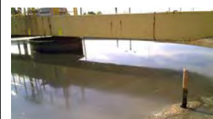
am. Removedor de lodo do tanque de adensamento de Atuba Sul
