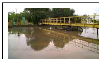
ah. Raspador de lodo do adensador de lodo da ETE Belém
