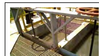
k. CIC Xisto Comporta de distribuição e gradeamento grosseiro
