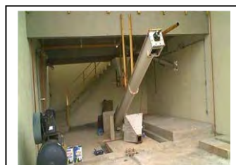
ak. Compressor de ar de Pontal do Paraná
