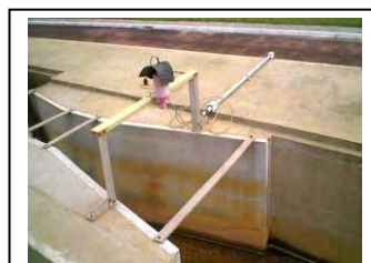
as. Matinhos Medidor ultrassônicos de nível de água
