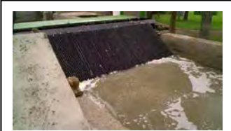
n. Gradeamento fino da ETE Belém (segunda fase)
