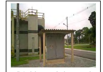
g. Painel de controle do removedor automático de detritos de Pontal do Paraná
