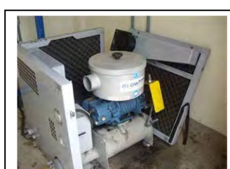
q. Morretes Aerador do tanque FAD
