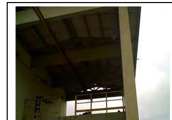
af. Desaguador centrífugo de lodo de Pontal do Paraná
