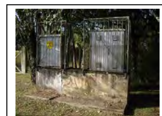
c. Cabine de entrada de força e painel de controle da bomba.
