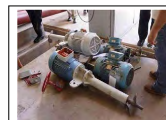
ap. Guaratuba Aerador
