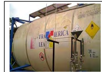
x. Padilha Sul Instalação de aplicação da água de peróxido de hidrogênio para desodorização do UASB
