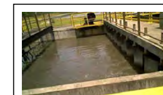
u. CIC Xisto Placa defletora para ordenamento do fluxo da entrada de primeiro tanque de adensamento
