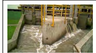
l. Comporta divisória (intermediária) da ETE Belém
