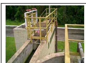
i. Morretes Comporta de distribuição
