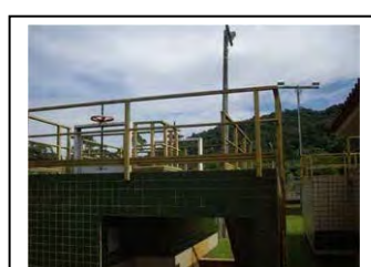
o. Morretes Válvula by-pass do tanque de distribuição FAD
