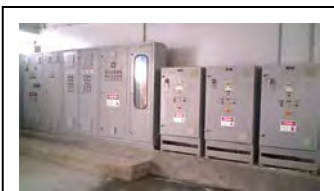
av. Painel de controle do desaguador de lodo da ETE Belém
