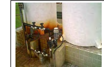
n. Bomba de dosagem do cloreto férrico de Pontal do Paraná
