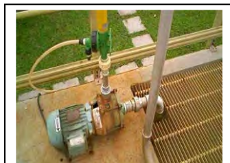
af. Morretes Bomba de pressão para água de cloro do tanque de confluência do efluente
