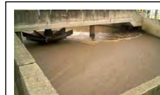
u. Equipamento de aeração da ETE Belém
