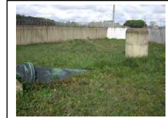
k. Tubulação de descarga (2)
