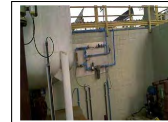
bc. Matinhos Tubulação de regulagem do volume ade ar
