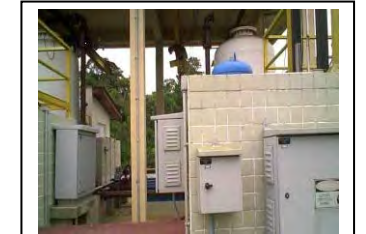
ab. Painel de controle da mistura de água-ar de Pontal do Paraná
