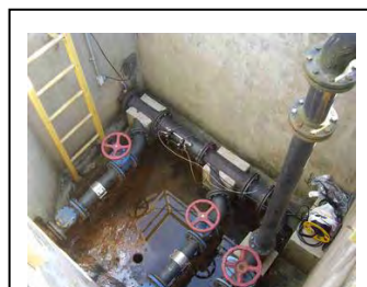
h. Tubulação de descarga, válvula de retenção e válvula de descarga (1)
