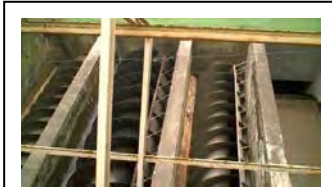
c. Bomba elevatória da ETE Belém
