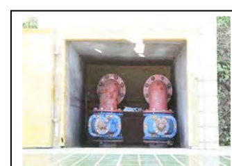
s. Guaratuba Válvula de drenagem do lodo.
