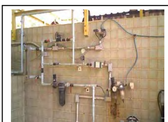
ad. Sao Jorge Tubulação de regulagem do volume de ar
