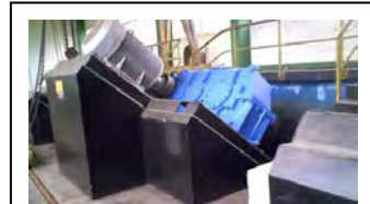
e. Redutor de velocidade da condução e motor elétrico da bomba elevatória da ETE Belém
