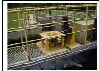
ay. Removedor de espuma do tanque de desaneração de Pontal do Paraná
