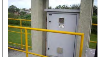
s. Painel de controle removedor de lodo do tanque de desaneração de Atuba Sul
