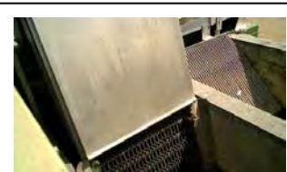
i. Fazenda Rio Grande Removedor automático de detritos e gradeamento fino
