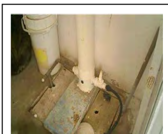
ad. Guaraqueçaba Dosador de cloreto para desinfecção.
