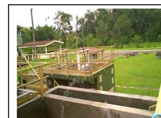
n. Morretes Comporta de distribuição do tanque de distribuição
