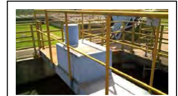
n. Fazenda Rio Grande Raspador de lodo do tanque de sedimentação inicial e placa defletora para ordenamento do fluxo.
