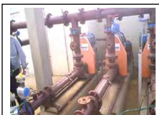
aw. Matinhos Bomba de água saturada
