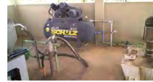
ae. Fazenda Rio Grande Compressor de ar.
