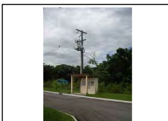
ak. Morretes Transformador instalado em poste
