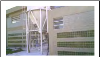
au. Silo de armazenamento de cal para ser misturada com lodo desaguado em Atuba Sul
