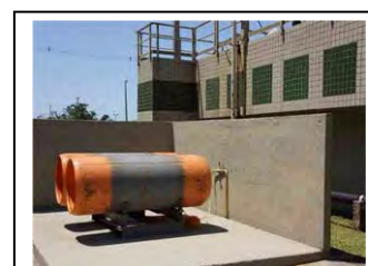
an. Guaratuba Equipamento de aplicação de gás cloro para desodorização de UASB
