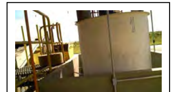
ab. Fazenda Rio Grande Instalação de dosador de polímero.
