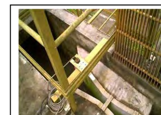
g. Guaraqueçaba Medidor ultrassônico de nível de água
