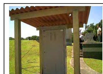
ag. Guaratuba Painel de controle de dosador de gás cloro.
