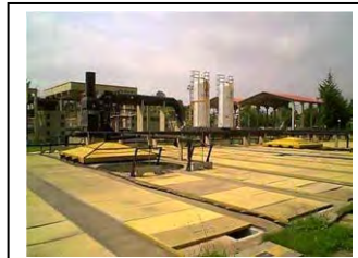
v. Santa Quitéria Dispositivo de neutralização do gás gerado
