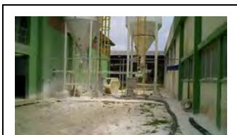
at. Silo para armazenamento de cal hidratada para lodo desidratado da ETE Belém
