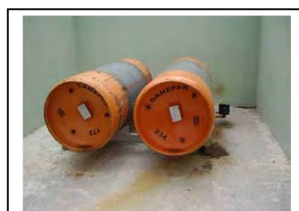
ah. Morretes Dosador de gás cloro para desinfecção
