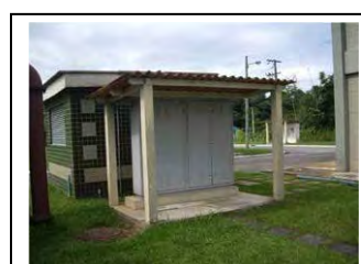
k. Morretes Painel de controle de compressor de ar
