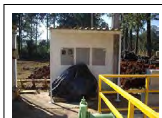
b. Cabine de entrada de força.
