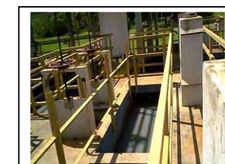
u. Sao Jorge Misturador do tanque de mistura de produtos químicos
