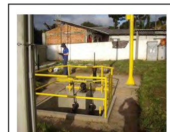
c. Bomba elevatória.
