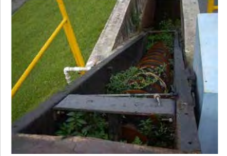
bf. Transportador tipo parafuso do tanque de desaneração de Atuba Sul
