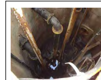
f. Bomba de retransmissão (1)
