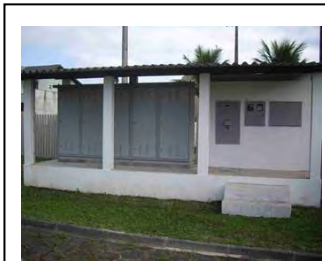
b. Cabine de entrada de força, painel de controle da bomba.
