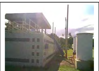
t. Matinhos Dosador de cloreto férrico (III)
