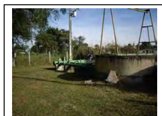
a. Transformador instalado em poste e instalação de bomba.
