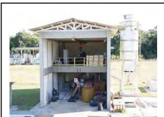
an. Matinhos Silo de armazenamento de cal hidratado
