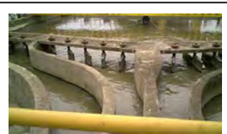
p. Placas defletoras de fluxo do tanque de desarenação da ETE Belém.
