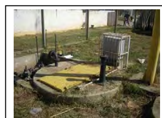
b. Instalação de bomba, Caixa de junção.
