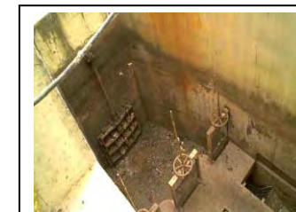
e. Padilha Sul Comporta de distribuição
