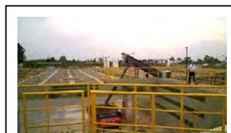
q. Transportador tipo parafuso de detritos do tanque de desaneração de Atuba Sul
