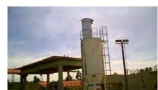
ak. CIC Xisto Silo de armazenamento de cal hidratado
