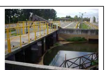
bd. Placas de ordenamento de fluxo da entrada do desanador de Atuba Sul
