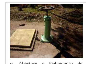
g. Abertura e fechamento da válvula de entrada.
