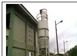
ab. Morretes Silo de armazenamento de cal hidratado da instalação de desaguamento do lodo
