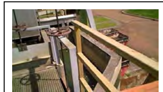
h. Fazenda Rio Grande Gradeamento fino e comporta de distribuição
