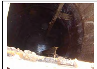
i. Bomba de retransmissão. (1)
