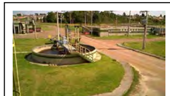
v. Fazenda Rio Grande Raspador de lodo do tanque de condensação do lodo.
