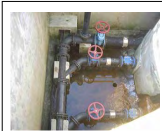
i. Tubulação de descarga, válvula de retenção e válvula de descarga (2)
