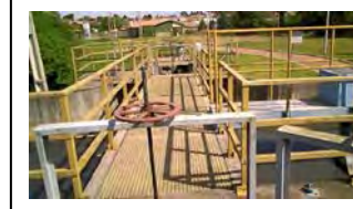
s. Fazenda Rio Grande Comporta de separação do desanador. (Comporta dos fundos)
