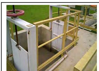
ad. Morretes Comporta de separação do tanque de confluência do efluente
