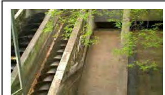
d. Bomba elevatória da ETE Belém
