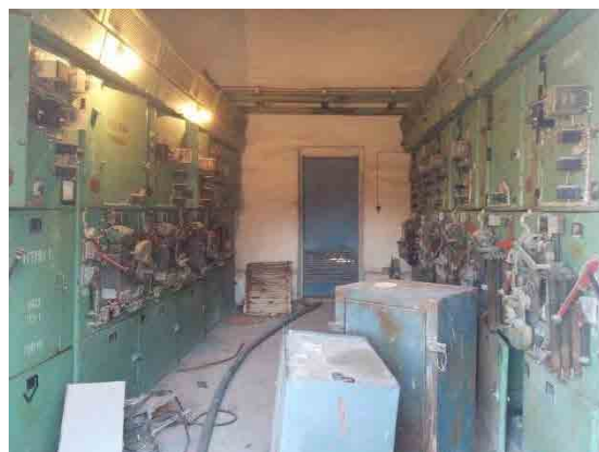
変電設備 (2015年3月9日)
