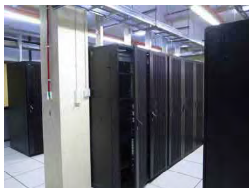
写真 10：データセンター (一例)
