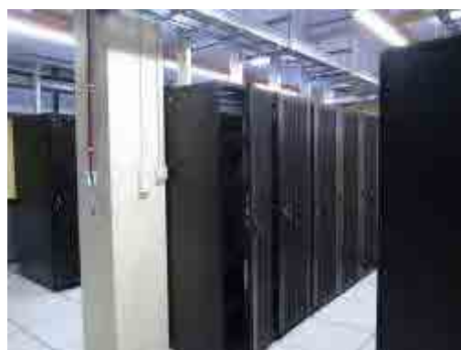
写真 10：データセンター (一例)
