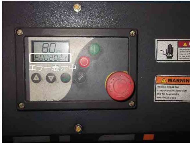
図 3-25 コンプレッサーの操作パネル（エラーが表示されている）
