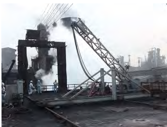
コークス炉屋上に設置した耐熱カメラ
