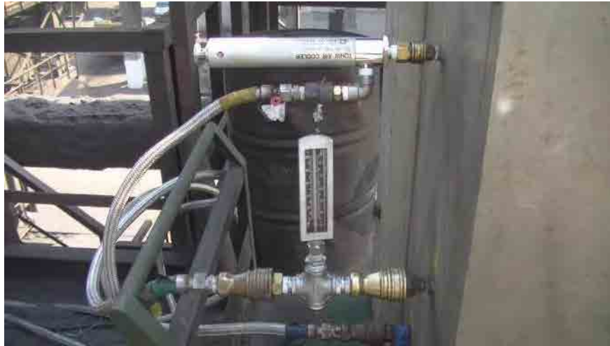
図 3-10 上段の配管にエアークーラーが設置されている
