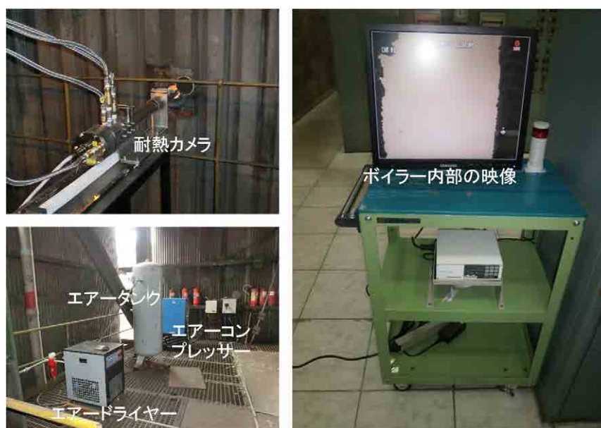
図 3-18 試験運用（左上はカメラ挿入模様、左下はエアコンプレッサーとタンク、右はモニターに映し出された炉内の映像）
