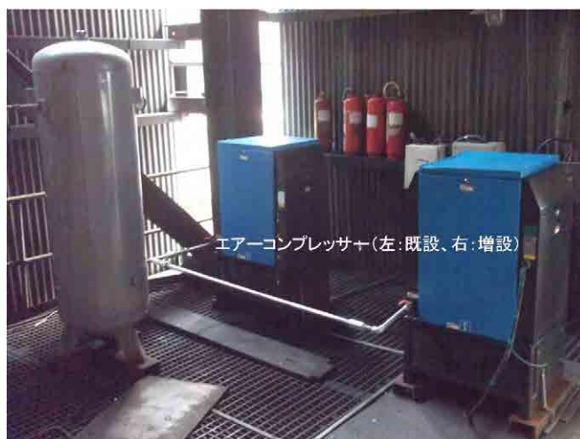
図 3-21 増設して2台並行運転となったコンプレッサー
