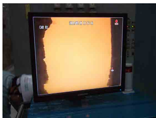
撮影された炎の映像 (監視室)
