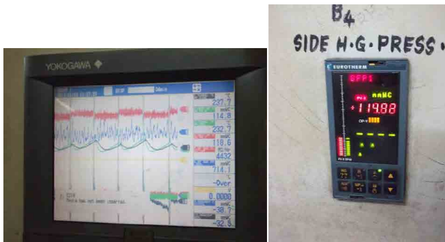
図 3-37 コークス炉 BFG 制御パネル（左：モニター、右：コントローラー）
