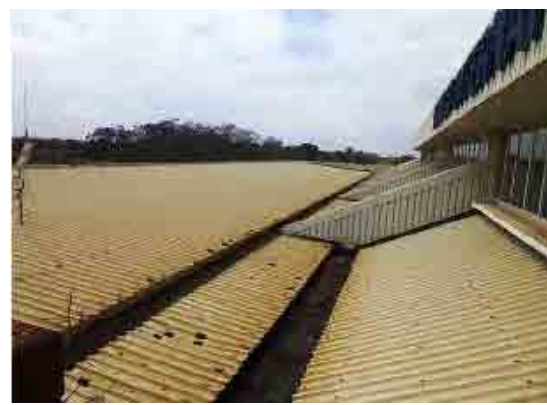
写真10 屋根の状況 老朽化が著しく雨漏りが発生している
