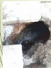
DMA Riviera. Gambar temuan lokasi bocor
