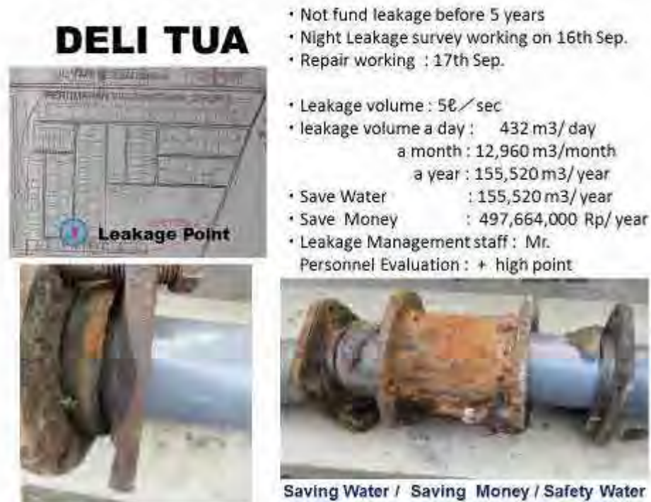
図 3-39 Delitua 支所 Bersaudara 地区 漏水状況
