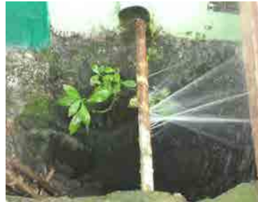
図 3-19 Bukit Johor Mas 地区,給水管からの漏水
