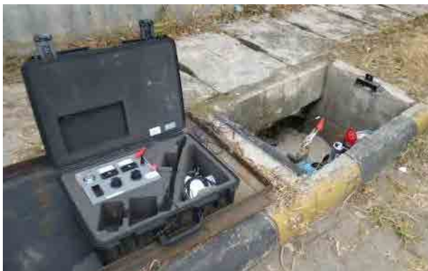
図 3-48 Waikiki 地区 AS610+D305 設置状況
