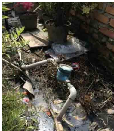
図 3-23 Medan Labuhan Kpum 地区、メーター継手部からの漏水
