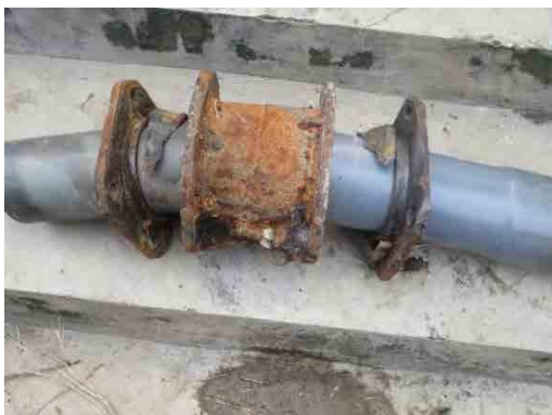
DELI TUA 地区で検出された配水管漏水箇所 (2014年9月8日)
