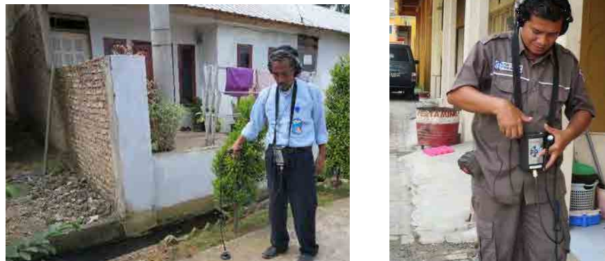
図 3-5 D305 で絞り込みポケットフォンで漏水地点を検出
