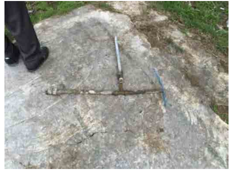
図 3-64 Komp Minimalis 地区 検出された違法接続管
