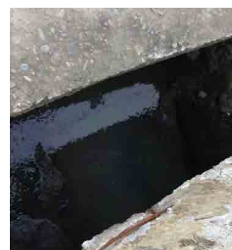
図 3-37 Tutup Nati 地区漏水現場
