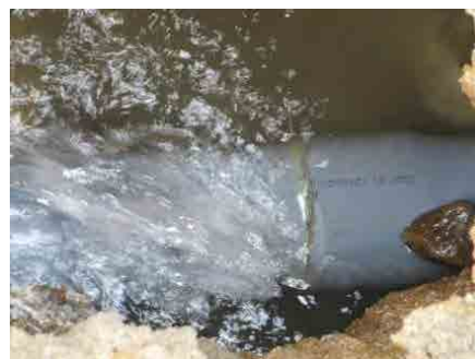
図 3-7 口径 3 インチ PVC 管ソケット 部からの漏水
