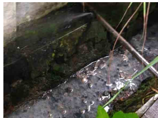
給水管からの漏水 (2014年9月16日)
