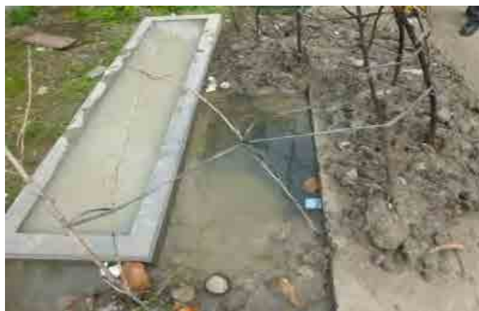
図 3-15 Cemara Hijau の漏水
