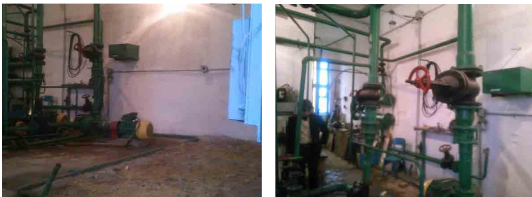
図6 ボイラーハウス内 （左：実証機設置位置、右：温水供給配管）
