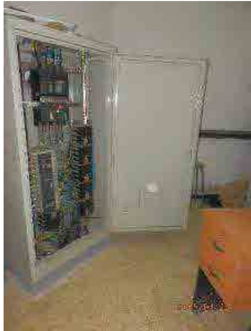
施設内電気系統設備
