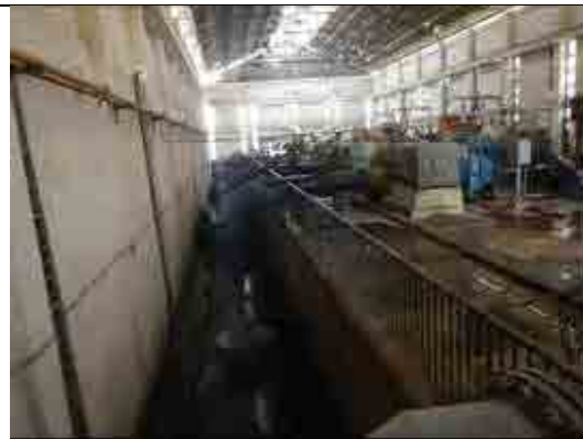
写真-10 配水ポンプ 配水ポンプが配水池(写真左)の低水位より高く設置されているため、配水池容量の半量が有効利用できない状況にある。
