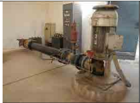
写真-2 取水ポンプ
