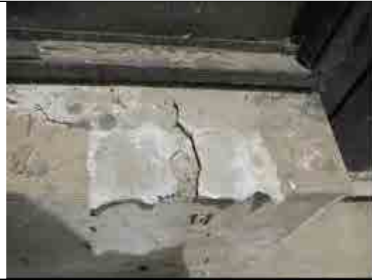
写真-8 最終配水場ポンプ棟 ポンプ棟は、建設後 20 年以上が経過し、屋根材であるアスベスト形成板が剥落している状況である。
