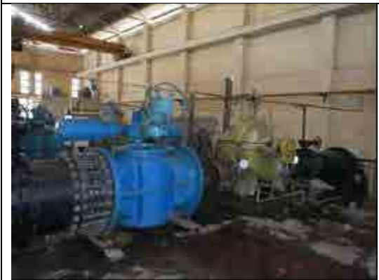
写真-9 配水ポンプ 最終配水場ポンプ棟内。日本製の配水ポンプが 10 台設置されており、本施設を介して市街地への給水を行う。配水ポンプは 20 年以上使用されており、故障や不具合が見られる。
