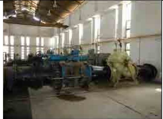
写真-4 増圧ポンプ
