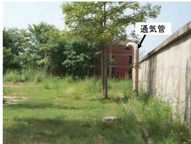
図 2.11 連絡管に設けられた通気管
