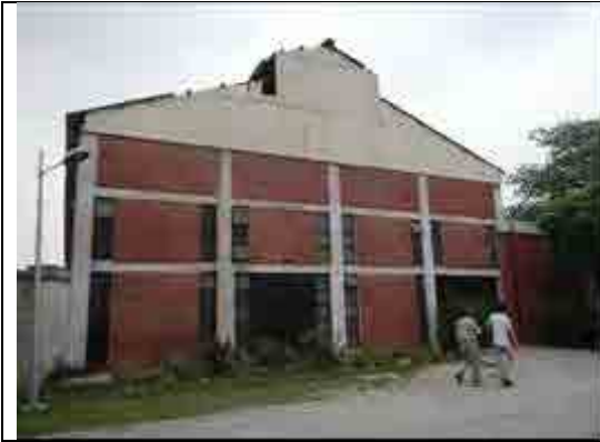
写真-7 最終配水場ポンプ棟 最終配水池に隣接して建設されているポンプ棟。1991年にADBにより建設された建物で、壁はレンガ積み構造、屋根はアスベスト形成板が採用されている。施設全体の老朽化が目立つ。
