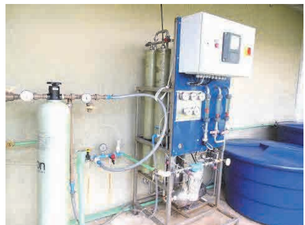
Araucaria Industrial WTP に設置した工業用水の RO 処理の実験プラント。日東電工、栗田工業等の膜を使用。今後、経済性の検証等を実施。
