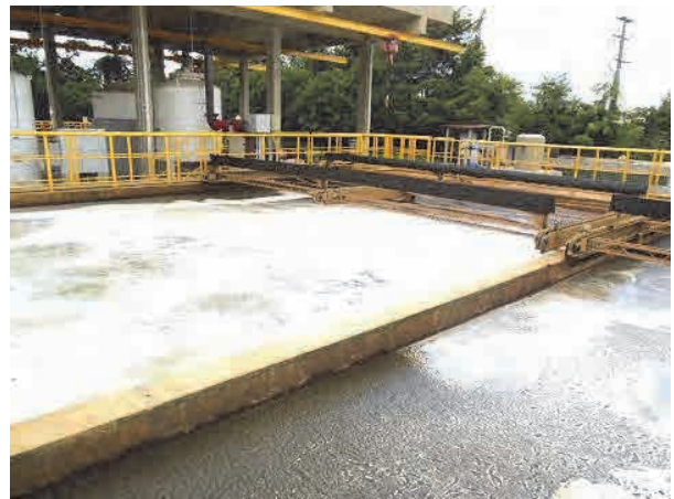
同右の浮上分離槽。フロック形成池とスカムスキマの改良をプロジェクトにて助言し改造中。大型 DAF ポンプの設置が期待されている。
