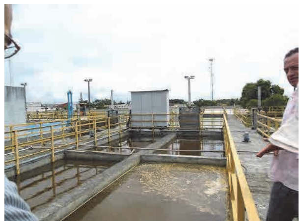
沿岸部 Praia de Leste 浄水場 (WTP)。処理水量約 52,000t/日。色度が高く運転が難しいが、マイクロサンドを使用し改善。沿岸部の中心的 WTP。
