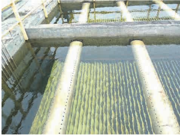
Praia de Leste WTP の傾斜板沈澱池。処理水は運転管理目標値（濁度 1 度など）を常時ほぼ達成している。上部の多孔管からろ過池へ流出。
