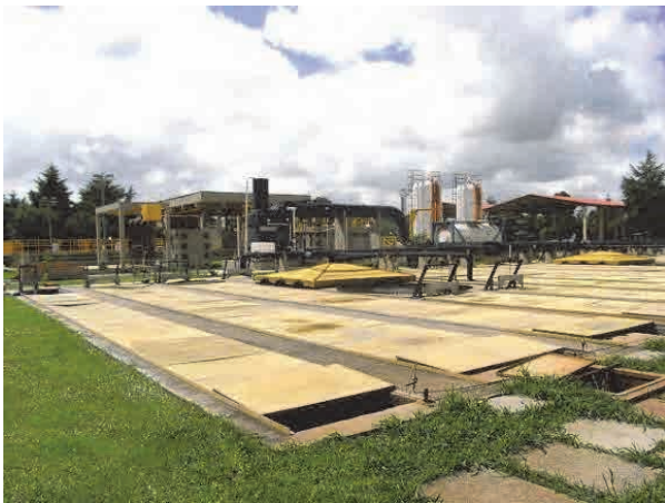
クリチバ首都圏の Santa Quiteria STP。処理水量約 43,000t/日。UASB+浮上分離+消毒。市街地の中にあるため、将来は廃止する方向。
