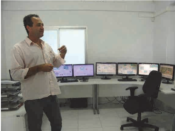
沿岸部の管理事務所の中央監視制御室。ダム管理から5カ所の浄水場及び3カ所の下水処理場の運転までを集中管理している。
