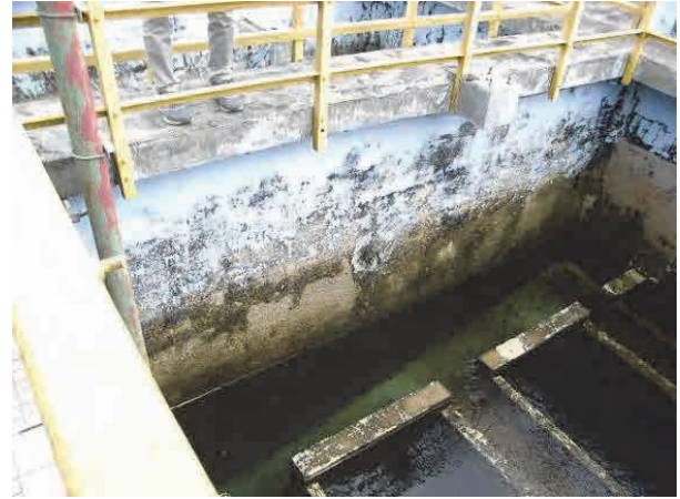
同右のろ過池。槽内のペンキ塗装ははがれたままの状態。アルカリによるコンクリートの腐食（骨材の露出）も見られ、早期の補修が必要。
