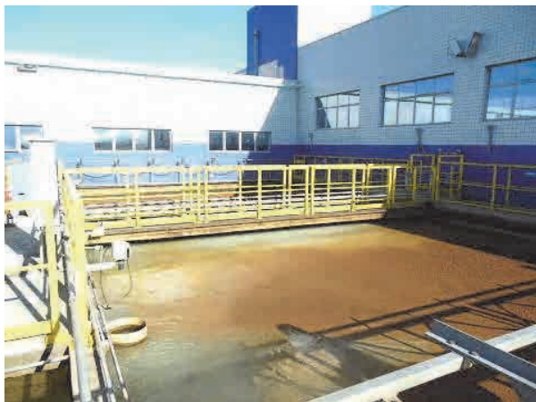
クリチバ首都圏の Irai WTP。浮上分離兼ろ過池の状況。浮上分離のためのマイクロバブル発生のための大型 DAF ポンプの設置が期待される。
