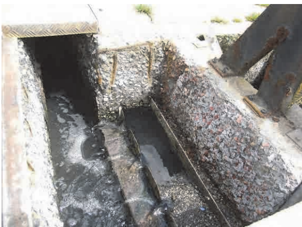
UASB 槽の腐食状況。臭気対策のため、カバーがあるので、硫化水素によるコンクリート躯体の腐食が著しい。断面修復と防食塗装が必要。
