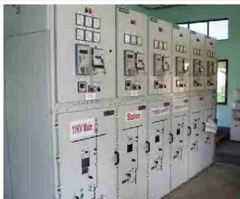
33/11kV Chi Pa SS (11kV)
