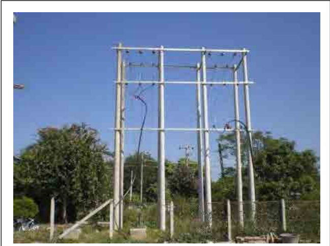
Bhamo S/S 11kV Feeder
