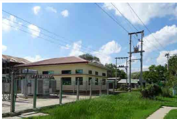
33/11kV 59 street SS(10MVA×1No.)
