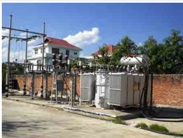
33/11kV 65St SS (10MVA×1No.)
