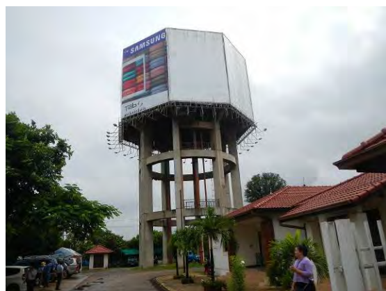
ポンタン (Phonethan) 高架水槽
