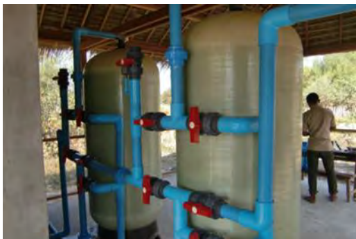
写真 2-4-2 パイロット給水システム
