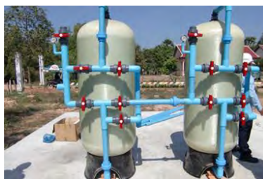
写真 2-3-8 FRP製タンク
