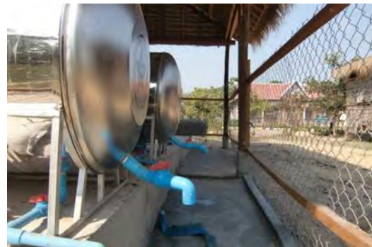
写真 2-4-3 パイロット給水システム
