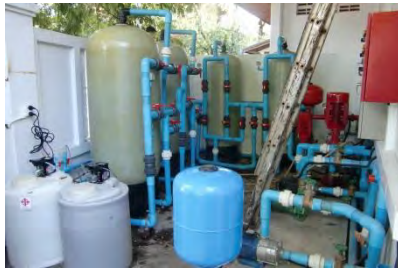
写真 2-1-3 ホテル水処理
