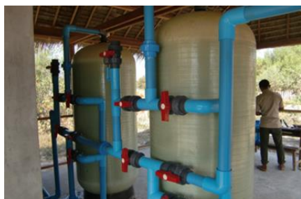
写真 2-4 パイロット給水システム
