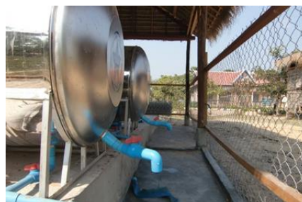
写真 2-5 パイロット給水システム
