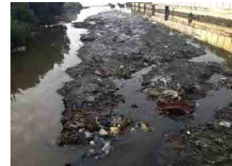
汚泥物で詰まった水路
