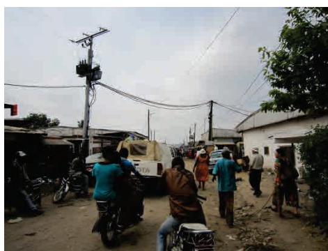
図 3-26 : ユプウエ地区内の柱上トランス
