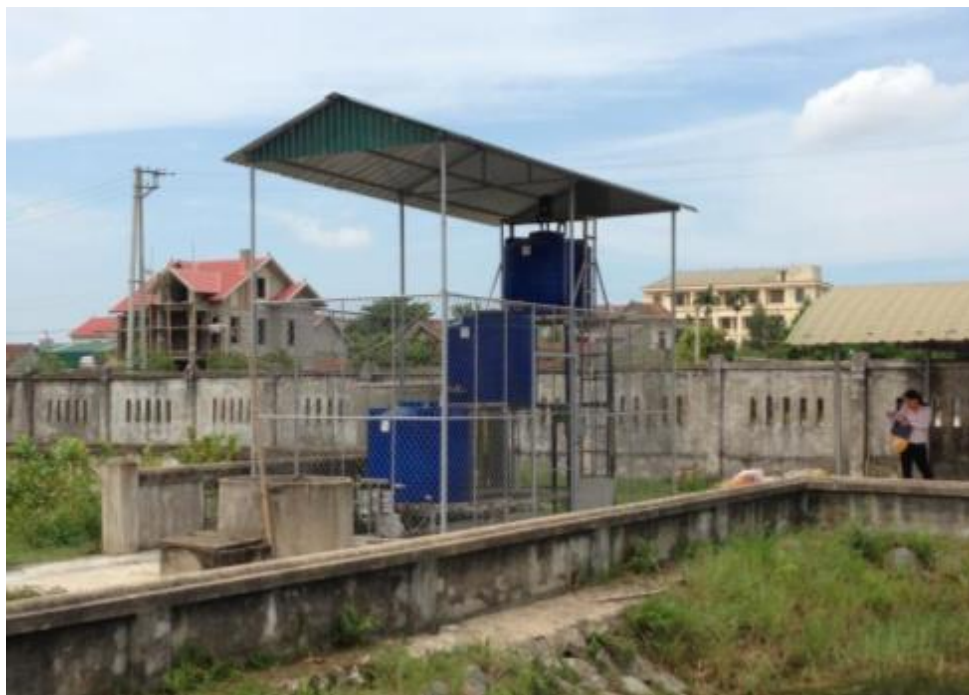
図 3-1 案件化調査時導入設備
