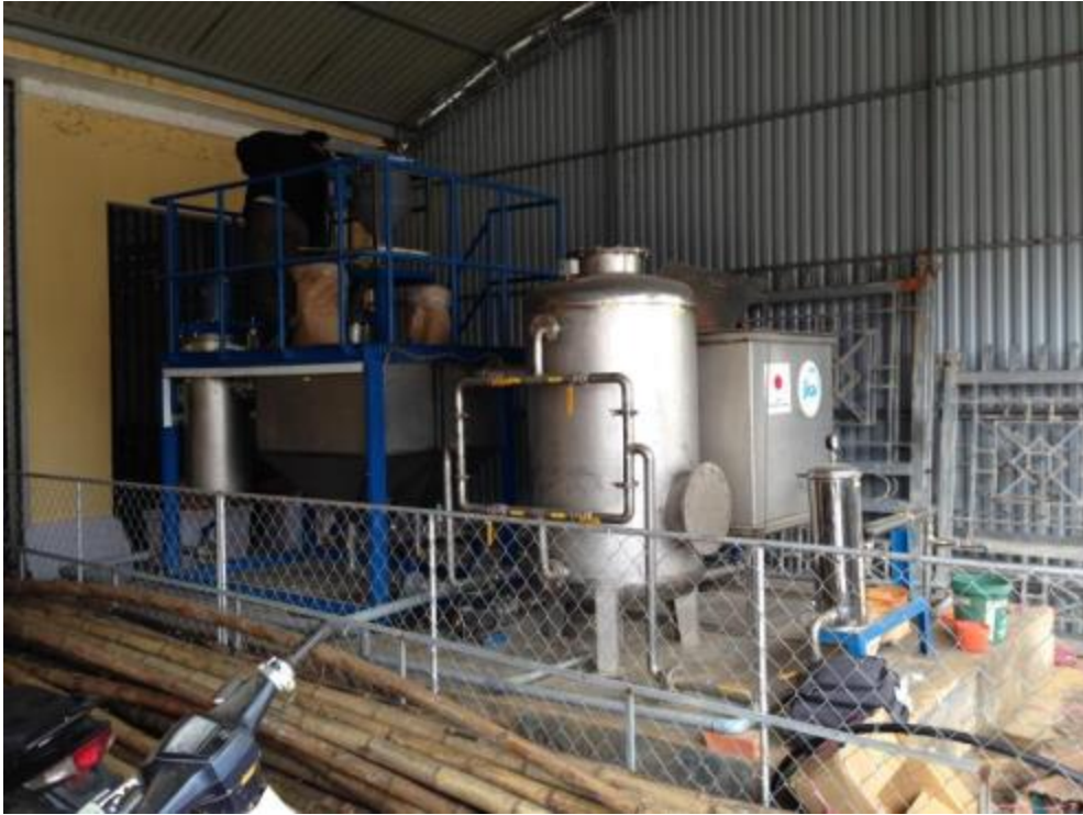
図 3-6 浄水設備 (大型 : 5,000ℓ/時間)
