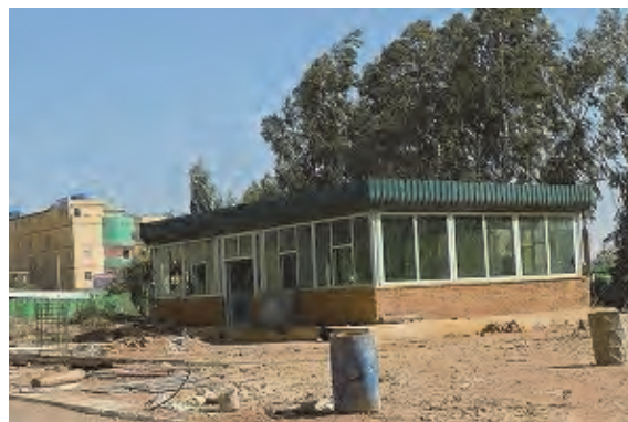
□建設用地内既存カフェテリアの様子 内部は破損し全体に損傷激しい。本計画の実施前に、スーダン側により解体撤去される。
