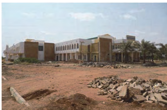
□既存総合病院棟の様子（2014年8月） 2013年11月開始の工事は2014年7月より停止中。基礎、躯体、設備配管等大規模改修が必要。
