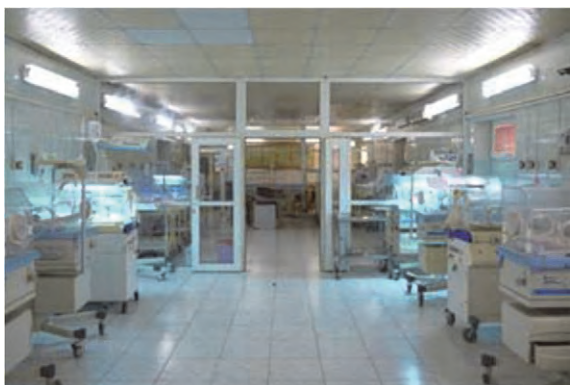
□オンドウルマン母子病院 NICU 多数の閉鎖型保育器、コットが配備され、迅速な診断・治療が行える体制が整っている。医療ガスの配管設備有り。
