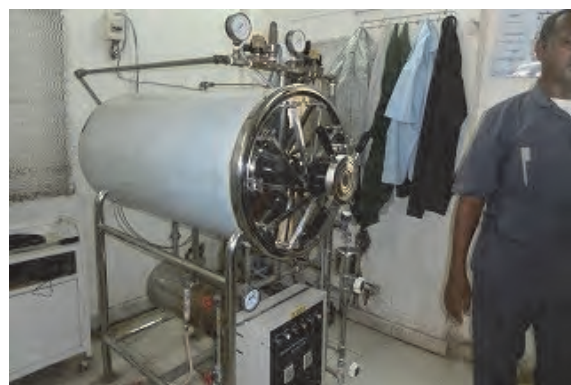
□高圧蒸気滅菌器（オンドゥルマン母子病院、滅菌室） 60L用の高圧蒸気滅菌器（横型タイプ）。手術着の滅菌に用いられる。
