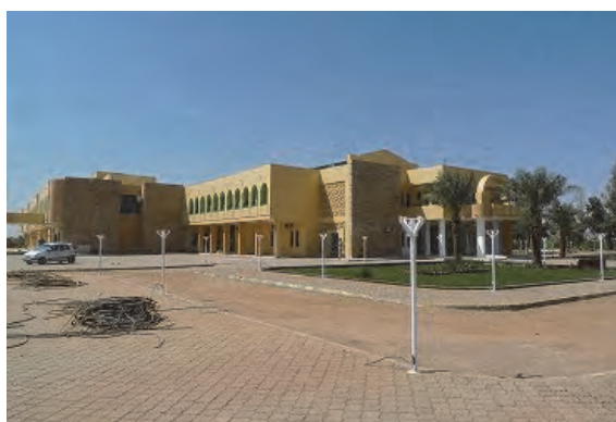
□既存総合病院棟の様子（2015年2月） 2階建、延床約7,100㎡。2015年2月現在も改修工事中で外装はほぼ完了。今後、3月に機材搬入据付の予定。
