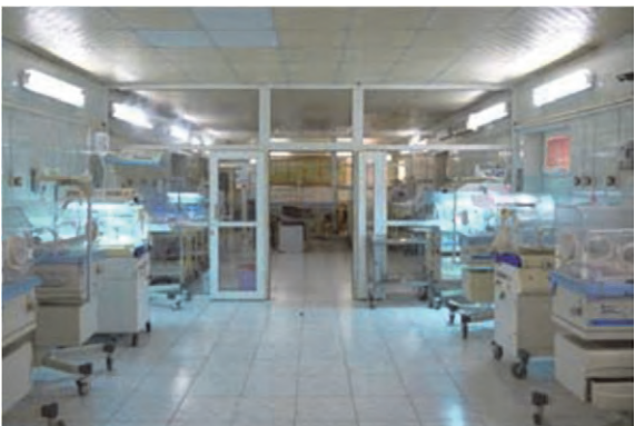
□オンドウルマン母子病院 NICU 多数の閉鎖型保育器、コットが配備され、迅速な診断・治療が行える体制が整っている。医療ガスの配管設備有り。
