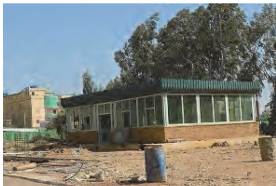
□建設用地内既存カフェテリアの様子 内部は破損し全体に損傷激しい。本計画の実施前に、スーダン側により解体撤去される。
