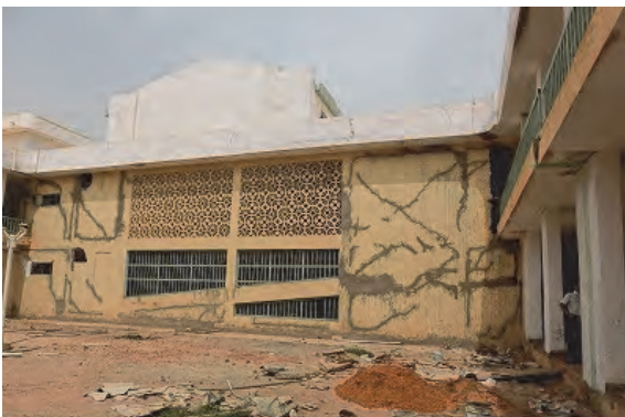
□既存総合病院棟の改修前の様子 弱い地盤の影響で基礎が不同沈下し、建物の至る個所に深刻なクラックが発生。
