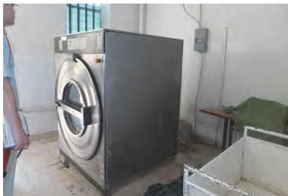
□洗濯機（オンドゥルマン母子病院、サービス部門） 30L用の業務用洗濯機。シーツなど寝具類の洗濯に用いられる。
