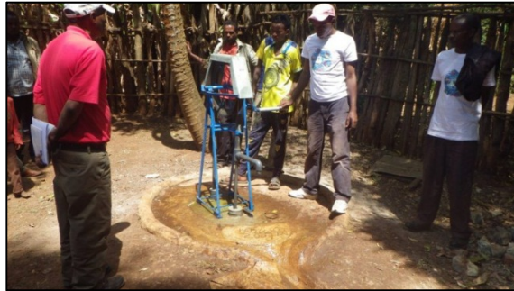
設置されたロープポンプ 撮影日：2015年2月10日 ダレ郡
