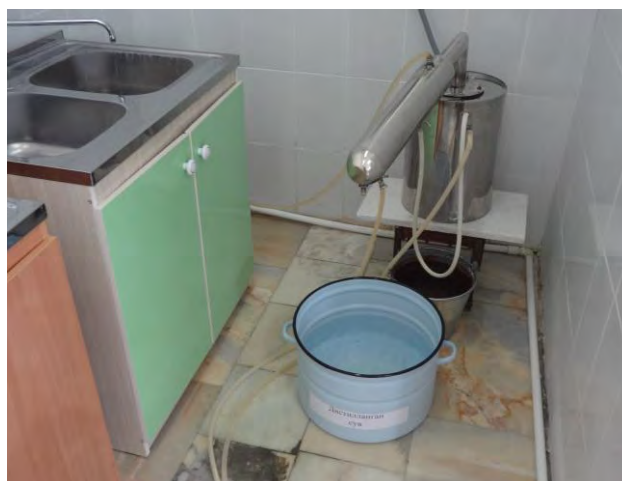
中央材料室に設置されている 2012 年度製の中国製の蒸留水製造装置
