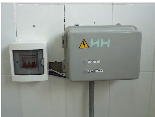
3 相電源の手元開閉器
