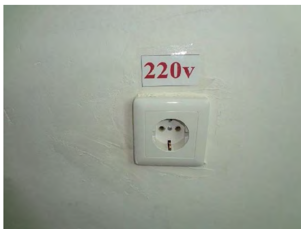
接続を間違えないようにするシールのついた単相 電源のコンセント
