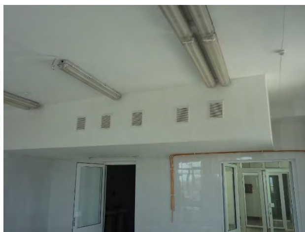
手術室の空調設備
