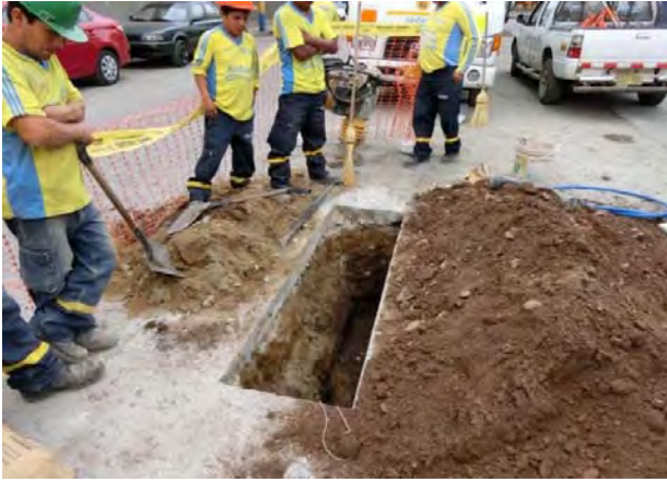
アテビタルテ・サービスセンター セクター4 盗水調査
