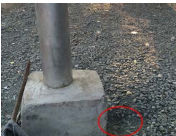
図 33 交通量センサー電力線切断 1
