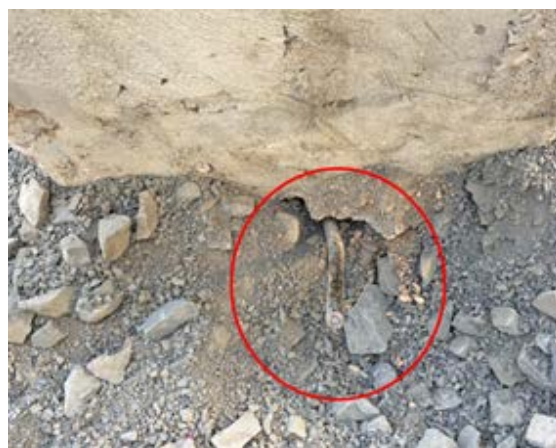
図 34 交通量センサー電力線切断 2
