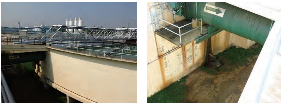
図 84 浄水場内の漏水状況
